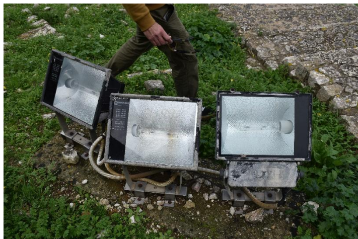
Εικόνα 4.21: Φωτιστικά με λαμπτήρες νατρίου υψηλής πίεσης. Πηγή: Τσαντίλα Ε.
