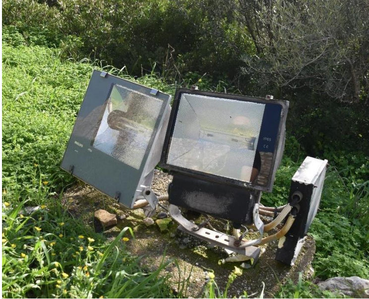
Εικόνα 4.23 : Φωτιστικά σώματα με λαμπτήρες νατρίου. Πηγή: Τσαντίλα Ε.
