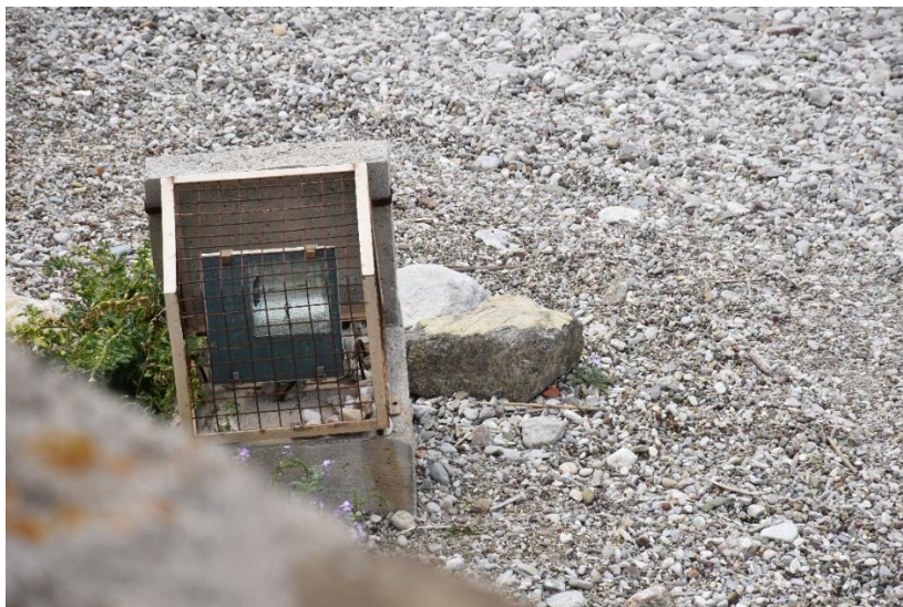
Εικόνα 2.1 Φωτιστικό εντός προστατευτικού κλωβού. Φρούριο Ρίου. Πηγή: Λήψη Τσαντίλα Ε.
