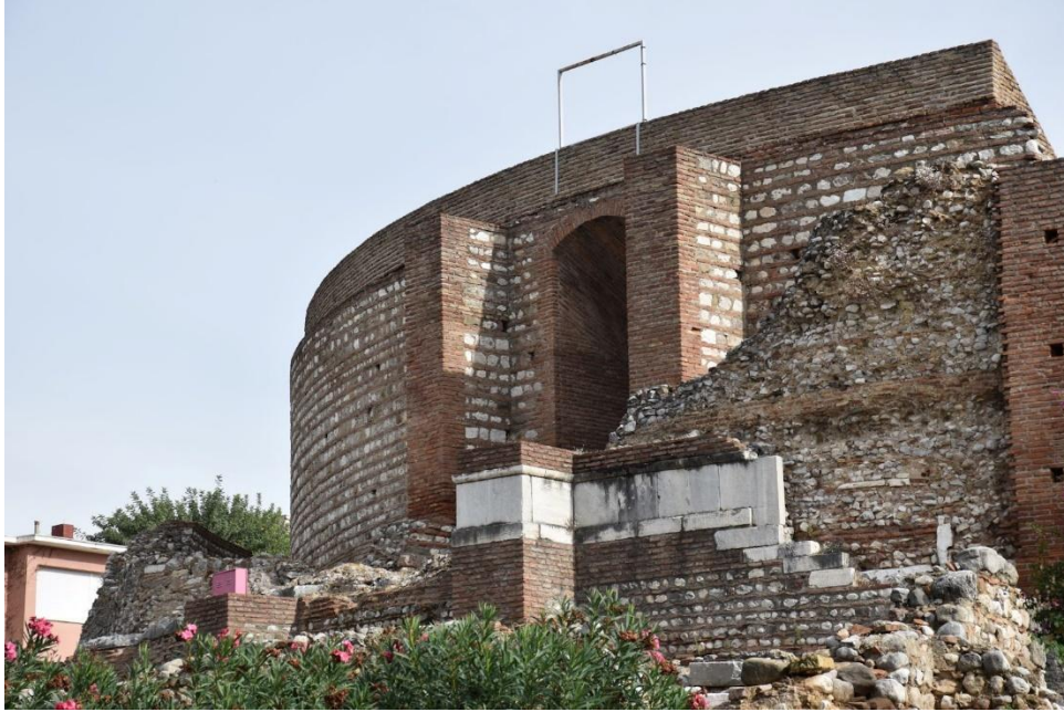
Εικόνα 5.3: Άποψη από την Πλατεία Αγίου Γεωργίου. Οι αντηρίδες βοηθούν στην καλύτερη στήριξη της τοιχοποιίας. Πηγή: Λήψη Τσαντίλα Ε.
