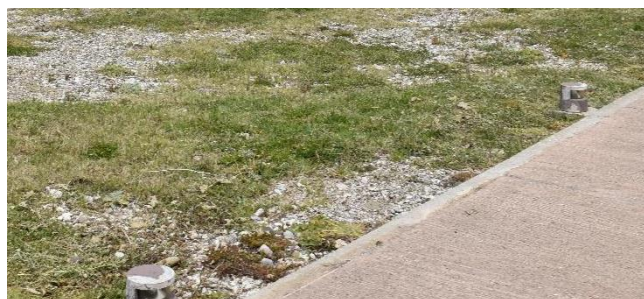
Εικόνα 4.15: Φωτιστικά κυκλοφορίας. Πηγή: Τσαντίλα Ε.
