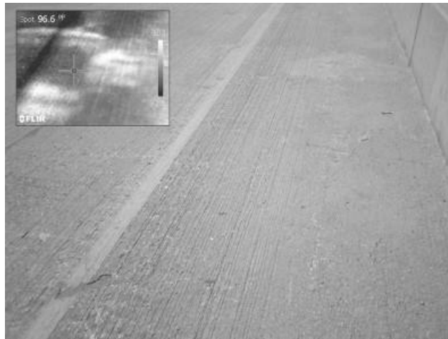
Εικόνα 7-3: Θερμογραφία οδοστρώματος γέφυρας (Courtesy Keith Ramsey) [31]
