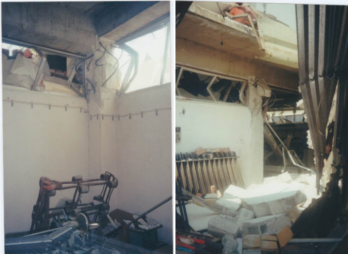
Εικόνα 17:Κοντά Υποστυλώματα -Βιομηχανικό κτήριο στις Αχαρνές-Σεισμός 7.9.1999 [Προσωπικό αρχείο φωτογραφιών]
