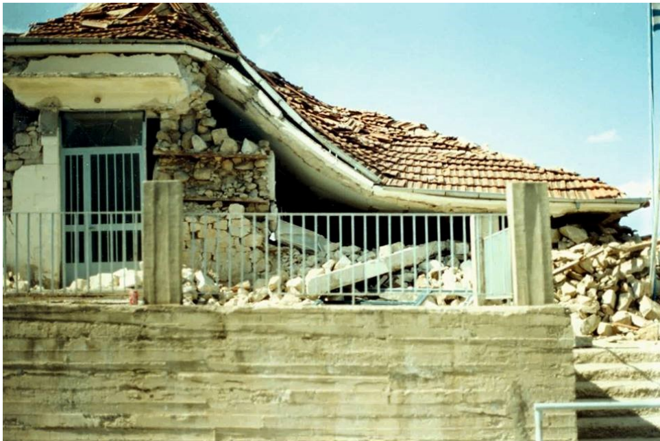
Εικόνα 16: Κατάρρευση λιθόκτιστου κτηρίου- Σεισμός 13.5.1995 Γρεβενά-Κοζάνη (προσωπικό αρχείο)
