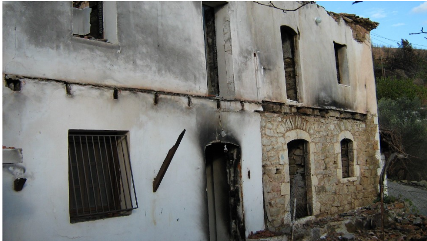
Εικόνα 31. Πυρόπληκτο κτήριο - Πυρκαγιές καλοκαιριού 2007, Π.Ε. Ηλείας [προσωπικό αρχείο φωτογραφιών]
