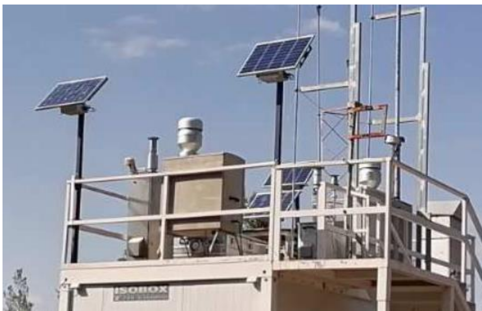
Εικόνα 40: Φωτοβολταϊκά πάνελ δύο συστημάτων AirSensis στον σταθμό DEM
