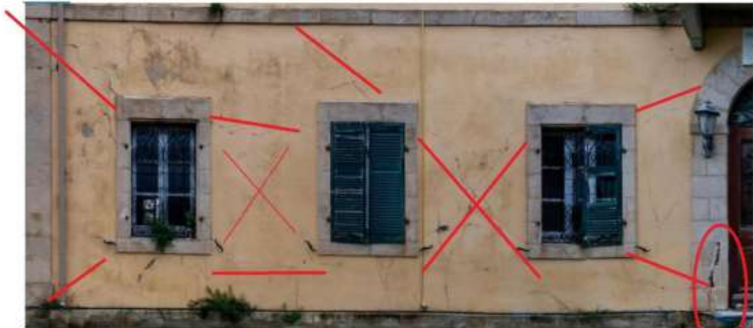
Σχήμα 3.49 Λεπτομέρεια κάτω αριστερά τμήματος του ισογείου, με τις εντοπιζόμενες βλάβες/ρωγμές (VR_Architects, et al., 2022)
