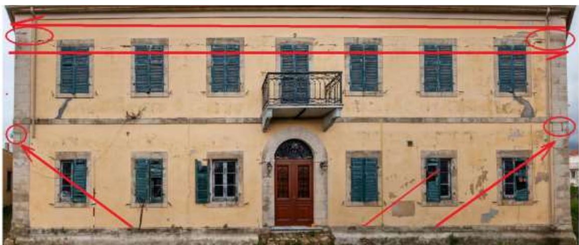
Σχήμα 3.47 Βλάβες ανατολικής όψης (VR_Architects, et al., 2022)
