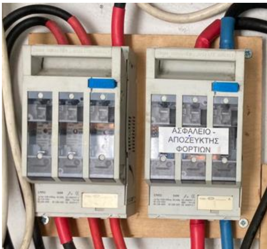
Εικόνα 18: Ασφαλειοαποζεύκτες φορτίων εγκατάστασης
