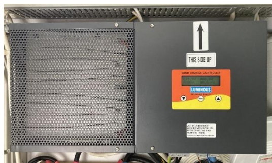
Εικόνα 16: Ρυθμιστής Φόρτισης Α/Γ εγκατάστασης
