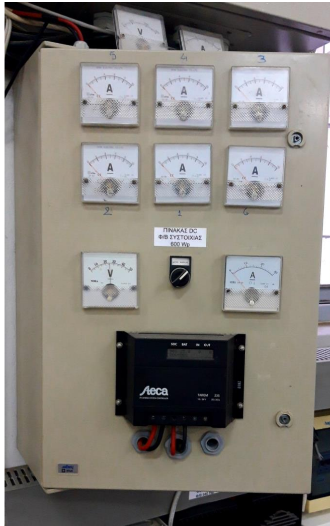
Εικόνα 12: Πίνακας DC πρώτης φωτοβολταϊκής συστοιχίας
