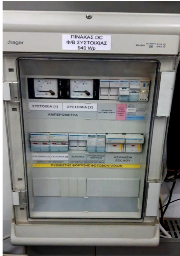
Εικόνα 14: Πίνακας DC δεύτερης φωτοβολταϊκής συστοιχίας
