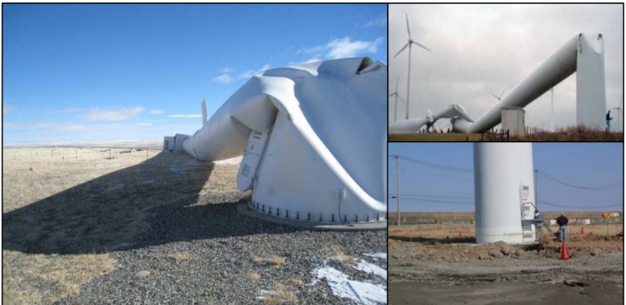
Εικόνα 3.4 : Φωτογραφίες από κατάρρευση ανεμογεννητριών σε αιολικό πάρκο στην Ιαπωνία και στη Νέα Ζηλανδία. (Πηγή: Mohammad-Amin Asareh - Dynamic behavior of operational wind turbines considering aerodynamic and seismic load interaction)
