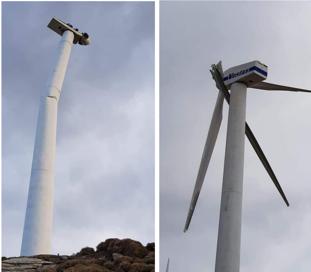
Εικόνα 3.1 : Ανεμογεννήτριες υπό κατάρρευση από το εγκαταλειμμένο αιολικό πάρκο στην Εύβοια. (Πηγή: Structural Engineer https://www.thestructuralengineer.info/news/wind-turbines-destroyed-in-evia-greece )
