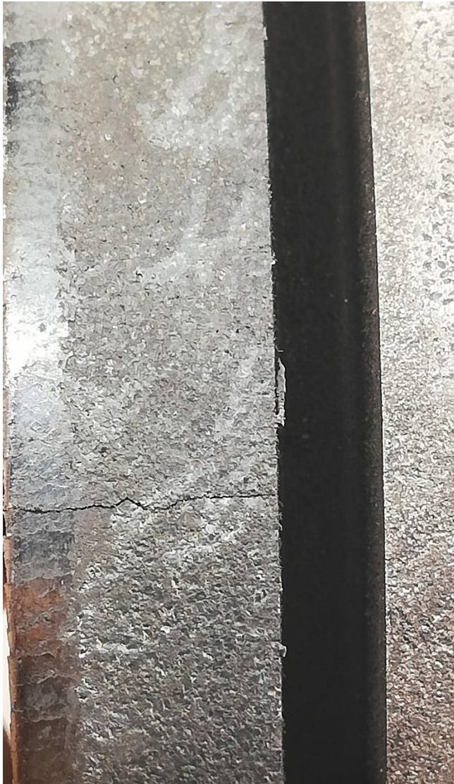
Εικόνα 69 Ρηγματώσεις επιφάνειας λόγω θερμικής κόπωσης θράυσης
