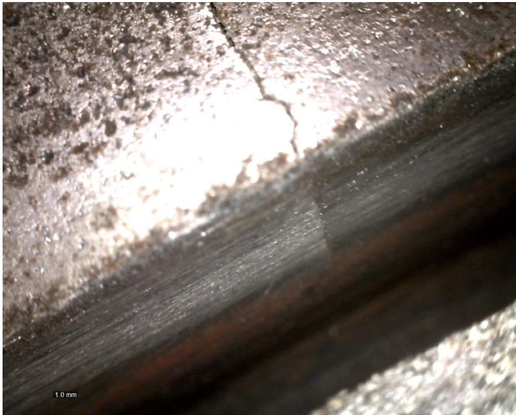
Εικόνα 83 Ρηγμάτωση στο κέντρο εσωτερικά
