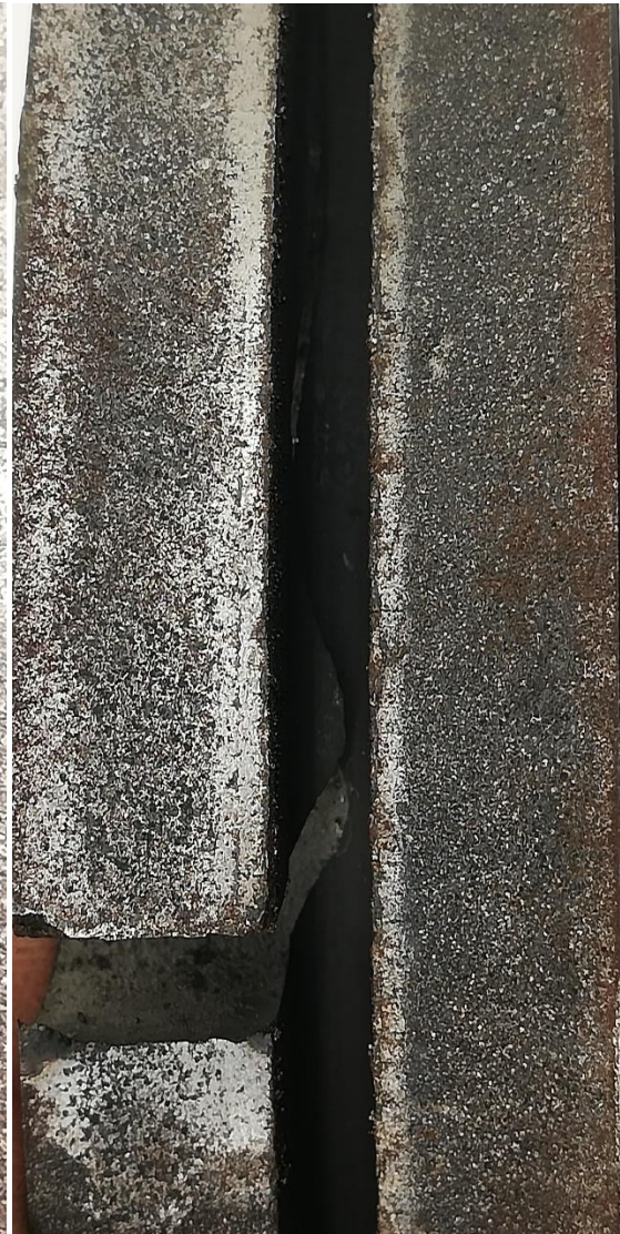
Εικόνα 70 Διάδοση ρηγματώσης και επιφάνεια θράυσης
