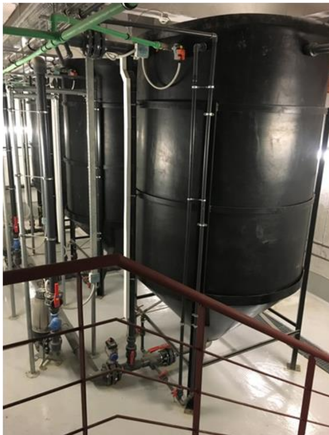
Εικ.93: Δεξαμενές αποβλήτων θαλάμου θεραπείας I 131
