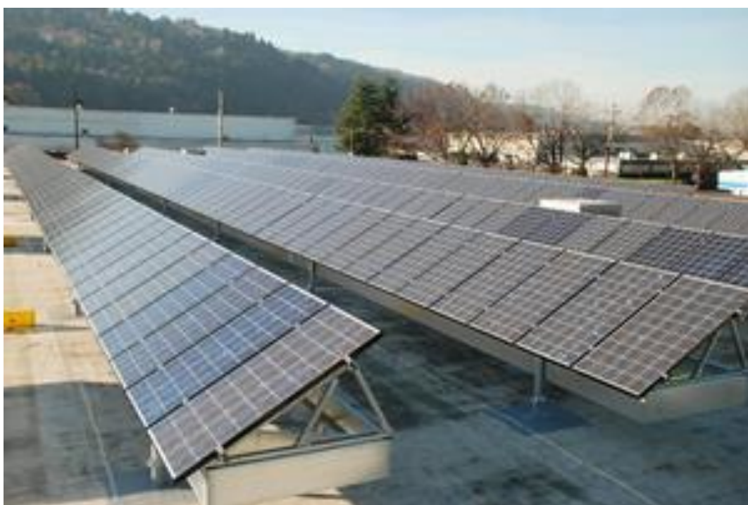
Εικόνα 2. 12: Φ/Β πλαίσια στη στέγη κτιρίου ( https://selasenergy.gr/odigos_mikron_sustimaton.php )
