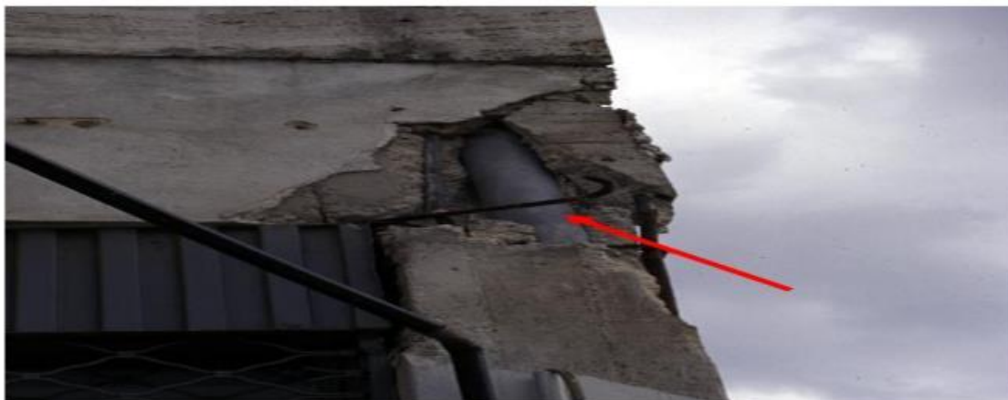
Εικόνα 3. 8: Αστοχία κόμβου και απώλεια περίσφιξης συνδετήρων λόγω τοποθέτησης υδρορροής εντός του υποστυλώματος (Γιαννόπουλος, 2005)
