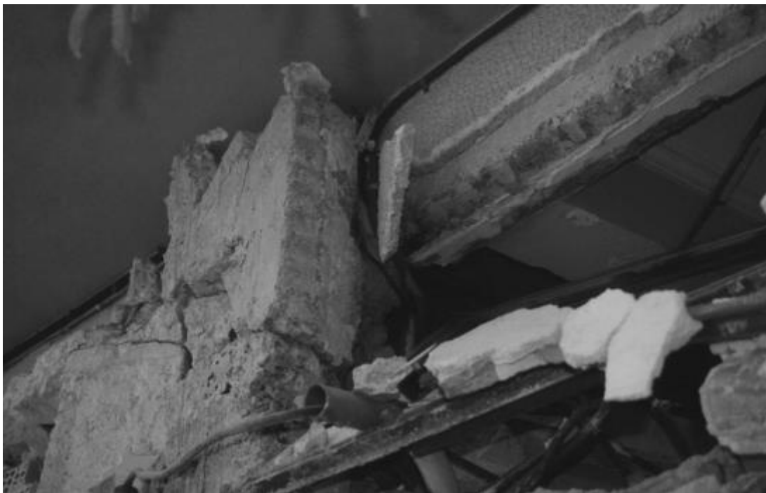
Εικόνα 3. 6: Αστοχία κόμβου μεταξύ υποστυλώματος και συντρέχουσες δοκούς (Γαρυφαλής, 2000)
