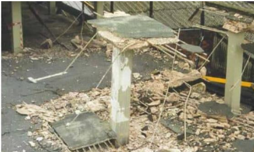
Εικόνα 3. 12: Αστοχία λόγω διάτρησης στο Piper's Row Car Park, Wolverhampton, UK (Δημοσθένους, 2009)
