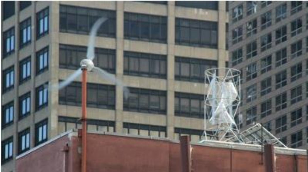
Εικόνα 2. 16: Ανεμογεννήτριες οριζόντιου άξονα σε στέγη κτιρίου (EWEA, 2021)
