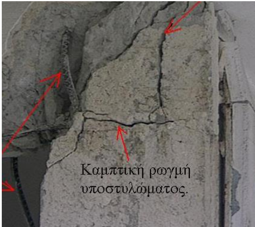
Εικόνα 3. 3: Καμπτική αστοχία υποστυλώματος ( http://ecourses.dbnet.ntua.gr/9421.html )
