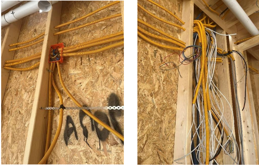
Εικόνα 107,108: Ηλεκτρολογικές Εγκαταστάσεις Εσωτερικά της Τοιχοποιίας
