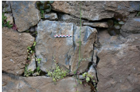
Εικ. 2.8: Ρηγματώσεις στην επιφάνεια λίθου, Φωτογραφία: Θ. Κατρακάζης
