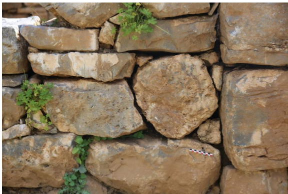
Εικ. 2.5: Απώλεια συνδετικού υλικού από την λιθοδομή και ανάπτυξη φυτών στα κενά των αρμών, Φωτογραφία: Θ. Κατρακάζης
