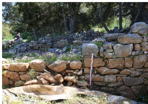
Εικ. 2.6: Αποδιοργάνωση λιθοδομής, Φωτογραφία: Θ. Κατρακάζης
