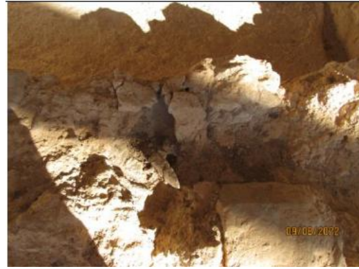
Εικ.36 Φθορά από ζώο στη βόρεια λιθοδομή του Χώρου 50 για τρίτη φορά.
