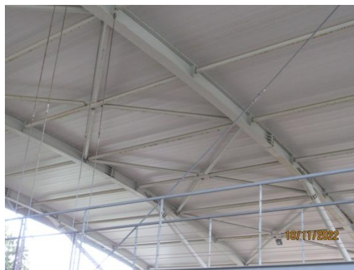
Εικ.32 Φαινόμενα σκουριάς έχουν αρχίσει να εμφανίζονται στο κατασκευαστικό μέταλλο του στεγάστρου.
