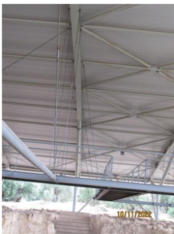
Εικ.31 Φαινόμενα σκουριάς έχουν αρχίσει να εμφανίζονται στο κατασκευαστικό υλικό του στεγάστρου.
