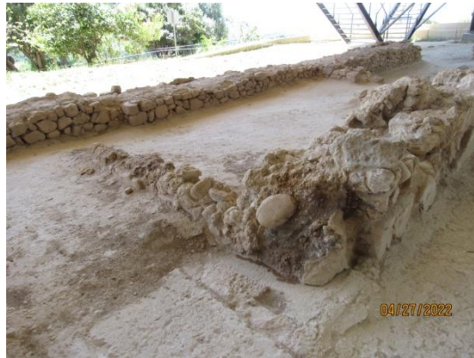
Εικ.45 Η γωνία της λιθοδομής της εικόνας 44 μετά την απομάκρυνση των προβληματικών επεμβάσεων στο πλαίσιο των πρώτων σωστικών μέτρων.
