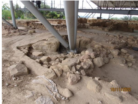
Εικ.18 Υποστήλωμα του στεγάστρου όπου έχει αποσπαστεί υλικό από το Χώρο 102.
