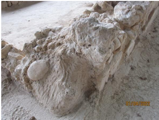
Εικ.44 Η βόρεια γωνία της βόρειας λιθοδομής του Χώρου 53 μετά τις προβληματικές επεμβάσεις.
