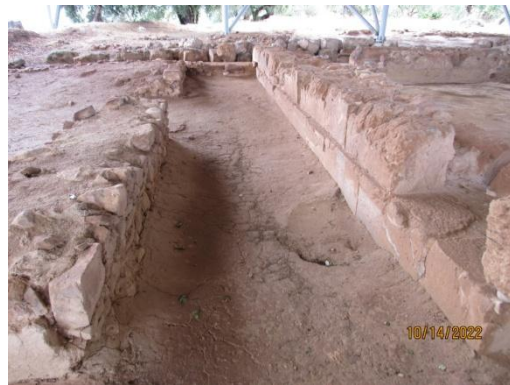
Εικ.26 Ύστερα από την κακοκαιρία της 14 ης Οκτωβρίου του 2022 όπου έγινε διαποτισμός με νερό της βροχής στο Χώρο 26.
