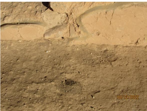
Εικ.39 Φθορά από έντομα στο δάπεδο και στη λιθοδομή του Χώρου 50.
