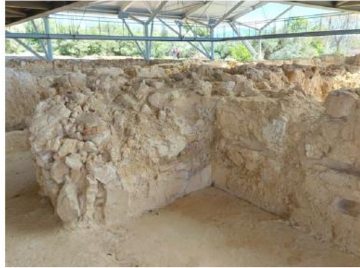
Εικ.43 Η λιθοδομή της εικόνας 42 μετά τις εργασίες πρώτων σωστικών μέτρων. (Οι εργασίες έγιναν από την τεχνικό Συντήρησης Δούση Βαλεντίνη)
