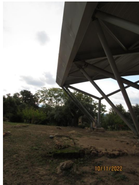
Εικ.30 Ρωγμή σε κατασκευαστική ένωση στην ανατολική πλευρά του στεγάστρου όπου λιμνάζει νερά κι έχει δημιουργήσει λακκούβα στο θαμμένο Χώρο 96.
