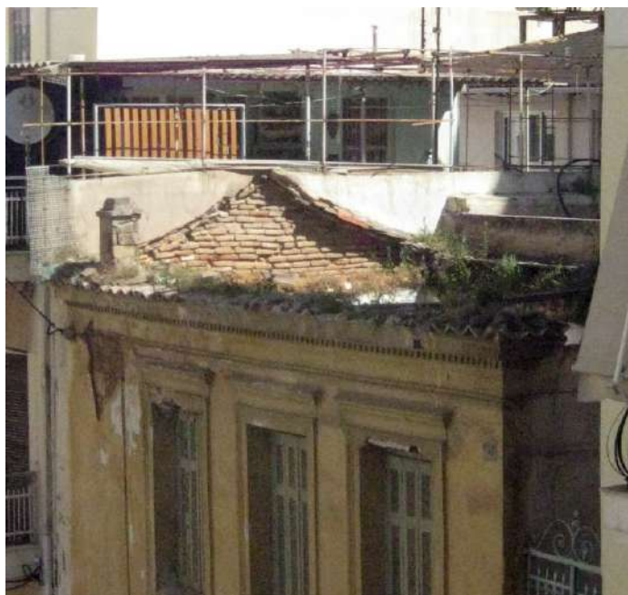
Η σημερινή εικόνα της στέγης που έχει καταρρεύσει
