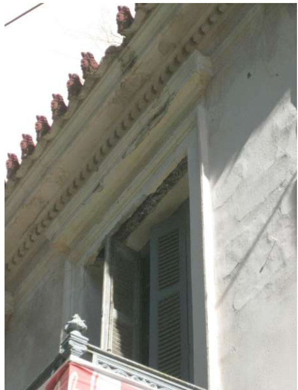
Λεπτομέρεια από τη στέγη. Διακρίνεται λόγω απόλειας επιχρισμάτων το πρέκι από μεταλλική ράβδο σχήματος διπλού T
