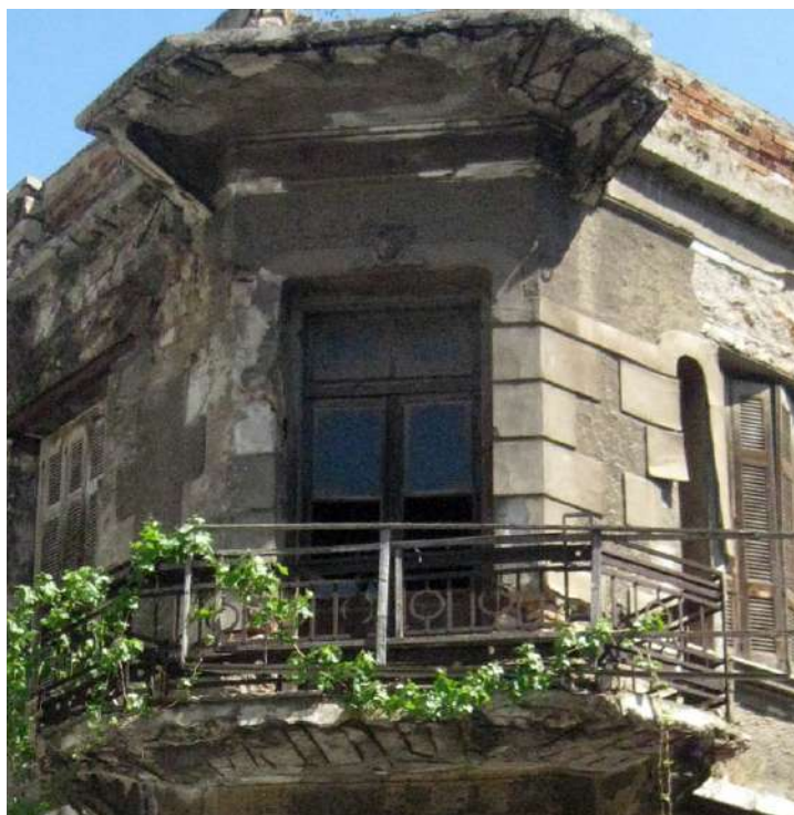
Ο εξώστης στη γωνία. Διακρίνεται το μπετόν αρμέ του εξώστη και του προστεγάσματος καθώς και το ανάγλυφο πρόσωπο στο κλειδί του ανοίγματος
