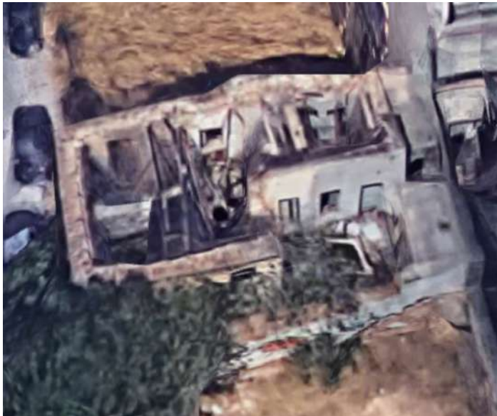
Αεροφωτογραφίες, η στέγη έχει καταρρεύσει (πηγή: google earth-2009)
