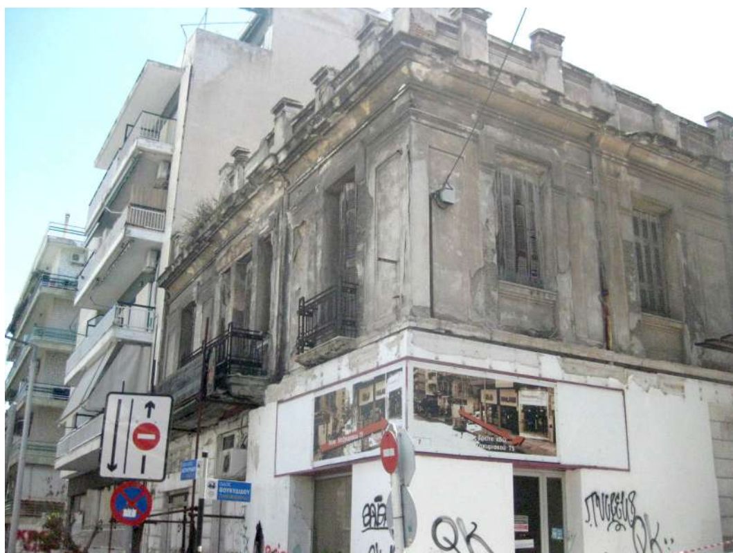
Οι αλλοιώσεις στα ανοίγματα του ισόγειου καταστήματος.
