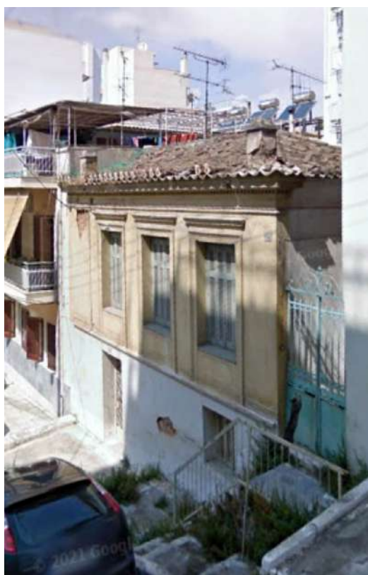
Παλαιότερη φωτογραφία πριν την κατάρρευση της στέγης. Διακρίνονται δύο καμινάδες. (πηγή: google street view-2009)
