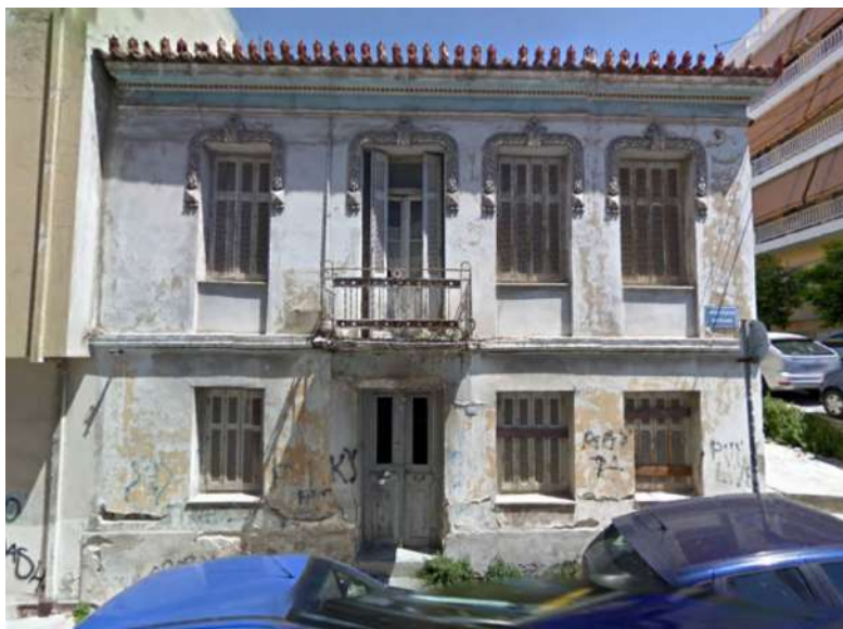
Παλαιότερη φωτογραφία, διακρίνεται η ξύλινη θύρα εισόδου για το ισόγειο. (πηγή: google street view-2009)
