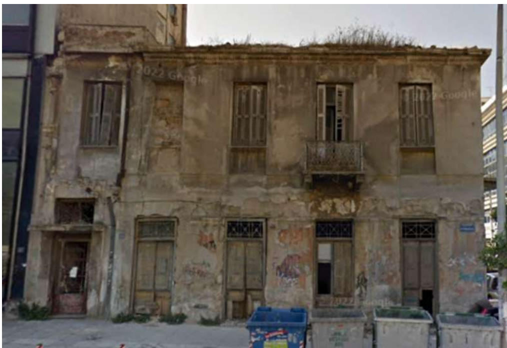
Η όψη επί της οδού Χατζηκυριάκου 21. Η θύρα αριστερά και το άνω άνοιγμα φαίνονται να έχουν προστεθεί μεταγενέστερα (πηγή: google street view-2009)
