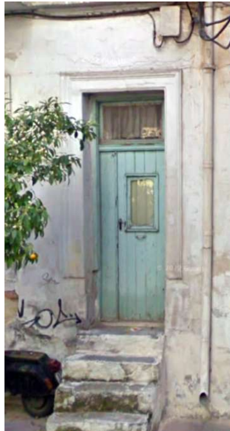
Η θύρα για το ισόγειο. Διακρίνεται η πλαισίωση που «κόβεται». (πηγή: google street view-2009)
