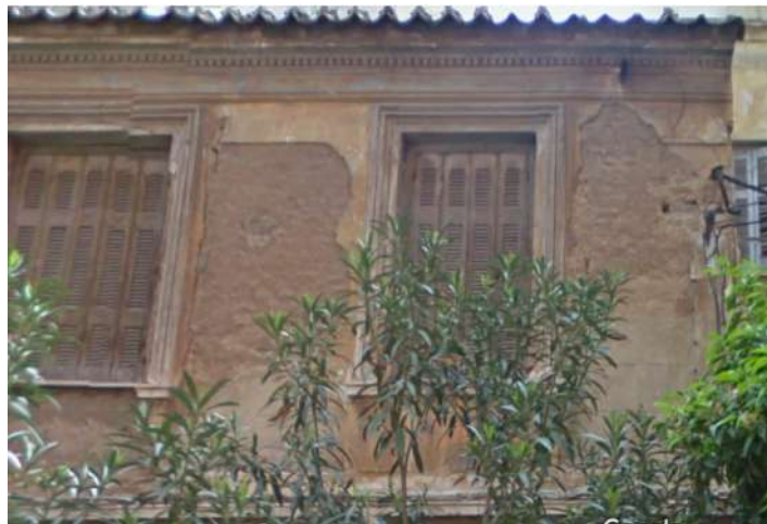
Στη γωνία διακρίνεται η γραμμική επισήμανση του ισόδομου συστήματος που κάλυπτε τον όροφο (πηγή: google street view-2009)
