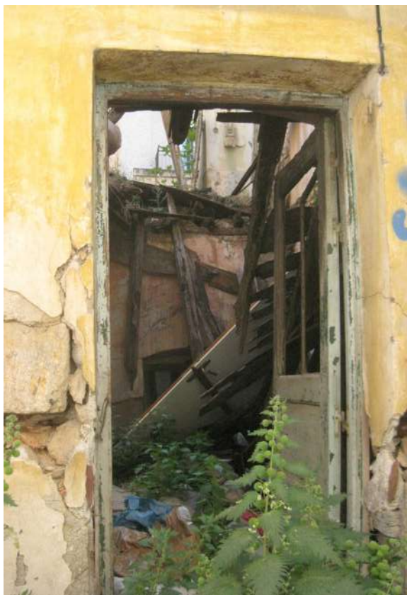
Η θύρα εισόδου για το ισόγειο. Διακρίνεται το ξύλινο πάτωμα του ορόφου που έχει καταστραφεί.
