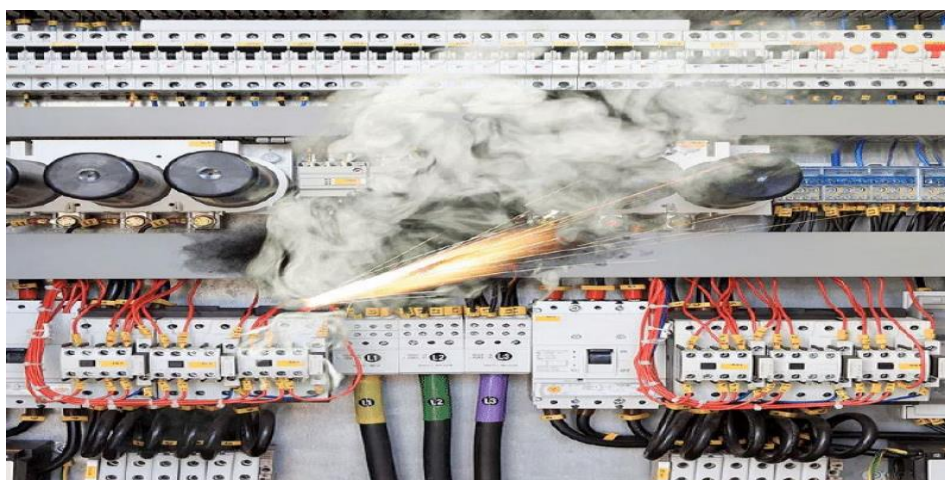
Εικόνα 2.9: Εμφάνιση ηλεκτρικής πυρκαγιάς σε ηλεκτρικό κύκλωμα με αλλοιωμένη μόνωση. [38]
