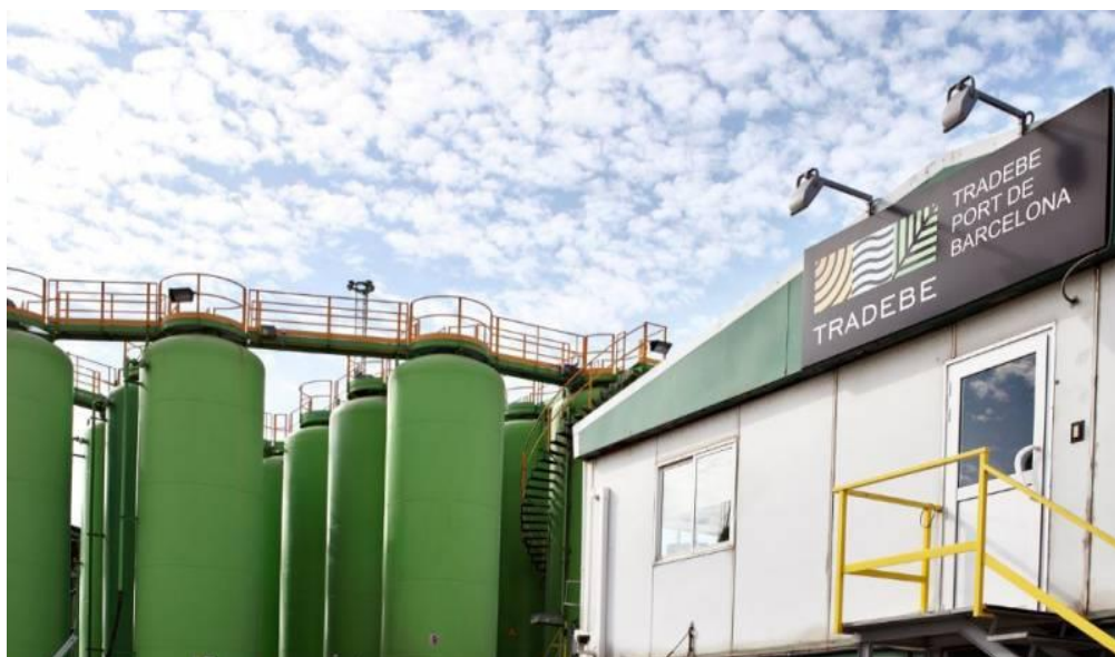
Εικόνα 11: Εργοστάσιο επεξεργασίας βιομηχανικών ναυτιλιακών αποβλήτων της Tradebe στο λιμάνι της Βαρκελώνης (TRADEBE, 2020)
