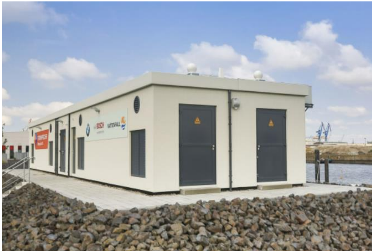
Εικόνα 6.3: Σύστημα αποθήκευσης ηλεκτρικής ενέργειας στο Αμβούργο(Πηγή: Vattenfall, BMW and Bosch test second-life EV battery electricity storage in Hamburg for grid stabilization - Green Car Congress )
