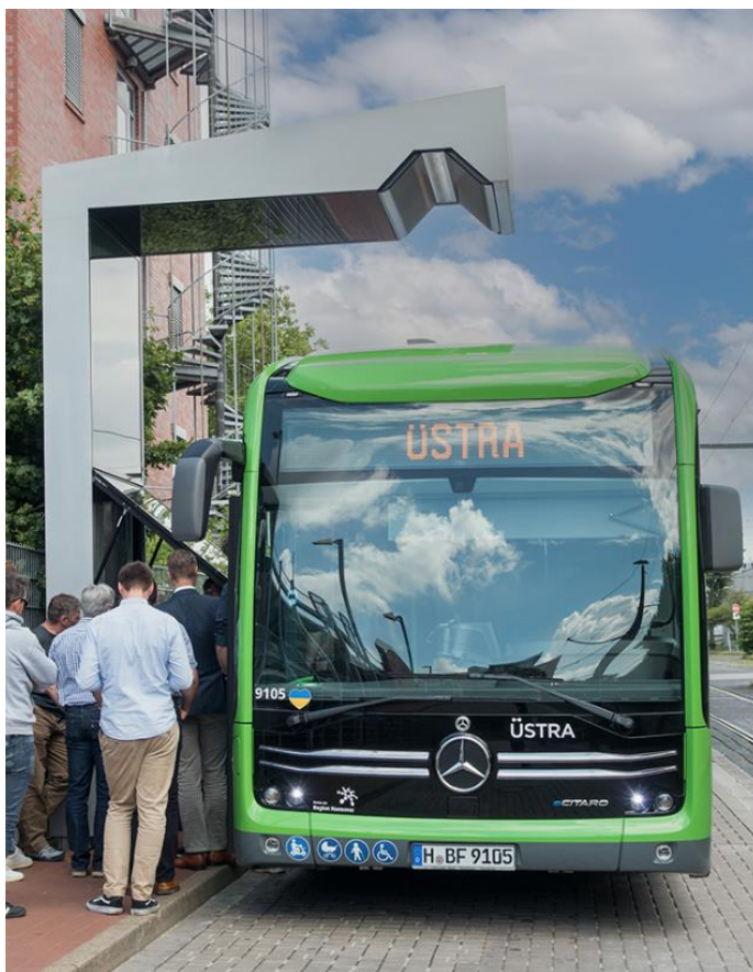
Εικόνα 6.7 : Φορτιστής ηλεκτρικών λεωφορείων (Πηγή: Aktuelles - G UW+ (guwplus.de) )
