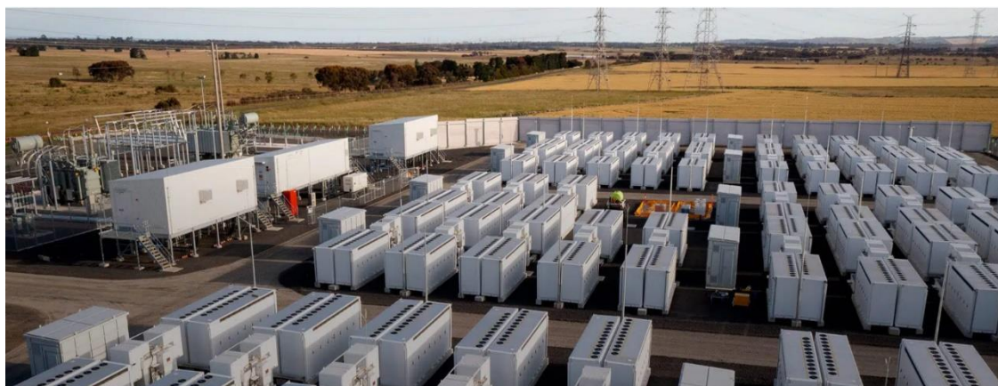
Εικόνα 5.25: Σύστημα μπαταριών Neoen, Βικτώρια (Πηγή: Neoen starts operating 300 MW Victorian Big Battery in Australia, one of the world’s largest batteries - Neoen )
