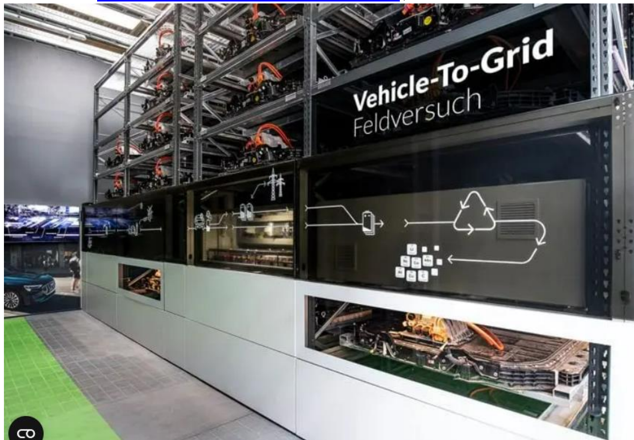
Εικόνα 6.9 : Μονάδα αποθήκευσης στο EUREF CAMPUS (Πηγή: Multi-use storage optimises energy supply (mobilityhouse.com))
