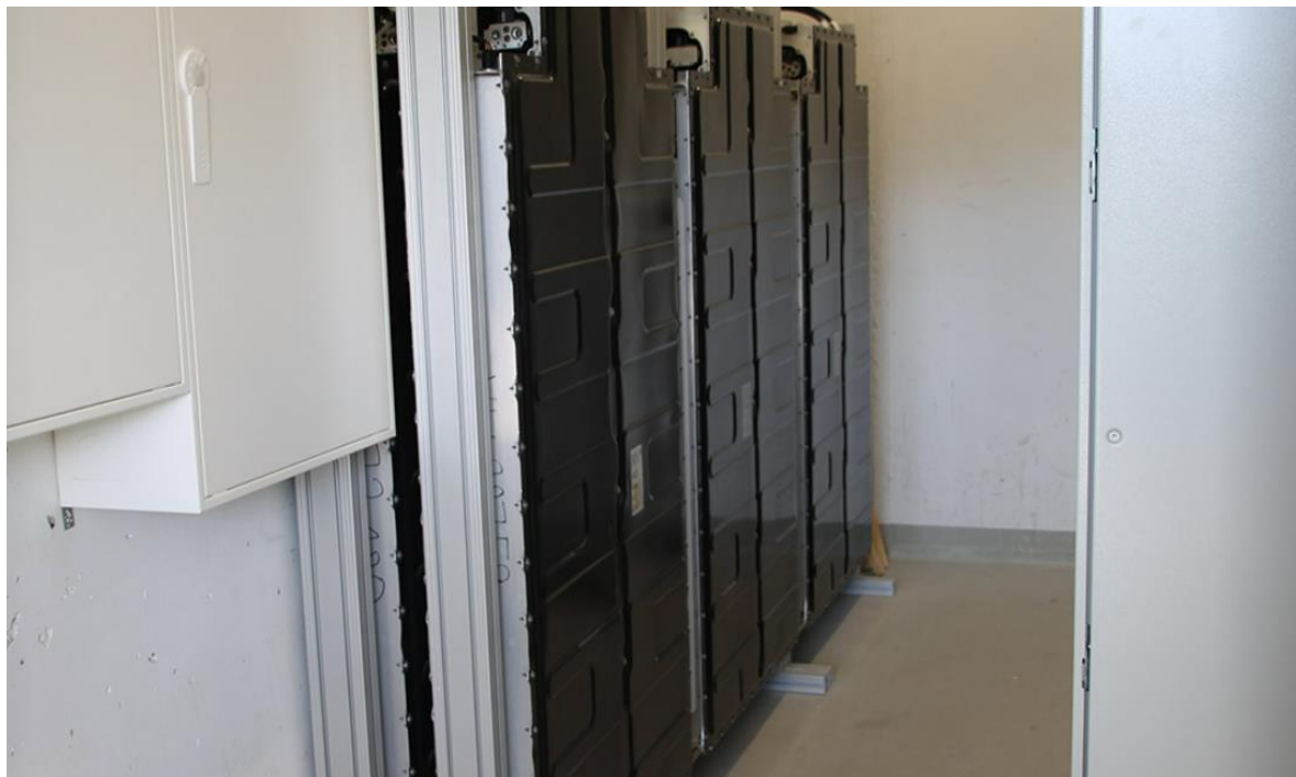
Εικόνα 6.20 : Εγκατάσταση των έξι μπαταριών BMW i3 2ης ζωής ως αποθηκευτικό χώρο αποθήκευσης στο κλιματιζόμενο δωμάτιο μπαταριών, στο Weinsberg ( Πηγή: Emilas)
