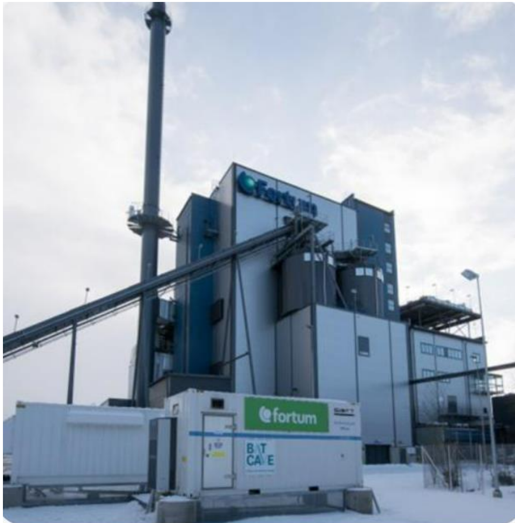
Εικόνα 5.21: Σύστημα αποθήκευσης, Fortum Φιλανδία (Πηγή:Saft Li-ion energy storage will maintain the balance of power for Finland’s transition to a solar economy | Saft | Batteries to energize the world)
