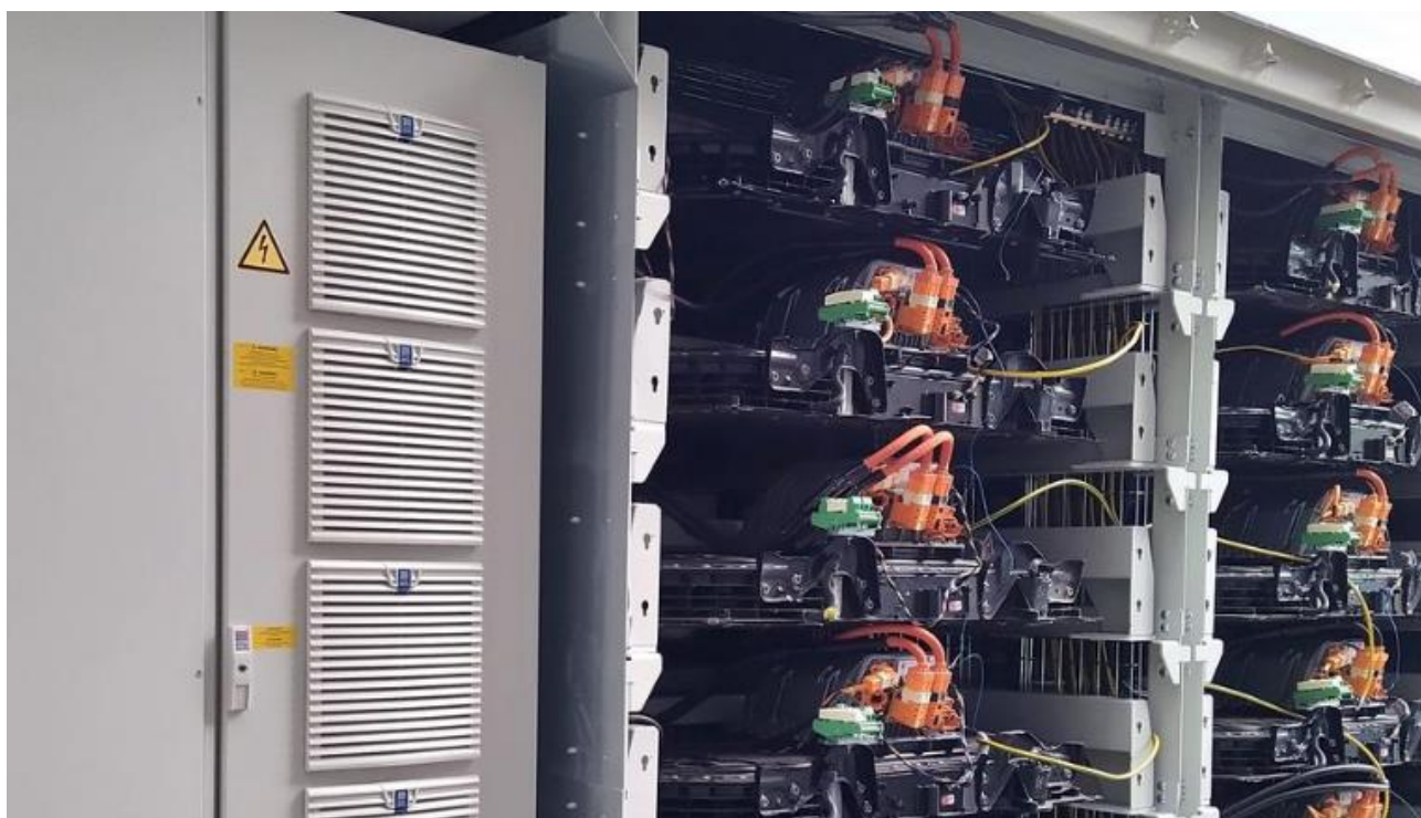
Εικόνα 6.23: Σύστημα αποθήκευσης ( Πηγή: Second-Life-Batterien als Stromspeicher | EnBW)
