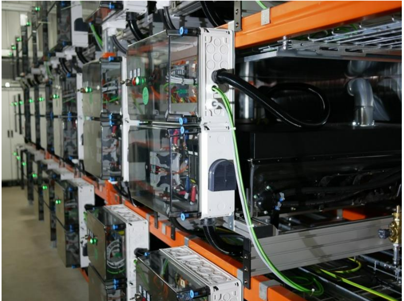
Εικόνα 6.12 : Σταθμός αποθήκευσης ενέργειας στο Lunen (Πηγή: Energy Storage: 13 MWh second-use battery for grid stabilization in Lünen (pveurope.eu))
