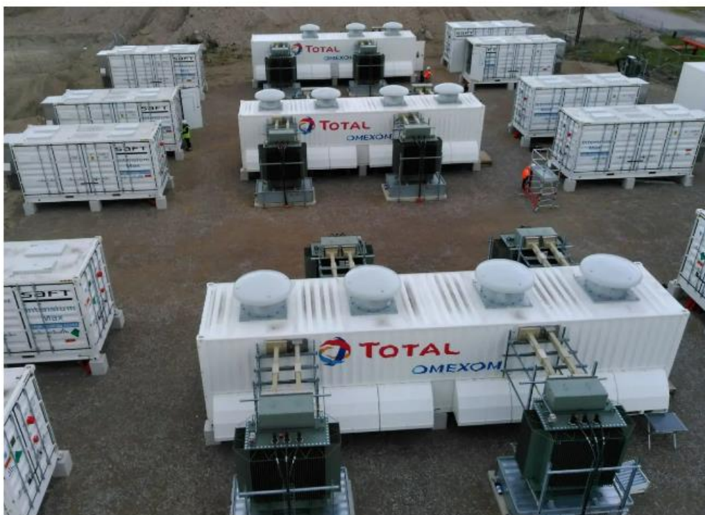
Εικόνα 5.15: Σύστημα αποθήκευσης Total , Γαλλία (Πηγή: The most powerful battery energy storage system in France - Omexom )
