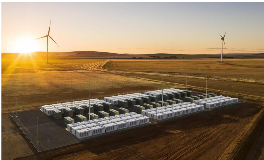
Εικόνα 5.24: Σύστημα αποθήκευσης στο Hornsdale της Αυστραλίας (Πηγή: Hornsdale battery has 'significant impact' on market | Windpower Monthly)
