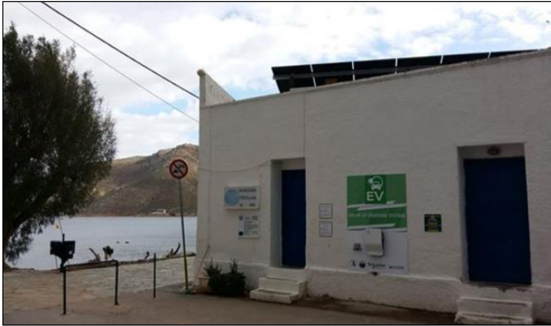
Εικόνα 2.3 : Απεικόνιση του ηλιακού σταθμού φόρτισης ηλεκτρικών οχημάτων στο νησί της Τήλου ('Ο πρώτος ηλιακός σταθμός φόρτισης ηλεκτροκίνητων σε ελληνικά νησιά στην Τήλο (φωτο)', n.d.)
