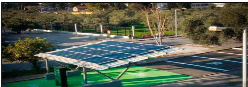
Εικόνα 1.2.3 : Ηλιακός σταθμός φόρτισης ηλεκτρικών οχημάτων στο Πανεπιστήμιο Δυτικής Αττικής (Kostopoulos et al., 2018)
