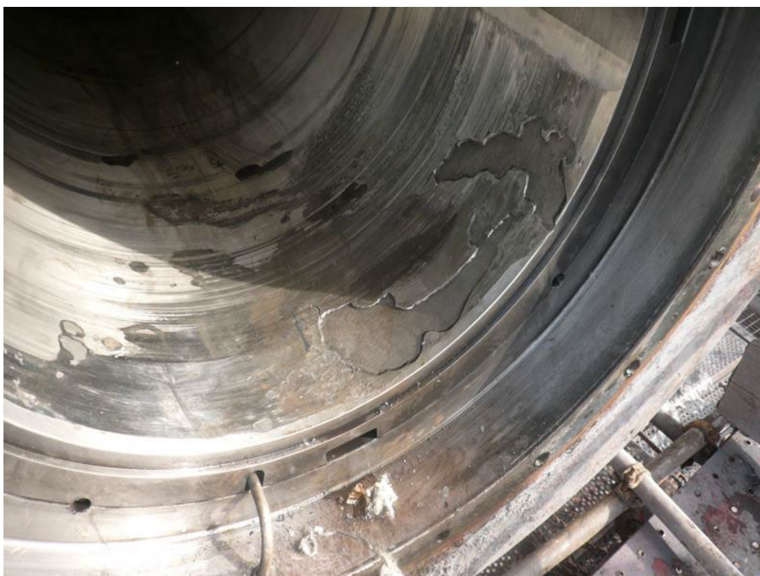
Εικόνα 12 Ζημιά στον πυρμααίο σωλήνα λόγω κακής ευθυγράμμισης του άξονα.
