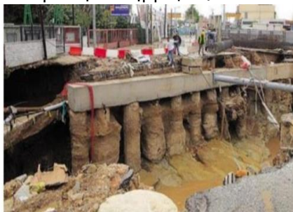
Υποχώρηση οδοστρώματος σε σκεπασμένο ρέμα στο Καματερό
