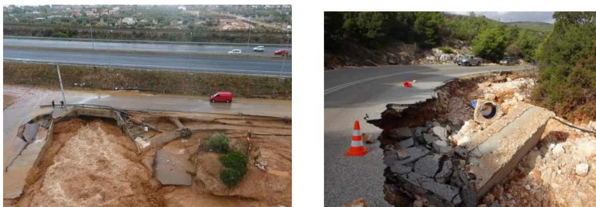
Σχήμα 25 : Καταστροφές σε οδικό τμήμα της εθνικής οδού [Μαλακοδήμος, 2020].
