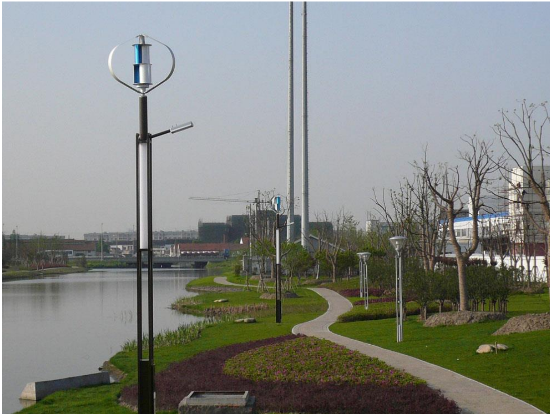
Εικόνα 4.10 : Υβριδικό σύστημα οδικού φωτισμού
