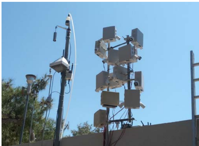
Σχήμα 6.1: Εγκατάσταση σταθμών παρακολούθησης ποιότητας αέρα χαμηλού κόστους στο Εθνικό Αστεροσκοπείο Αθηνών.
