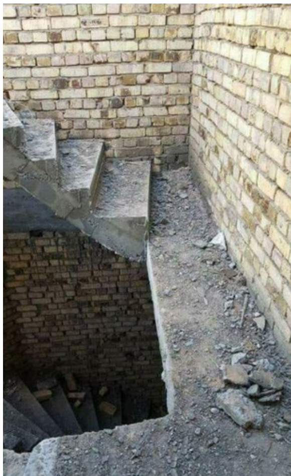
Εικόνα 32:Κακός σχεδιασμός και κατασκευή εσωτερικού κλιμακοστασίου
