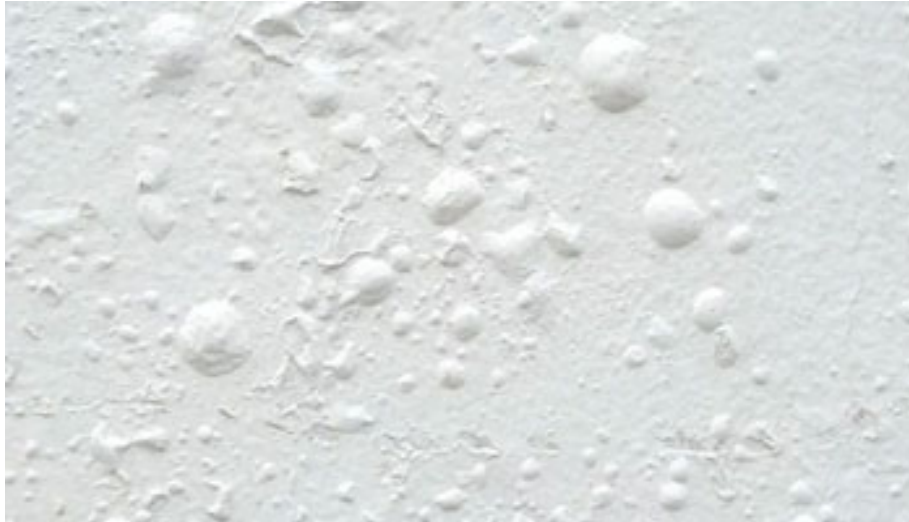
Εικόνα 44:Φουσκάλες. Αυτό το ελάττωμα οφείλεται στην όψιμη σβέση των σωματιδίων του ασβέστη στον σοβά. Εμφανίζεται ως οιδήματα με τη μορφή μικρών μπαλωμάτων της σοβατισμένης επιφάνειας.
