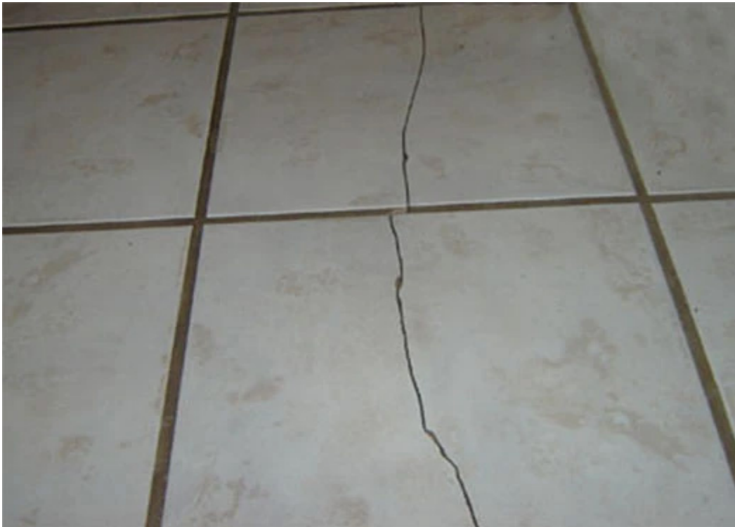
Εικόνα 65:Ρηγμάτωση πλακιδίων από λανθασμένη τοποθέτηση
