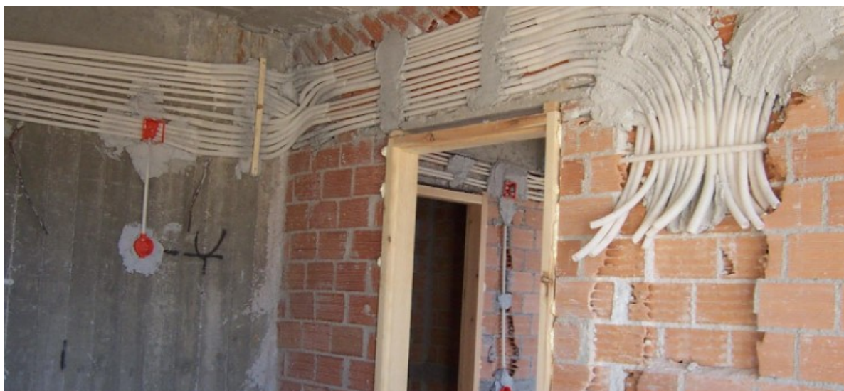
Εικόνα 59:Κανάλια καλωδίων της ηλεκτρικής εγκατάστασης
