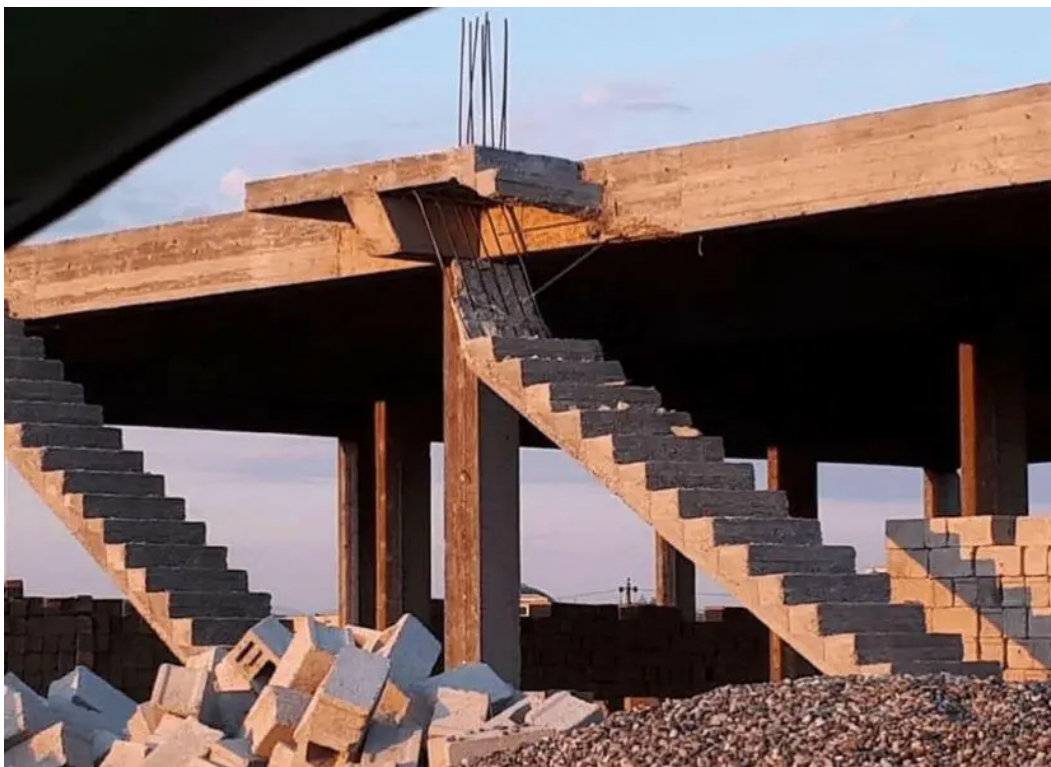
Εικόνα 31: Παράδειγμα αστοχίας κλιμακοστασίου: Ανεπαρκής ποσότητα οπλισμού.
