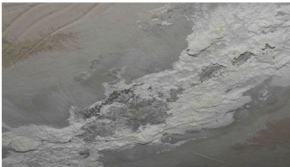
Εικόνα 43: Η άνθηση είναι μια υπόλευκη κρυσταλλική ουσία στην επιφάνεια ενός τοίχου. Αυτή η εμφάνιση οφείλεται στα άκαυτα άλατα που υπάρχουν στον ασβέστη, το τσιμέντο, το τούβλο, την άμμο και τα άλατα στο νερό. Όταν το τοίχωμα στεγνώνει, τα διαλυτά άλατα απορροφούν την υγρασία από την ατμόσφαιρα μέσω των πόρων και εναποτίθενται σε μπαλώματα με τη μορφή λευκών κρυσταλλικών μπαλωμάτων. Αυτά τα μπαλώματα εξαφανίζονται σε υγρά κλίματα και επανεμφανίζονται σε ξηρά κλίματα. Μπορεί να αντιμετωπιστεί σε κάποιο βαθμό με επαναλαμβανόμενο στεγνό βούρτσισμα και πλύσιμο.
