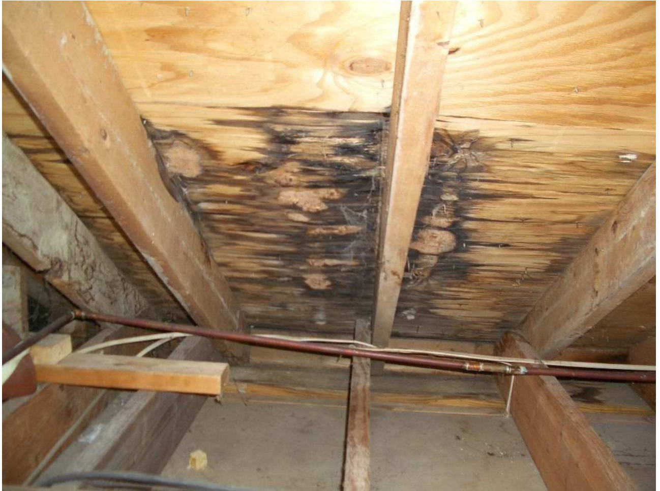
Εικόνα 55:Σχηματισμός μούχλας στο φέροντα σκελετό λόγω κακής αδιαβροχοποίησης
