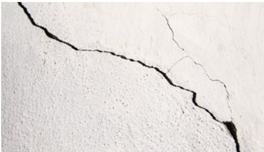
Εικόνα 42: Μπορεί να υπάρχουν διάφοροι λόγοι που οδηγούν σε ρωγμές στη σοβατισμένη επιφάνεια και είναι δύσκολο να εντοπιστούν οι τριχοειδείς ρωγμές μέχρι να μεγαλώσουν
