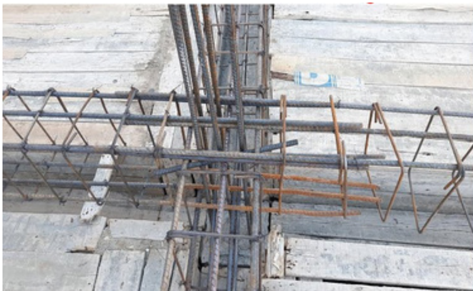
Εικόνα 23:Λάθος σύνδεση ραβδών σπλισμού
