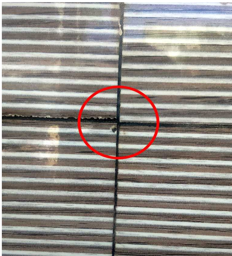
Εικόνα 66:Μη συμμετρική και ορθή τοποθέτηση πλακιδίων
