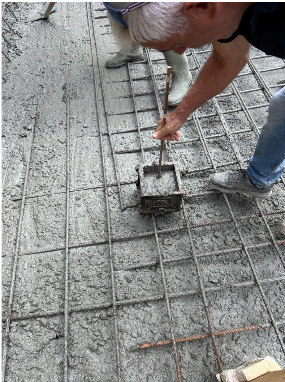
Εικόνα 13:Εργασίες Λανθασμένος τρόπος λήψης δοκιμίων σκυροδέματος
