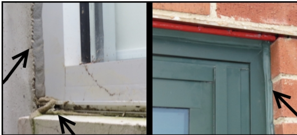
Εικόνα 71:Κακή τοποθέτηση μόνωσης σε ανοίγματα
