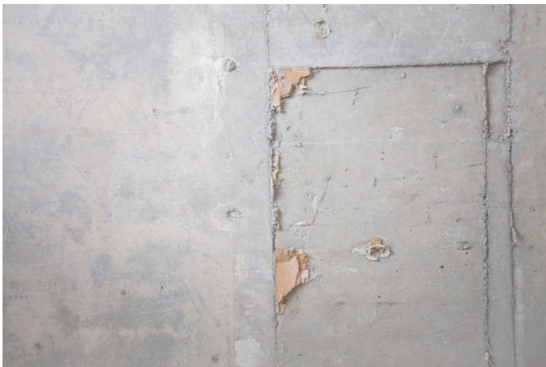
Εικόνα 26: Τυπική απόδειξη στην μη σωστή ευθυγράμμιση του ξυλότυπου. Κατά την αφαίρεση μένου ιχνη του στο σκυρόδεμα.
