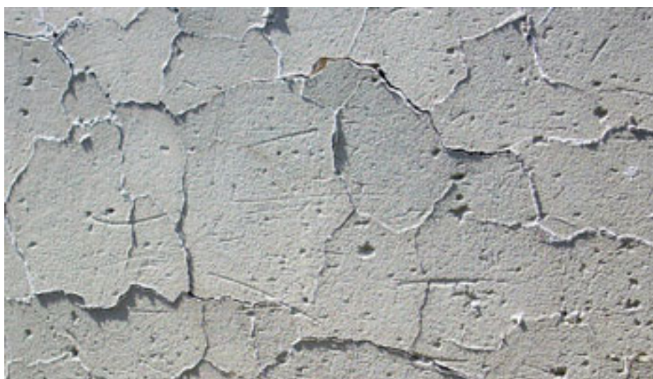
Εικόνα 41:Η αποκόλληση συμβαίνει όταν ο σοβάς διαχωρίζεται από τον τοίχο. Μπορεί να προκληθεί από υπερβολικά παχύ στρώμα σοβά, ανεπαρκή προετοιμασία του υποστρώματος ή μπορεί να οφείλεται σε σκονισμένο, λιπαρό ή ξηρό υπόστρωμα.
