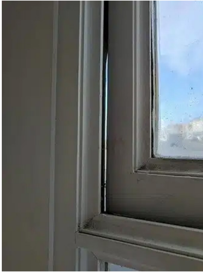
Εικόνα 74: Μη ορθή λειτουργία ανοίγματος λόγω μη ορθής τοποθέτησης
