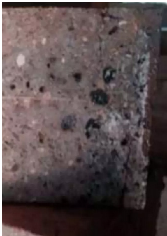
Εικόνα 35:«Φούσκωμα» σε τούβλο. Παράδειγμα υλικού κακής ποιότητας που προέρχεται από περίσσεια ύλης άνθρακα στο βασικό υλικό κατασκευής του
