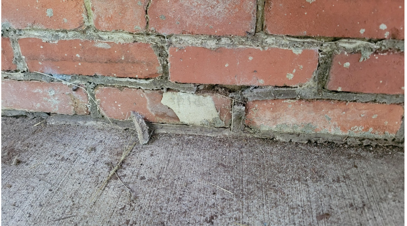
Εικόνα 37:Κακή τοποθέτηση συνδετικού υλικού στην τοιχοποιία
