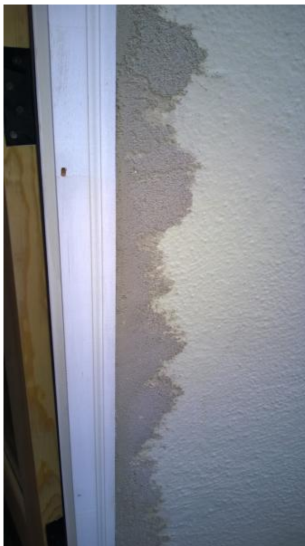
Εικόνα 76: Αποτέλεσμα κακής αδιαβροχοποίησης στην τοποθέτηση εξωτερικής θύρας
