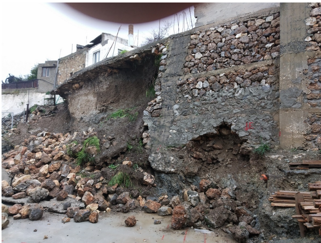
Εικόνα 3: Ζημιά σε τοίχο κτιρίου ως αποτέλεσμα μη λήψης μέτρων κατά τις εργασίες εκσκαφής θεμελίωσης σε όμορο οικόπεδο
