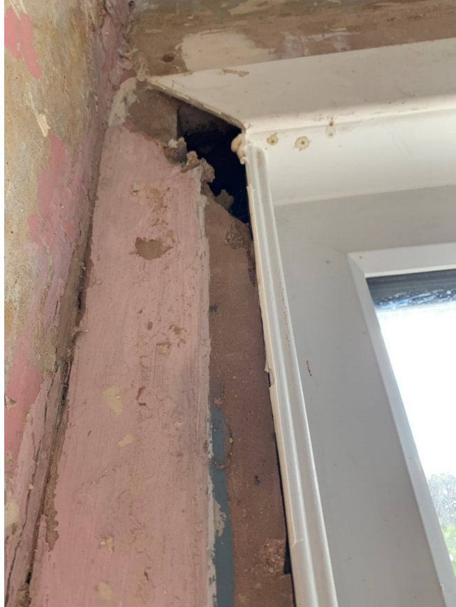
Εικόνα 68: Προβληματική τοποθέτηση κουφώματος σε μεγαλύτερο αρχικό άνοιγμα
