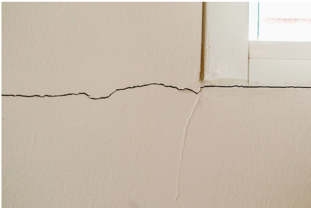
Εικόνα 73: Ρηγμάτωση τοιχοποιίας λόγω μη ορθής τοποθέτησης κουφώματος
