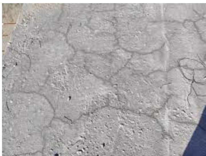
Εικόνα 17:Ρηγμάτωση σε πλάκα σκυροδέματος μετά την σκλήρυνση
