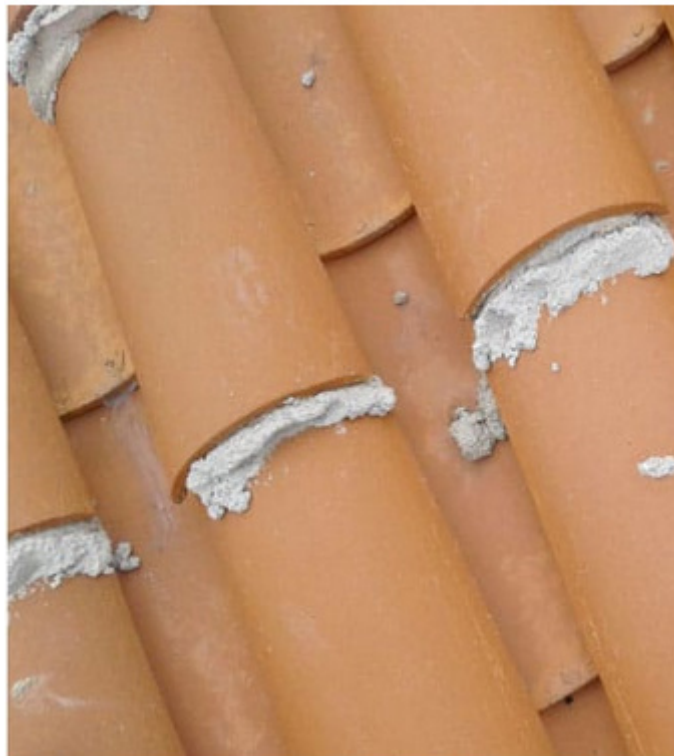
Εικόνα 53:Μη ορθή τοποθέτηση κεραμιδιών
