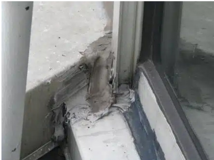
Εικόνα 75: Κακή τοποθέτηση μόνωσης σε άνοιγμα
