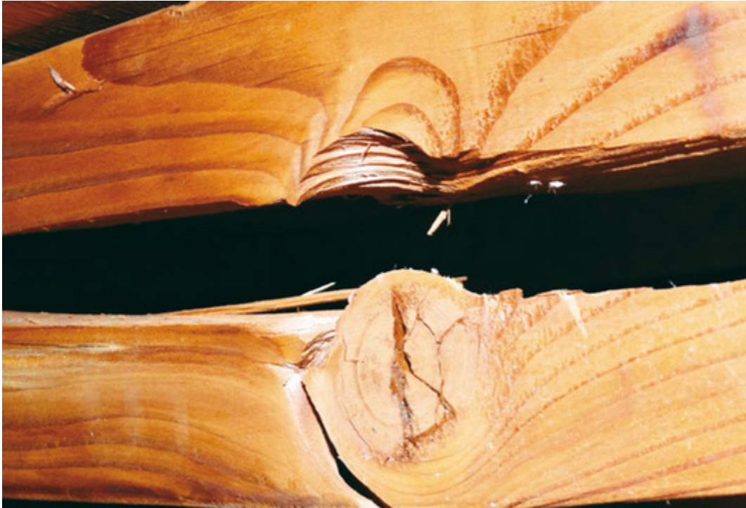
Εικόνα 47: Αστοχία δοκαριού του φέροντος οργανισμού
