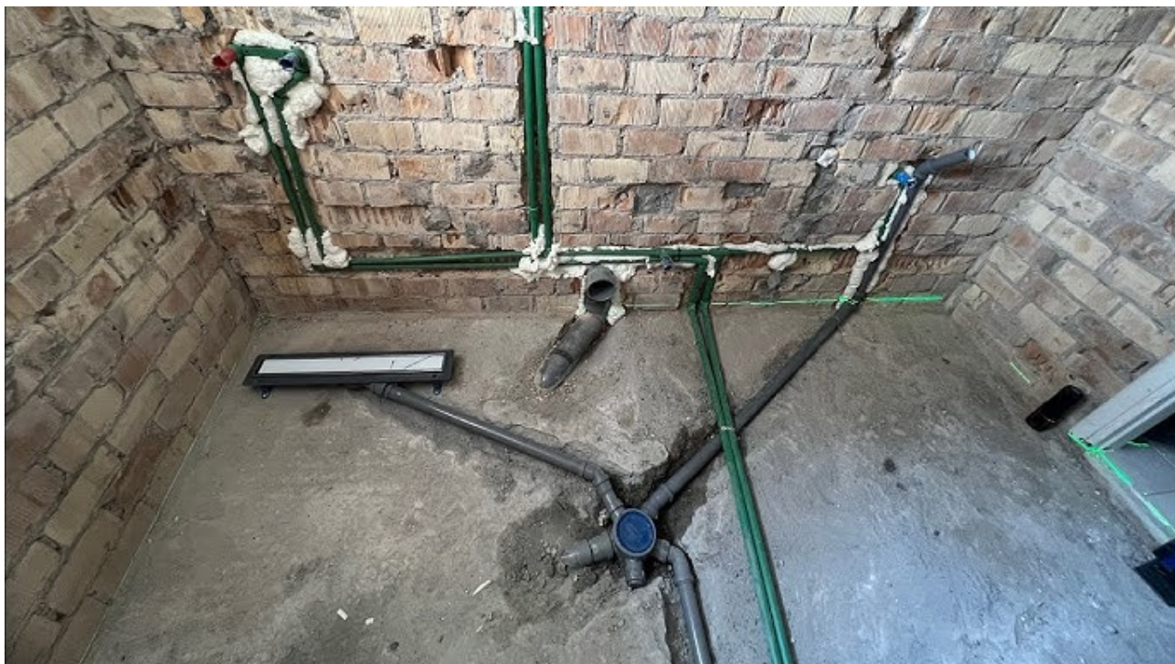
Εικόνα 58:Ορθή τοποθέτηση σωληνώσεων ύδρευσης και αποχέτευσης
