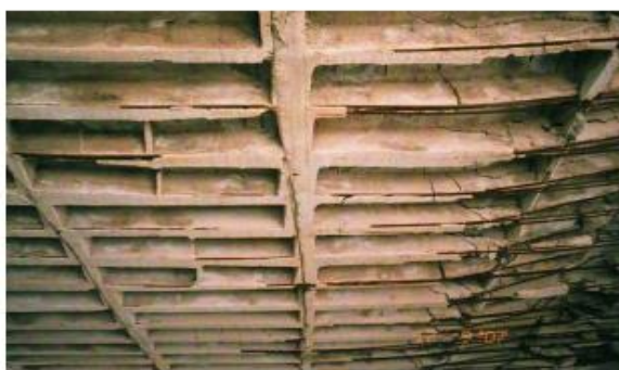
Καμμένη, μεγάλη δοκιδωτή πλάκα αποθήκης, πολύ βαριές βλάβες, βέλη (έως 250 mm) και ρωγμές (έως 25 mm), έντονες εκτινάξεις σκυροδέματος, έντονος λυγισμός ράβδων οπλισμού, φαιή/κιτρινωπή απόχρωση σε μεγάλη έκταση.
