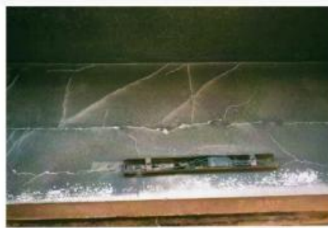
Διαμπερης ρωγή πλάκας/προβόλου στην πρόσοψη κτιρίου.
