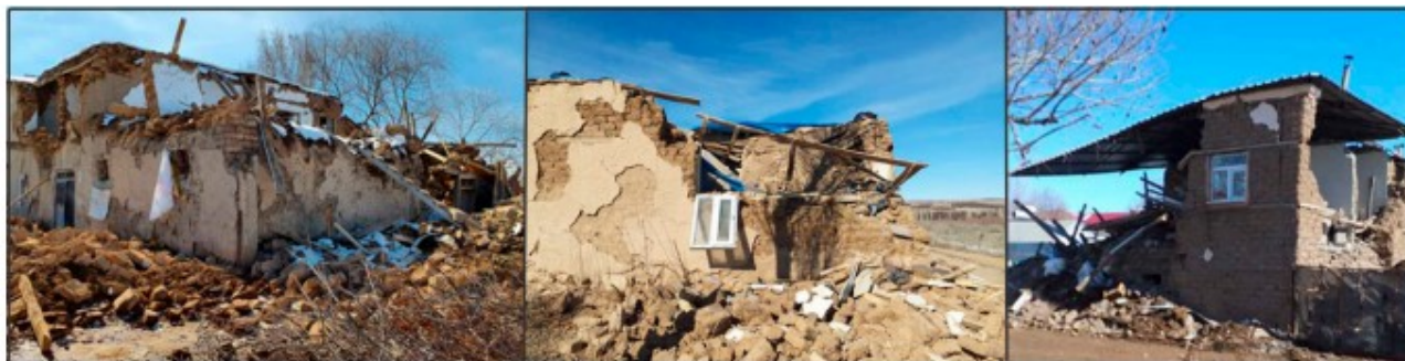
Εικόνα 2.12 Μερική κατάρρευση κτιρίων από φέρουσα τοιχοποιία (Işık, E. et al,2023)
