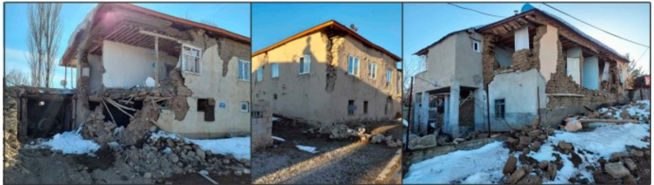
Εικόνα 2.20 Ζημιές λόγω της χαμηλής αντοχής του κονιάματος (Ιζίκ, Ε.,2023)
