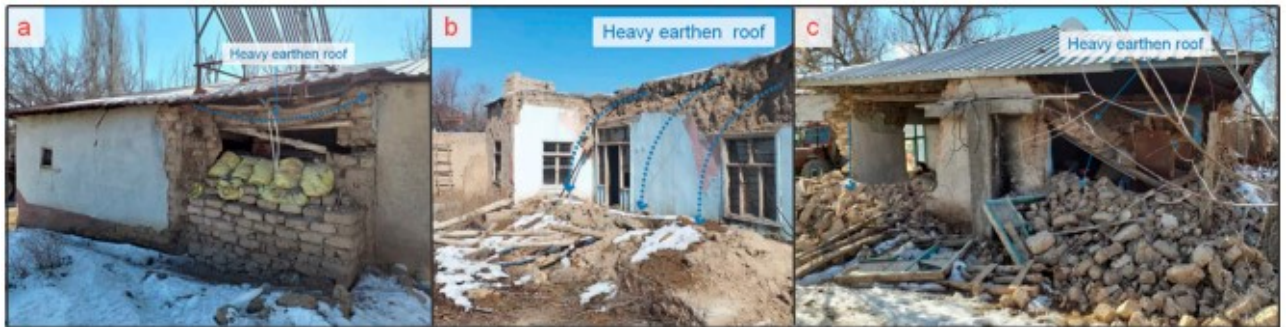
Εικόνα 2.16 Καταρρεύσεις κτιρίων φέρουσας τοιχοποιίας με βαριά φυτεμένη στέγη, εκτός επιπέδου αστοχίες τοίχων (Işık, E.,2023)
