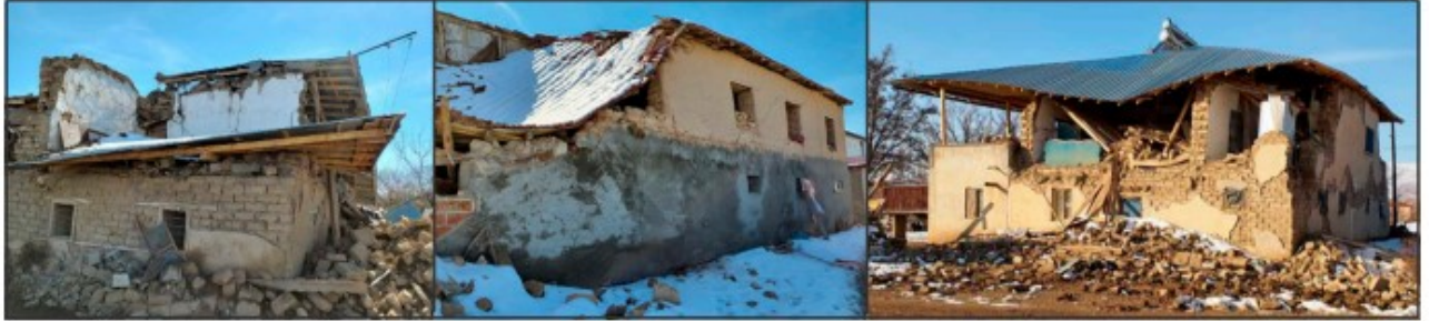
Εικόνα 2.19 Δομικές ζημιές λόγω ασύμμετρης αντοχής/ακαμψίας και κενού μεταξύ των ορόφων (Ιζίκ, Ε.,2023)
