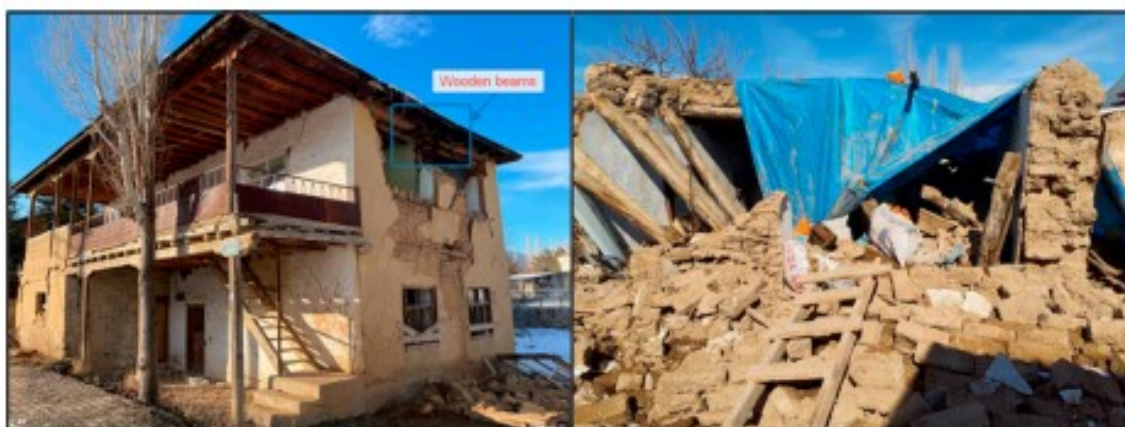
Εικόνα 2.15 Βλάβες σε ξύλινα δοκάρια λόγω του ίδιου βάρους των χωμάτινων στεγών (Ιζικ, Ε.,2023)
