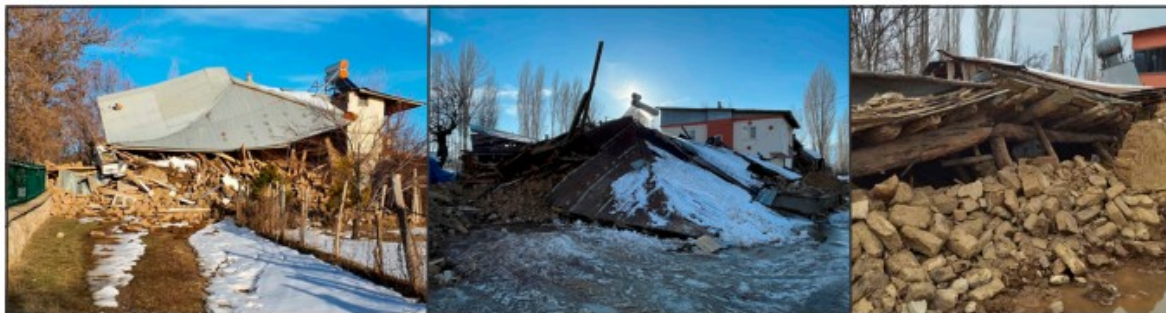
Εικόνα 2.11 Καταρρεύσεις κτιρίων από φέρουσα τοιχοποιία (Işık, E. et al,2023)
