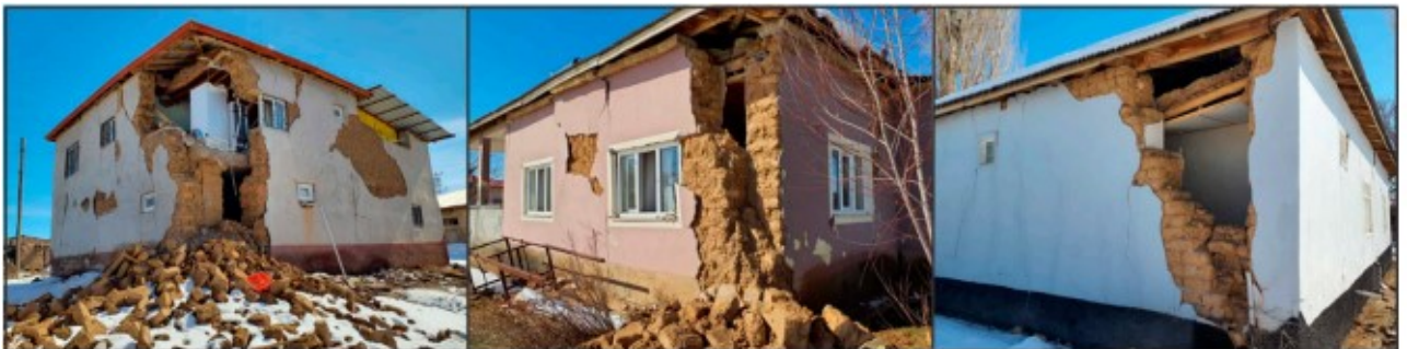
Εικόνα 2.18 Εκτός επιπέδου ζημιές στον τοίχο λόγω ανεπαρκούς στήριξης σε γωνιακά σημεία (Işık, E.,2023)
