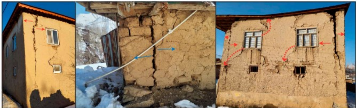
Εικόνα 2.17 Αστοχίες διαχωρισμού στις γωνίες ένωσης τοίχων (Işık, E.,2023)
