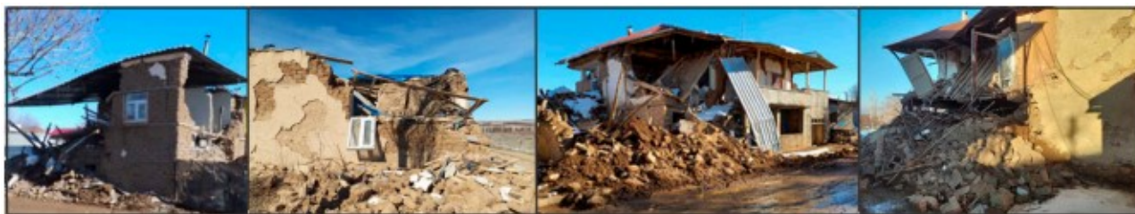
Εικόνα 2.26 Παραδείγματα κτιρίων από φέρουσα τοιχοποιία με καταστροφικές βλάβες πολύ βαριές δομικές βλάβες, Βαθμός 5 (Işik, E., 2023)
