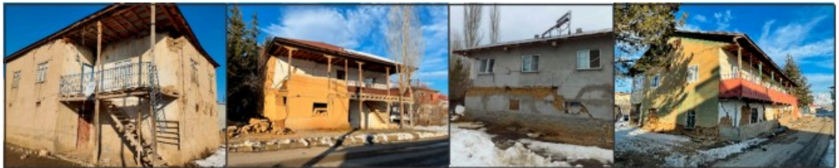
Εικόνα 2.24 Παραδείγματα κτιρίων από φέρουσα τοιχοποιία με σημαντικές έως μεγάλες βλάβες Βαθμός 3 (Ιşik, Ε., 2023)
