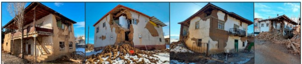
Εικόνα 2.25 Παραδείγματα κτιρίων από φέρουσα τοιχοποιία με πολύ μεγάλες βλάβες Βαθμός 4 (Ιşik, Ε.,2023)
