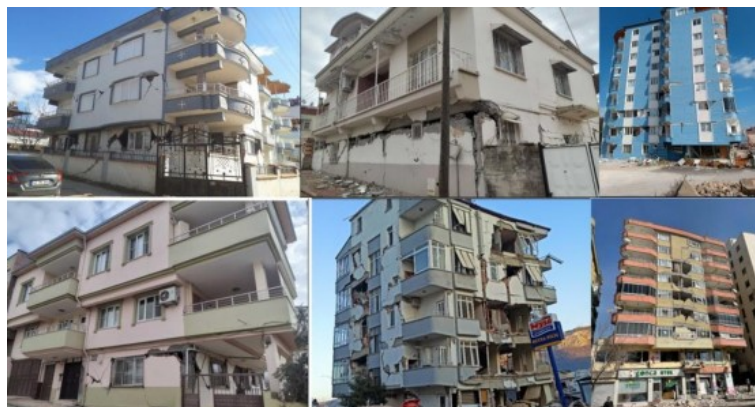
Εικόνα 2.9 Παραδείγματα κτιρίων με πολύ μεγάλες βλάβες Βαθμός 4 (Işık, E. et al, 2023)
