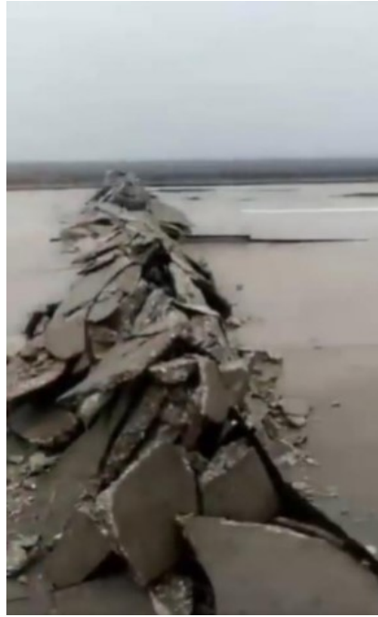
Εικόνα 2.30 Αστοχίες στον διάδρομο του Αερολιμένα Χάταϊ (Evangelia G. et al, 2023)
