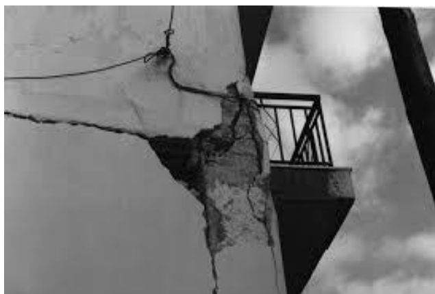
Εικόνα 3.4 Βλάβη σε εξωτερικό γωνιακό κόμβο με ρωγμές που οφείλονται στον εσωτερικό εφελκυσμό κατά την έντονη σεισμική διέγερση, Εικόνα από Γαρυφάλη Άγγελο 6 ο Φοιτητικό Συνέδριο <<Επισκευές Κατασκευών 2000>> Φεβρουάριος 2000
