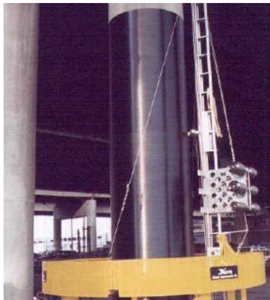
Εικόνα 6.3 Ενίσχυση Υποστυλώματος με χρήση Μανδύα από FRP, Εικόνα από Ρέζου Αγγελική, Ενίσχυση Υποστυλωμάτων: Περίσφιξη με χρήση των Ινοπλισμένων Πολυμερών FRP.
