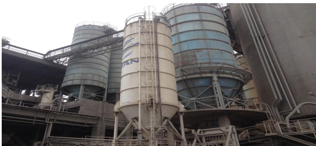
Εικόνα 15.6 Στις Εικόνες απεικονίζονται η Εκπαιδευτική Επίσκεψη και Παρουσίαση στις Εγκαταστάσεις Παραγωγής Τσιμέντου της Εταιρείας TITAN στην Ελευσίνα (Γκερδούκη Χριστίνα 12/12/2018).
