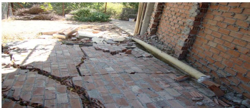
Εικόνα 2.3 Ζημιές στην Τοιχοποιία λόγω κακοτεχνιών σε εξωτερικούς τοίχους με διπλή σειρά τούβλων (Εικόνα από την εφημερίδα Βήμα για το Σεισμό της Κεφαλονιάς).
