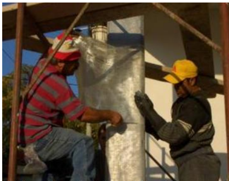
Εικόνα 6.5 Ενίσχυση Υποστυλώματος με Υαλο-Υφασμα, Παρουσίαση Επεμβάσεις σε Υφιστάμενα Κτίρια από Ειρήνη Εφασίου Καθηγήτρια Αρχιτεκτόνων Μηχανικών ΕΜΠ
