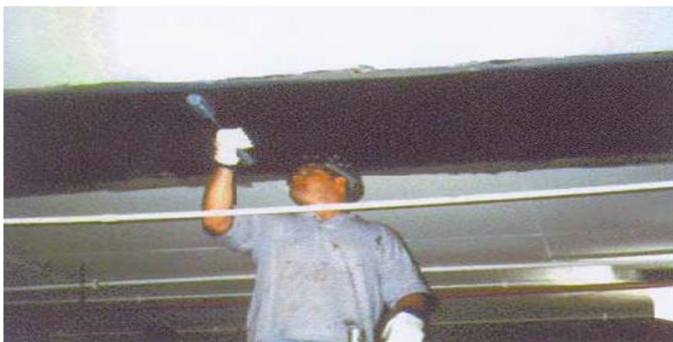
Εικόνα 5.24 Στάδιο Δεύτερο Εφαρμογής Σύνθετων Υλικών όπου χρησιμοποιώντας ειδικό ρολό ασκεί μία συνεχή πίεση πάνω στο νήμα κατά την διεύθυνση των ινών, Εικόνα από Θεοδοδωρόπουλο Χρήστο Ενίσχυση Δοκών με Ινοπλισμένα Πολυμερή Πλαστικά FRP
