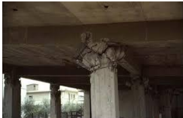
Εικόνα 3.2 Διατμητική Αστοχία πάνω άκρου υποστυλωμάτων λόγω απουσίας συνδετήρων όπου μανδύας των συνδετήρων φτάνει μέχρι και 0,5 m κάτω από τις δοκούς, Εικόνα από Γιανόπουλους Ιωάννης Βλάβες από τον Σεισμό της Αθήνας (1999)
