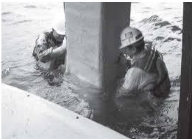
Εικόνα 5.13 Εφαρμογή και Τοποθέτηση FRP στη Γέφυρα Friendship Trails με το σύστημα pre-preg system, Εικόνα από 13 ο Συνέδριο Επισκευές Κατασκευών Φεβρουάριος 2017 Κορρές Πέτρος
