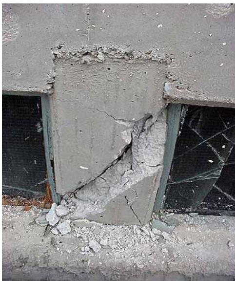
Εικόνα 2.1 Παράδειγμα Αστοχίας <<Κοντού>> Υποστυλώματος
