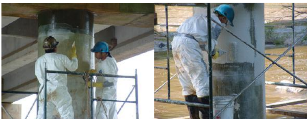
Εικόνα 5.17 Στην αριστερή εικόνα εργάτες τοποθετούν δύο τμήματα περικαλύμματος ινοπλισμένου πολυμερούς από υαλόνημα προκειμένου να αυξήσουν την ικανότητα μεταφοράς φορτίων και την ολκιμότητα για περιπτώσεις σεισμού. Στην δεξιά εικόνα τοποθετείται γκρι χρωματισμός για να ταιριάζει με το σκυρόδεμα του υποστυλώματος, Εικόνα από το 13 ο Φοιτητικό Συνέδριο Επισκευές των Κατασκευών Πάτρα Φεβρουάριος 2007 Παπασεραφειμ Αναστασία
