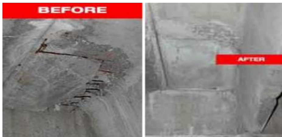
Εικόνα 5.20 Επιδιόρθωση Βλαβών με Ρητινένεσις και Προετοιμασία Επιφάνειας, Εικόνα από το 23 ο Φοιτητικό Συνέδριο Επισκευές των Κατασκευών Πάτρα Φεβρουάριος 2017 Κατσαμάκας Αντώνης, Μυλωνάς Αντώνης-Ιωάννης
