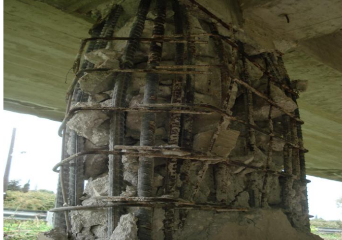
Εικόνα 2.4 Κατασκευαστικές λεπτομέρειες όπως <<Ανοιχτοί>>. Συνδετήρες και Οξείδωση Οπλισμών μειώνοντας την αντοχή της κατασκευής (Εικόνα από την εφημερίδα Βήμα για το Σεισμό της Κεφαλονιάς).
