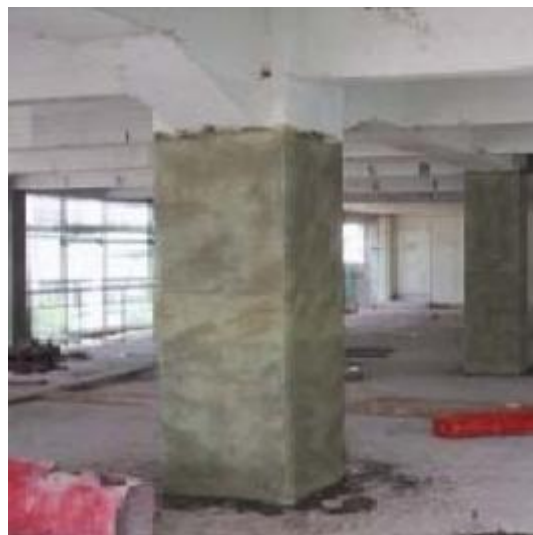
Εικόνα 4.3 Ενίσχυση Υποστυλώματος με Μανδύα FRP, Εικόνα από Καίρης Στέφανος, Χατζηβασιλειάδης Αναστάσιος 14 ο Συνέδριο Επισκευές Κατασκευών Πάτρα Φεβρουάριος 2008
