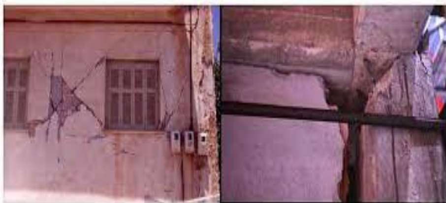
Εικόνα 2.2 Παράδειγμα Αστοχίας Υποστλωμάτων από τις ισχυρές Τοιχοπληρώσεις στην Κατασκευή
