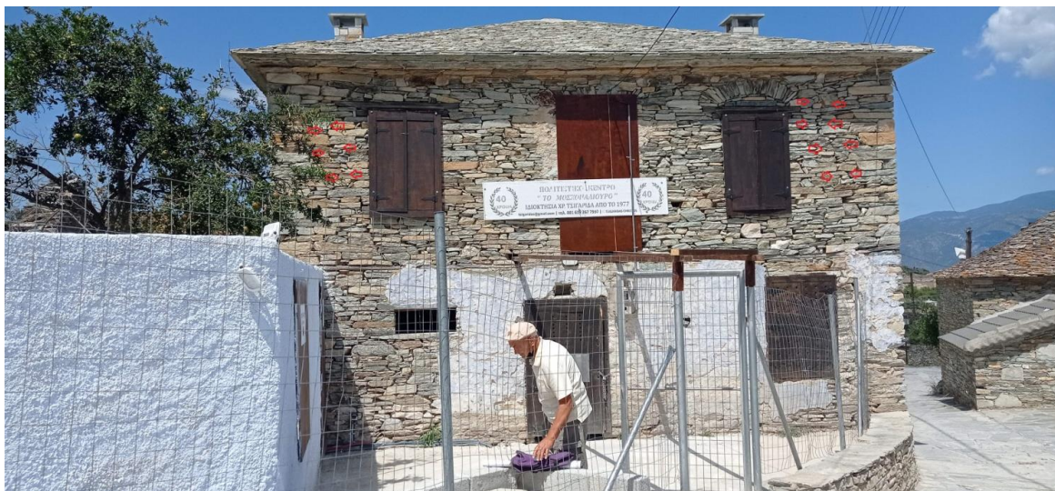
Σχήμα Γ.9 Διαγώνιες ρωγμές στις γωνίες του κτιρίου α όροφος
