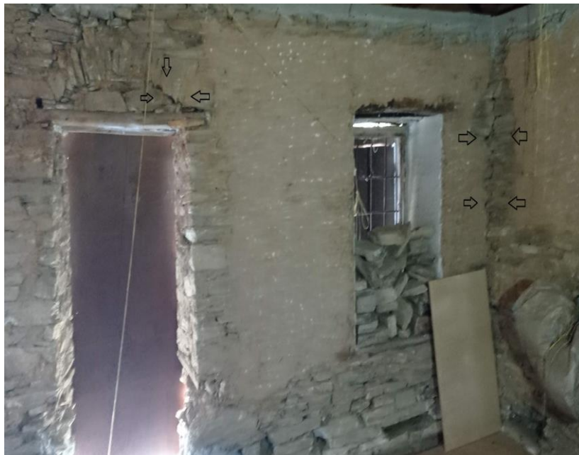
Σχήμα Γ.8 Ρωγμή αποκόλλησης στην σύνδεση φερόντων τοίχων- διαγώνια ρηγμάτωση φέροντα τοίχου (εντός επιπέδου αστοχία), οριζόντια ρηγμάτωση διαζώματος από Ω/Σ στον α όροφο-παθολογία.)
