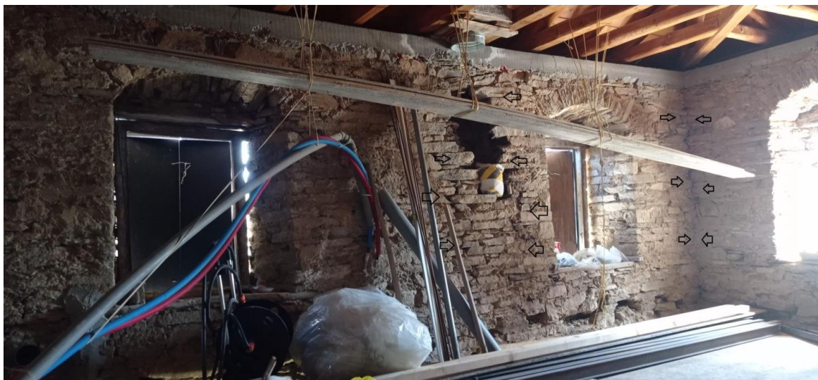
Σχήμα Γ.11 Ρωγή αποκόλλησης στην σύνδεση φερόντων τοίχων- Ρηγμάτωση περιμετρικά της εσωτερικής καπνοδόχου, α όροφος
