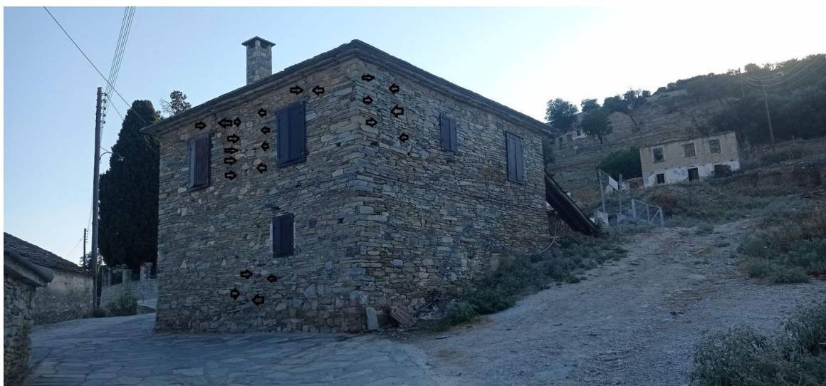
Σχήμα Γ.10 Αστοχία διπλών υπέρθυρων (τοξωτών και ευθύγραμμων), ρηγμάτωση περιμετρικά της εσωτερικής καπνοδόχου, ρηγμάτωση στην γωνία του κτιρίου του ορόφου και διαγώνια ρηγμάτωση στην ποδιά ανοίγματος στο ισόγειο)
