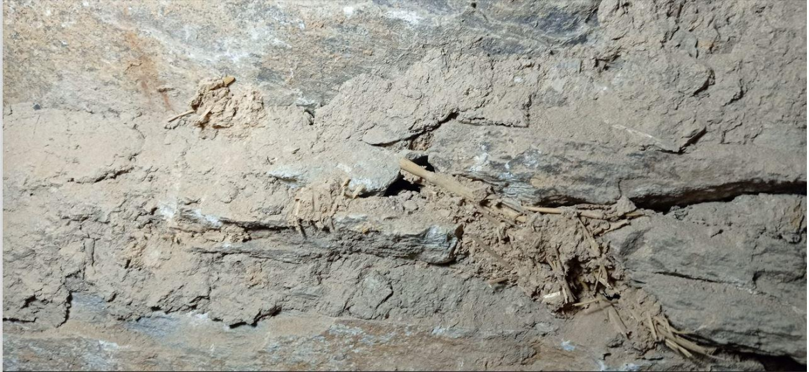
Σχήμα 5.14 Λεπτομέρεια του κονιάματος με την χρήση άχυρου σε εσωτερική πλευρά της φέρουσας τοιχοποιίας
