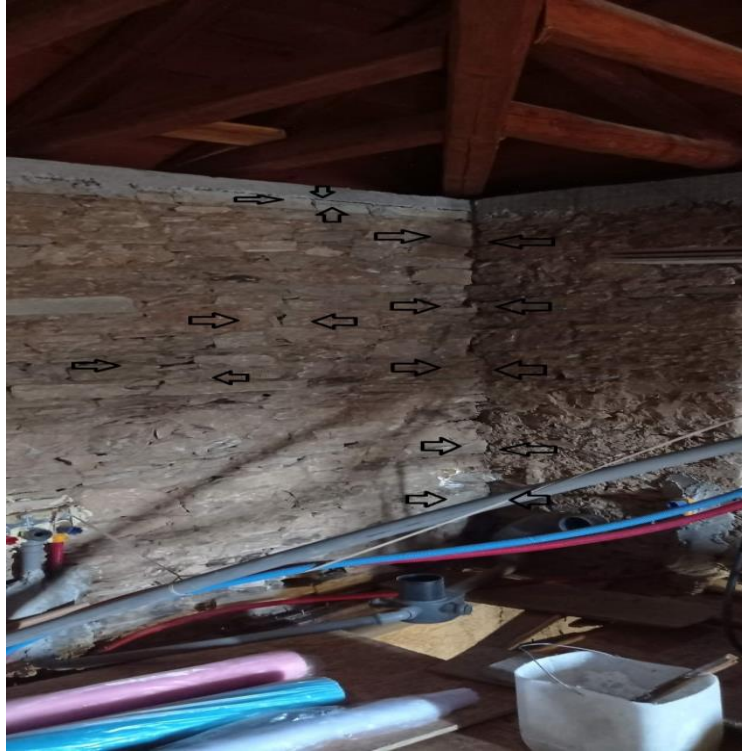
Σχήμα Γ.7 Ρωγμή αποκόλλησης στην σύνδεση φερόντων τοίχων- διαγώνια ρηγμάτωση φέροντα τοίχου (εντός επιπέδου αστοχία), οριζόντια ρηγμάτωση διαζώματος από Ω/Σ στον α όροφο-παθολογία)
