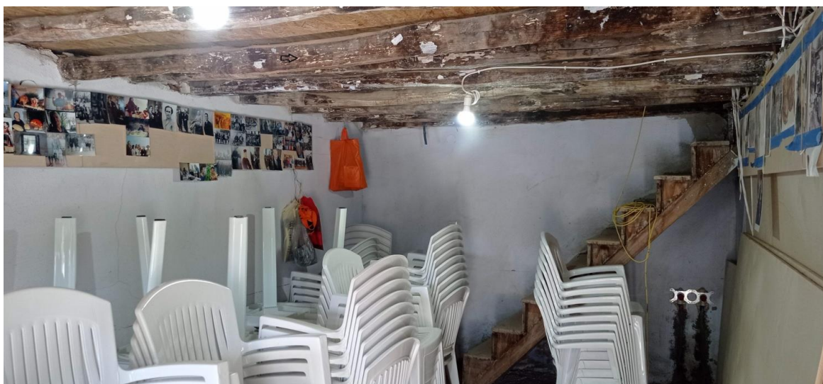
Σχήμα Γ.12 Φθορά ξυλείας δοκίδων πατώματος α ορόφου-παθολογία
