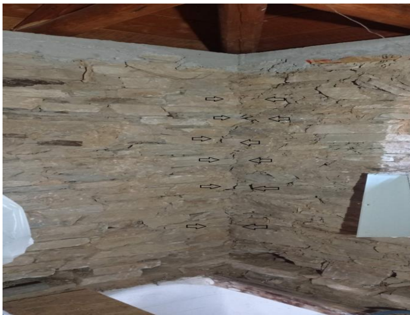
Σχήμα Γ.6 Ρωγμή αποκόλλησης στην σύνδεση φερόντων τοίχων α ορόφου-παθολογία.
