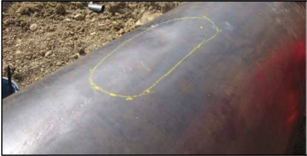
Εικόνα 3.15: Χτύπημα σε αγωγό μεταφοράς ΦΑ (Gopal, 2020)
