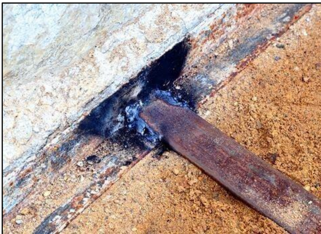
Εικόνα 3.18: Διάβρωση λόγω αστοχίας συγκόλλησης (Mwiks, 2020)
