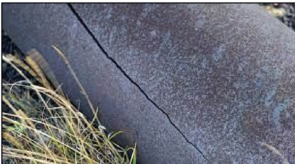
Εικόνα 3.14: Ρωγή σε αγωγό μεταφοράς ΦΑ (Gopal, 2020)
