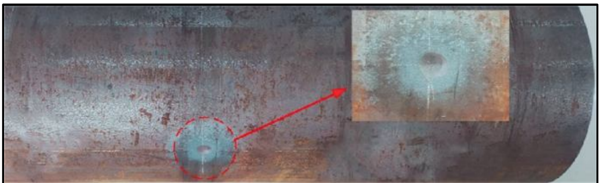
Εικόνα 3.16: Βαθούλωμα σε αγωγό μεταφοράς ΦΑ (Gopal, 2020)
