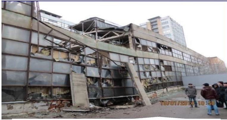
Εικόνα 1.9 Παράδειγμα ατυχήματος επιφανειακής καθίζησης με αστοχίες σε επίγεια κτηριακή δομή λόγω ανωμαλιών στην γεωλογική στρώση στον άξονα του TBM (Khokhlov, 2021)
