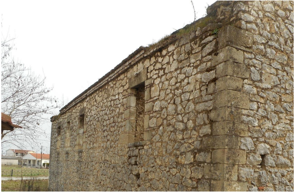
Εικόνα 33. Απώλεια οπτόπλινθων κατασκευής γείσου
