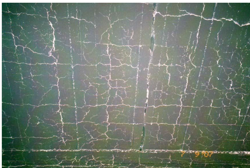
Πλάκα Ο.Σ., χαρακτηριστικές πολλαπλές ρωγμές (καί «άτακτες», καί πάνω στον οπλισμό).
