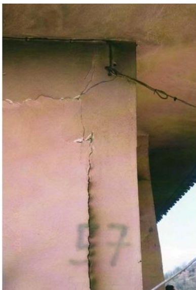
Κτίριο από Ο.Σ.. Αποσύνδεση και μετακίνηση της τοιχοπλήρωσης, καπνός από την εσωτερική φωτιά μέσα από την ρωγμή, ενώ παρατηρείται και ελαφριά ρηγματώση του γωνιακού κόμβου.
