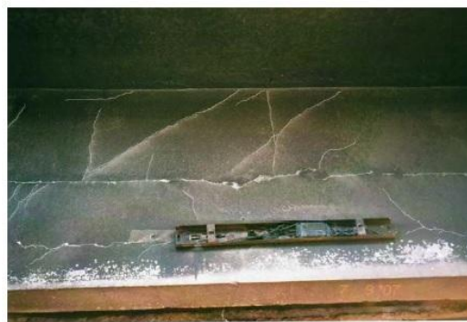
Διαμπερηής ρωγμή πλάκας/προβόλου στην πρόσψη κτιρίου.
