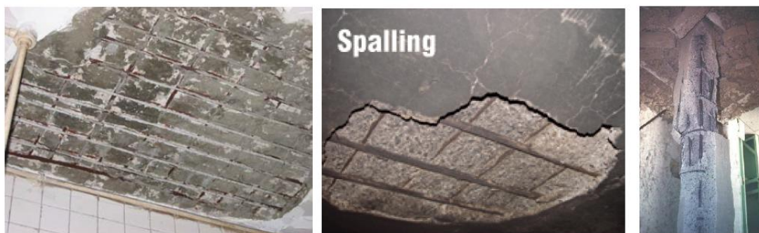
Εικόνα Βλάβες δομικών στοιχείων οπλισμένου σκυροδέματος
