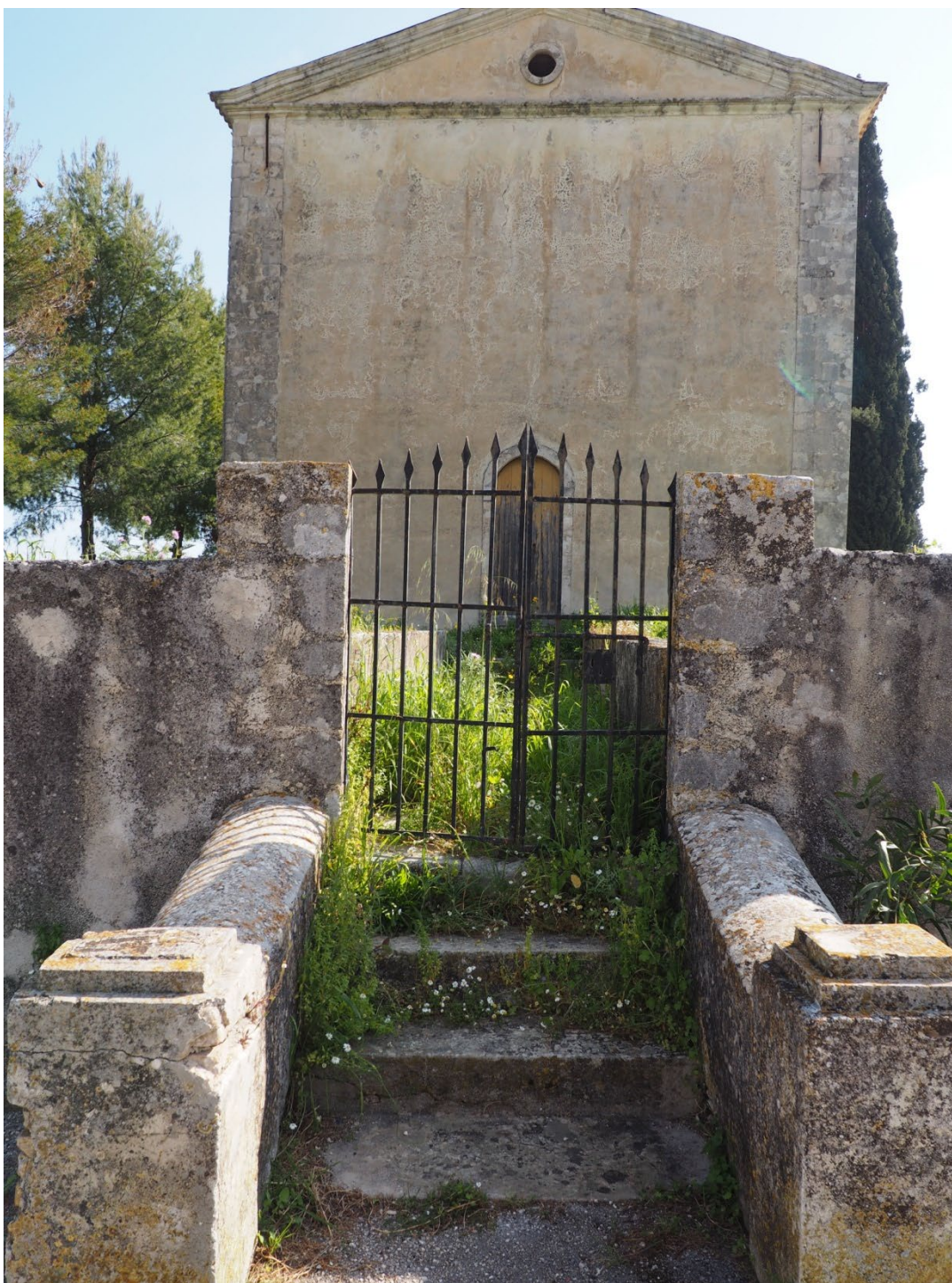
Εικόνα 128. Ρωγμές και αποδιοργανώσεις στη επιχρισμένη αργολιθοδομή του περιβάλλοντος χώρου.
