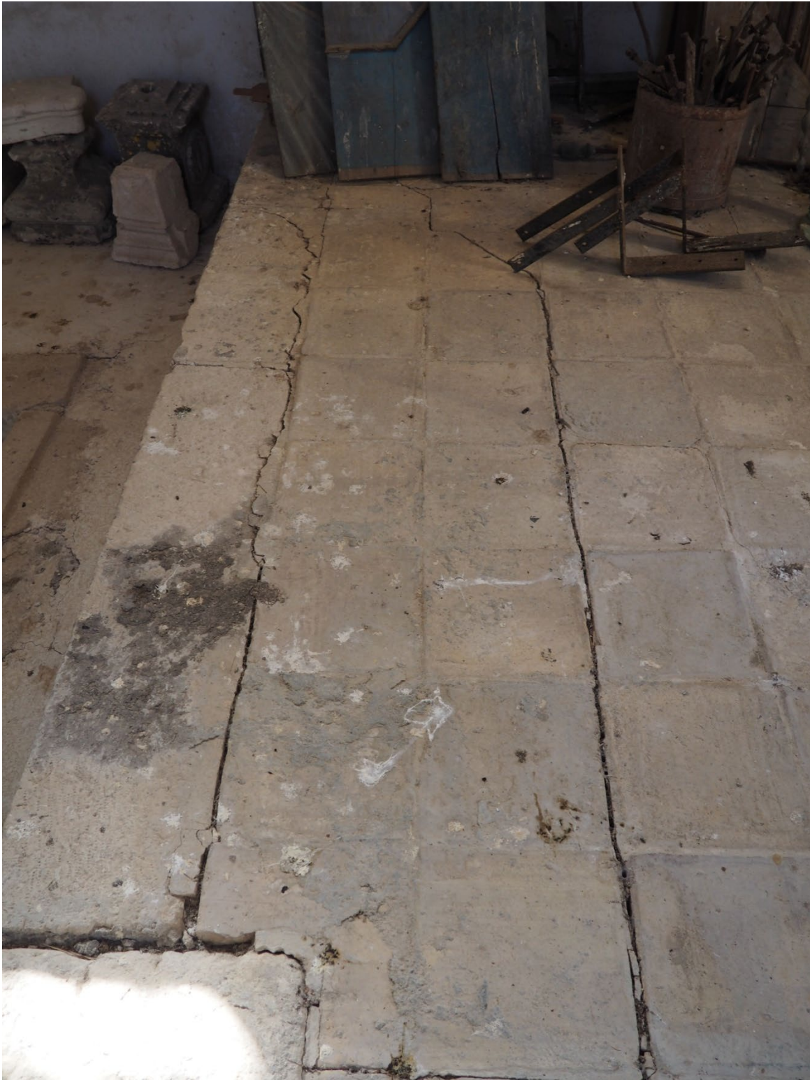
Εικόνα 117. Ρωγμές στο δάπεδο του γυναικωνίτη.
