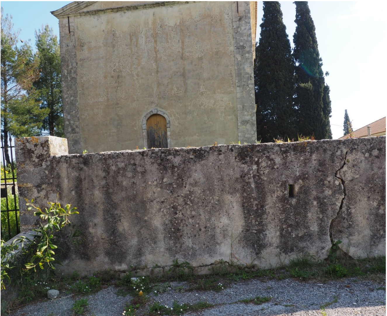
Εικόνα 124. Ρωγμές και αποδιοργανώσεις στη επιχρισμένη αργολιθοδομή του περιβάλλοντος χώρου.
