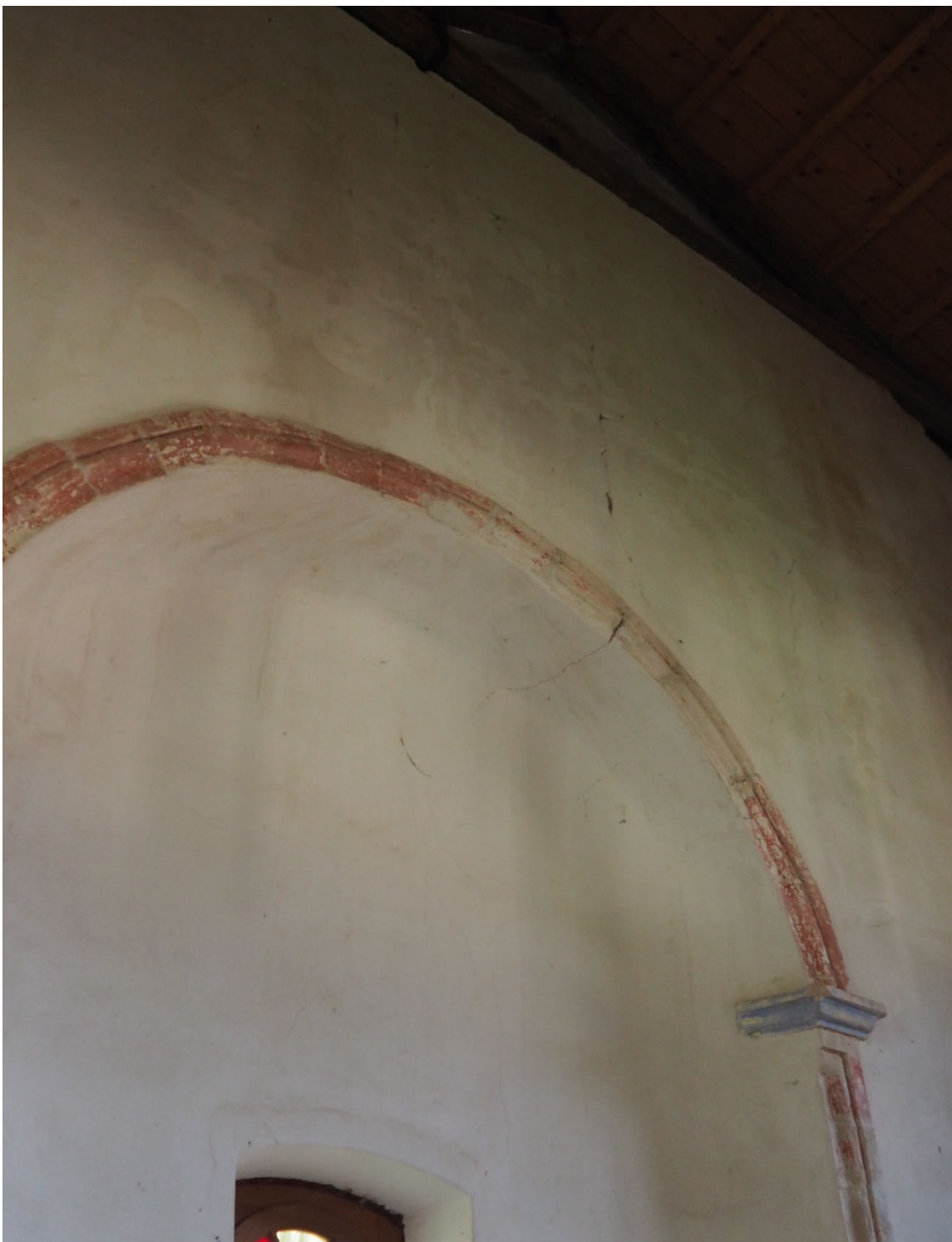
Εικόνα 112. Κατακόρυφη ρωγμή στην κόγχη του Ιερού.
