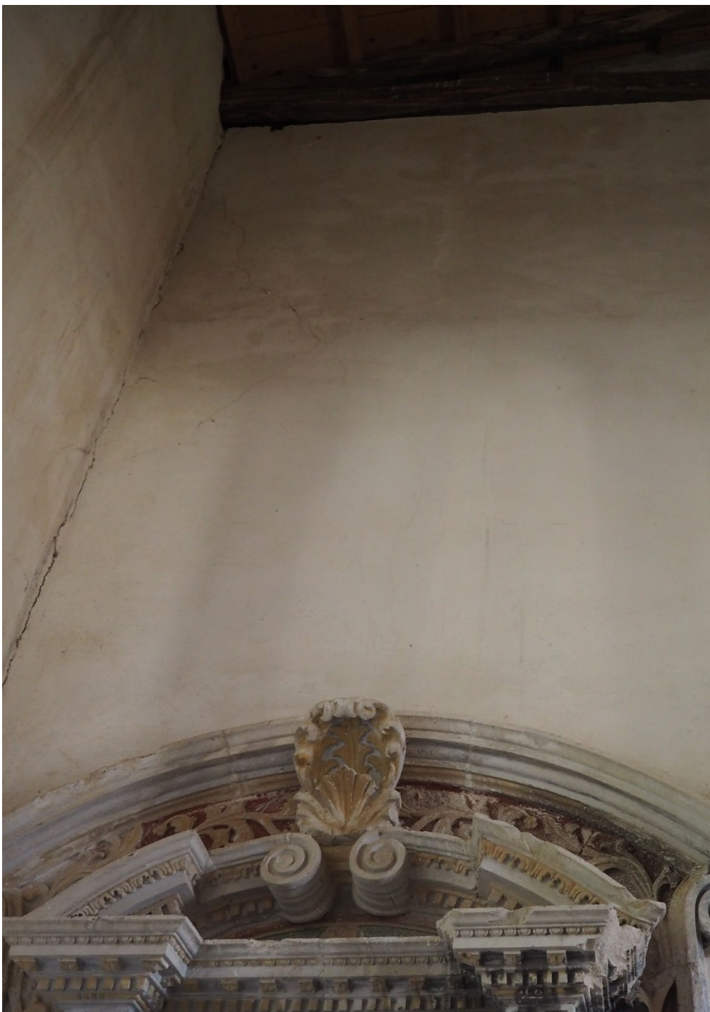
Εικόνα 113. Κατακόρυφη ρωγμή στην αριστερή πλευρά της Πρόθεσης.
