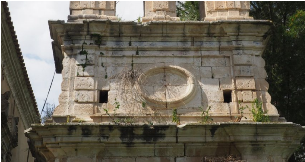
Εικόνα 139. Ρηγματώσεις, αποσάθρωση λίθου, απώλεια υλικού, υγρασία, βιολογικές επικαθίσεις παρατηρούνται στο κωδωνοστάσιο.
