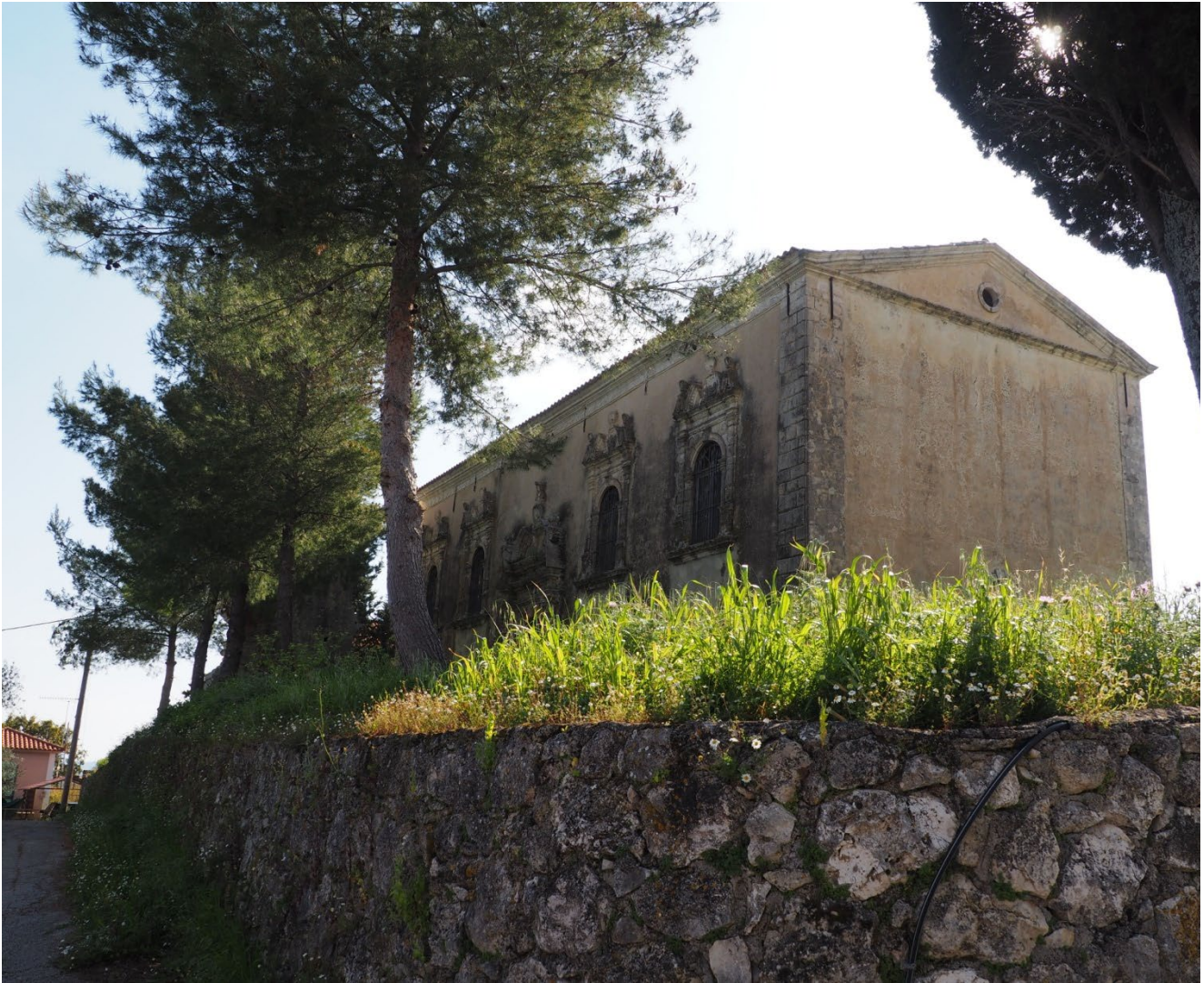
Εικόνα 127. Ρωγμές και αποδιοργανώσεις στη επιχρισμένη αργολιθοδομή του περιβάλλοντος χώρου.
