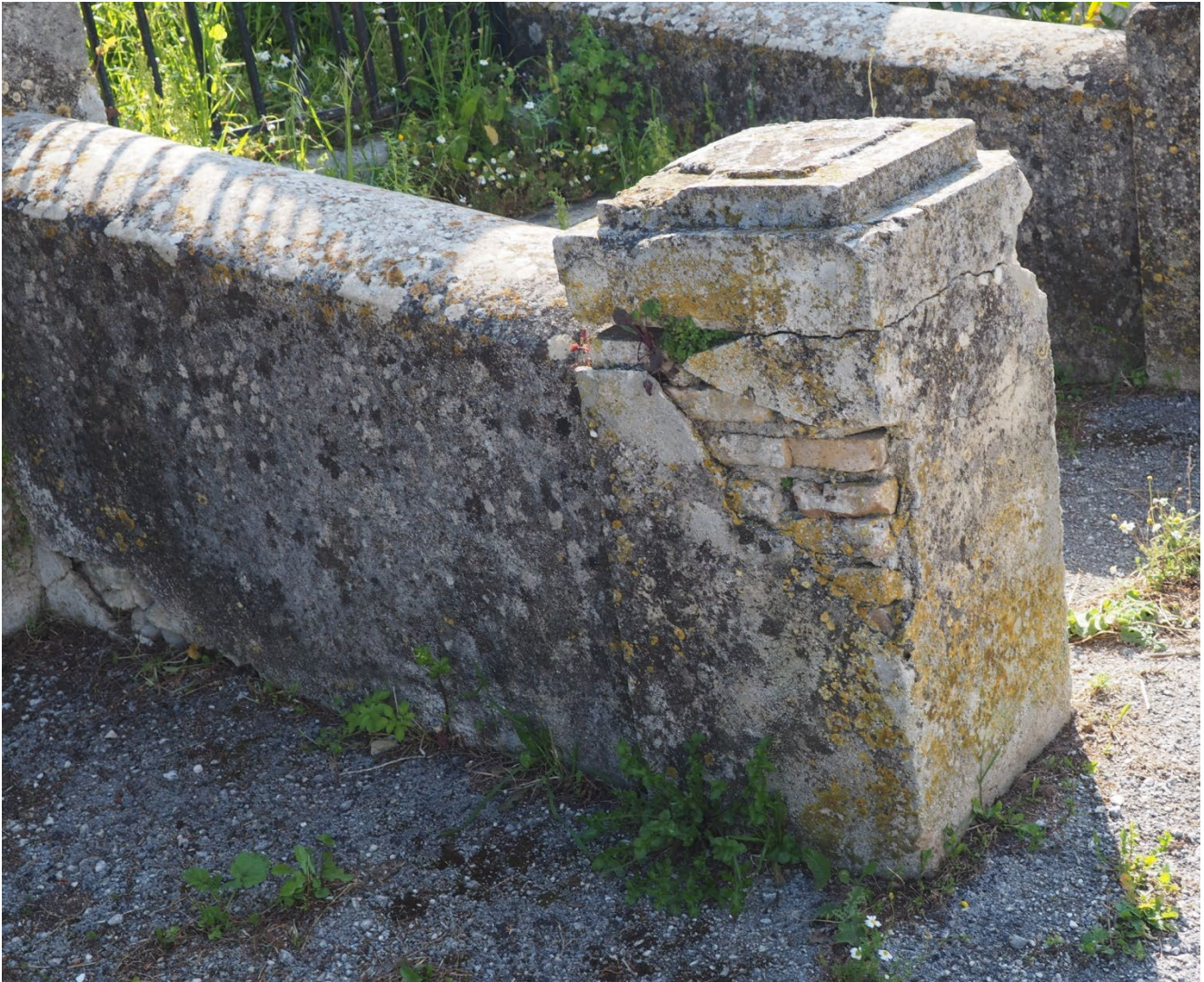
Εικόνα 126. Ρωγμές και αποδιοργανώσεις στη επιχρισμένη αργολιθοδομή του περιβάλλοντος χώρου.
