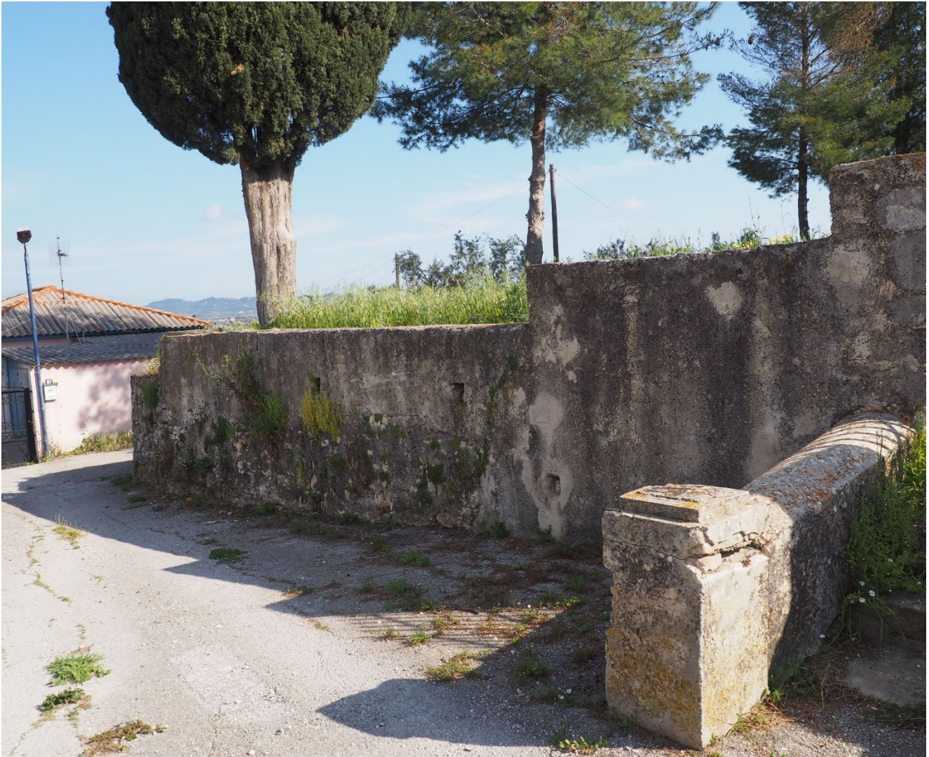
Εικόνα 125. Ρωγμές και αποδιοργανώσεις στη επιχρισμένη αργολιθοδομή του περιβάλλοντος χώρου.
