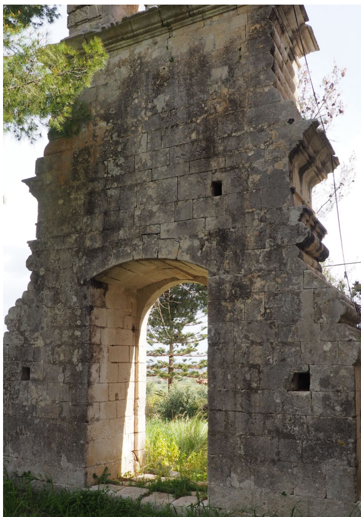
Εικόνα 140. Ρηγματώσεις, αποσάθρωση λίθου, απώλεια υλικού, υγρασία, βιολογικές επικαθίσεις παρατηρούνται στο κωδωνοστάσιο.
