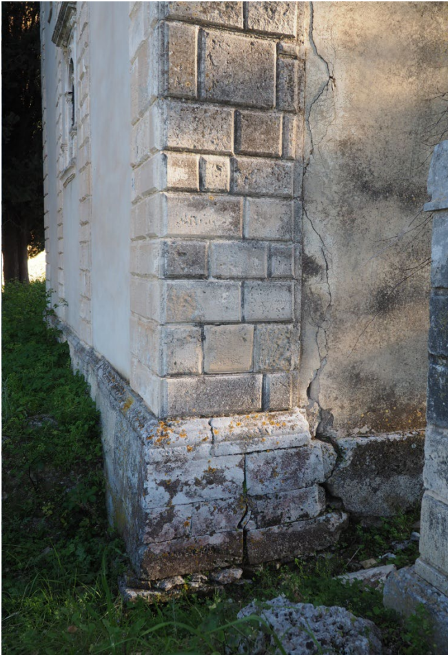
Εικόνα 107. Κατακόρυφη ρωγή και αποσύνθεση λιθοδομής στη βορειοανατολική πλευρά του ναού.
