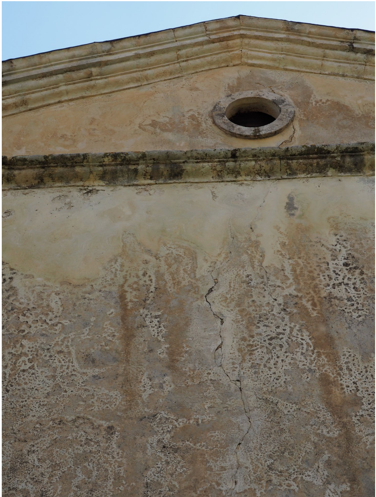
Εικόνα 110. Κατακόρυφη ρωγμή στη Δυτική πλευρά.
