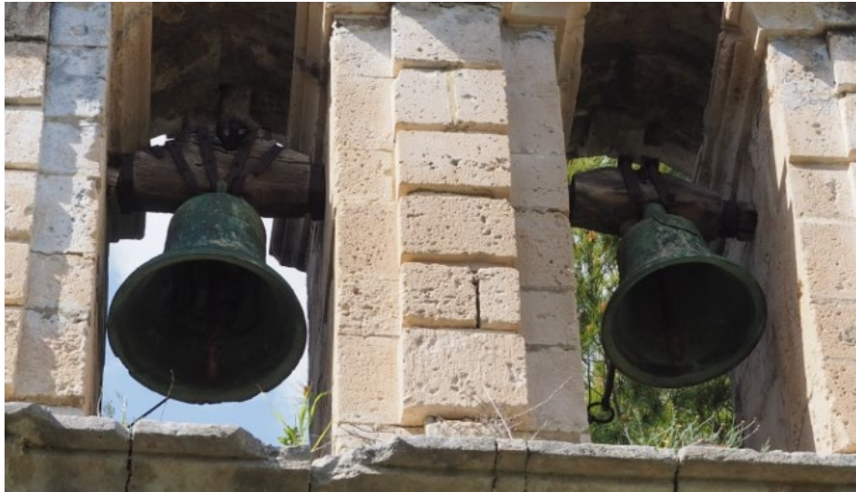
Εικόνα 141. Οξείδωση μεταλλικών στοιχείων.
