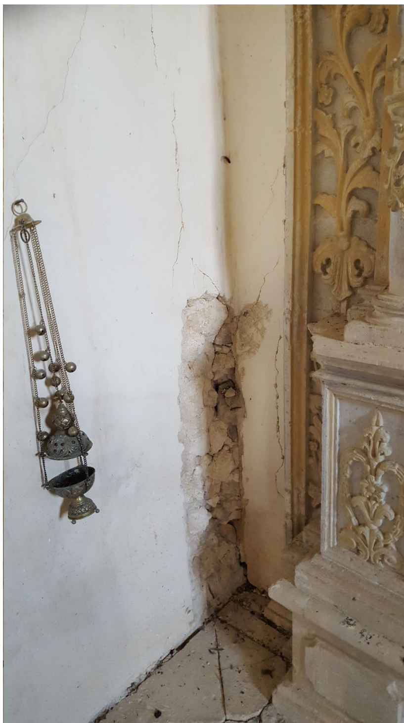
Εικόνα 114. Κατακόρυφη ρωγμή και αποσύνθεση λιθοδομής.
