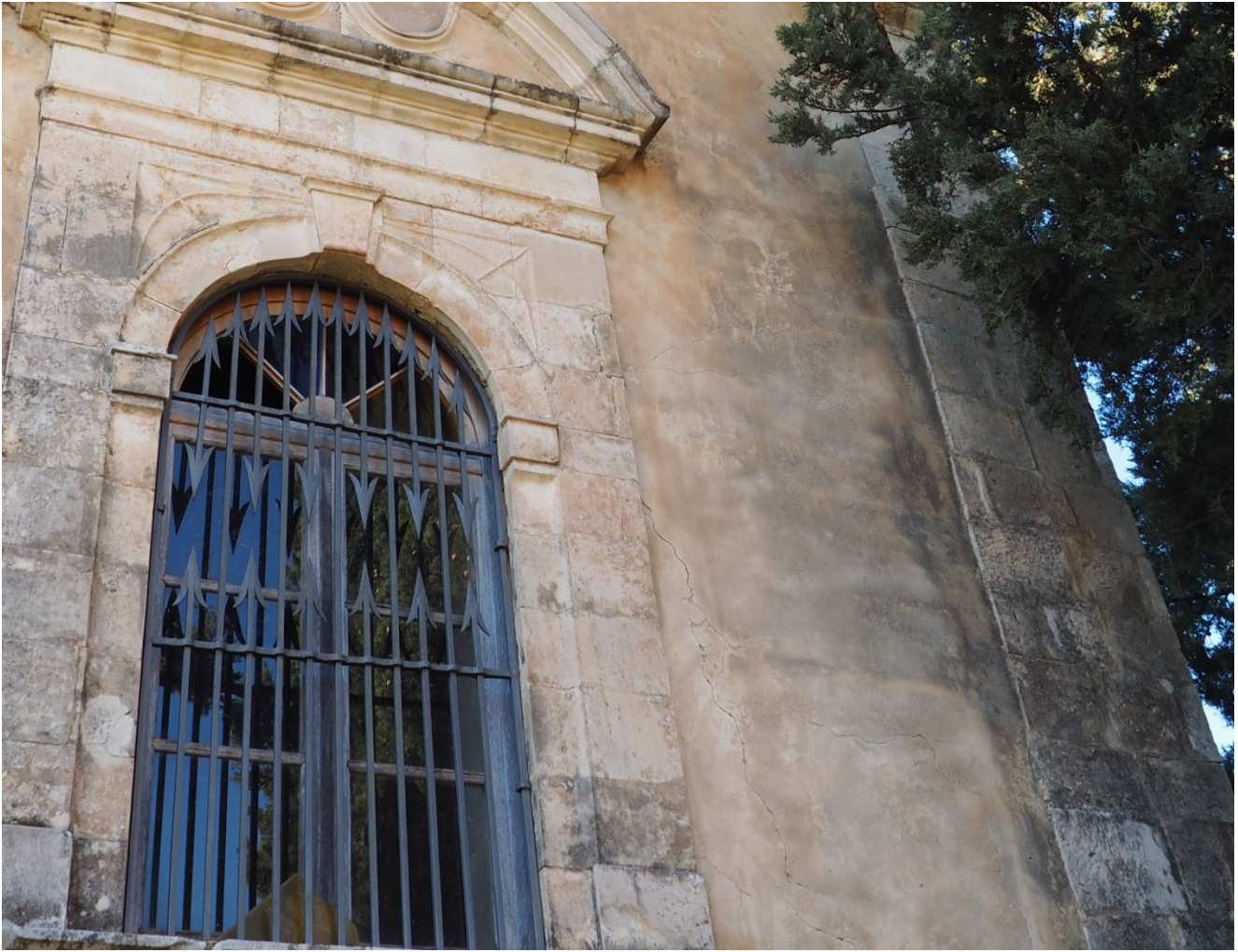
Εικόνα 111. Διαγώνιες ρωγμές αριστερά του παραθύρου στη Νότια πλευρά.
