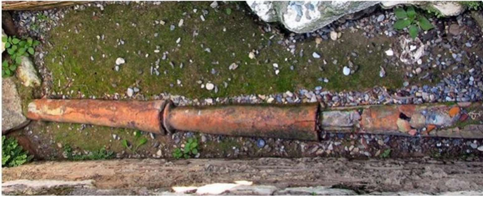
Εικόνα 3.2: Σωλήνας ύδρευσης στη Κνωσό. Πηγή: Υδρο-τεχνολογίες στη Μινωική Κρήτη, Α.Ν Αγγελάκης, Εσπερίδα στο πλαίσιο του εορτασμού της Παγκόσμιας ημέρας νερού, Χανιά 22 Μαρτίου 2019.
