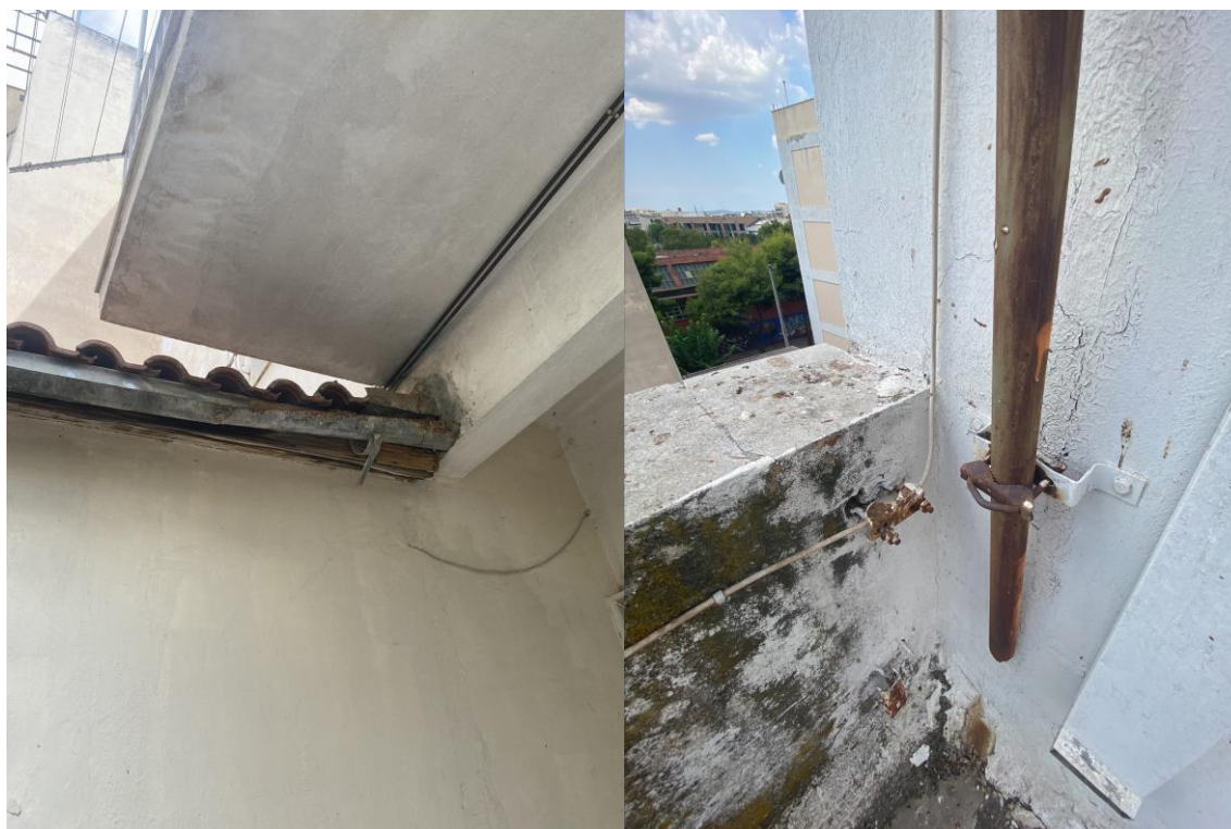
Εικόνα 5-27: Φθαρμένα στοιχεία που χρήζουν αντικατάστασης (σωληνώσεις, καλώδια, κεραία τηλεόρασης κλπ)
