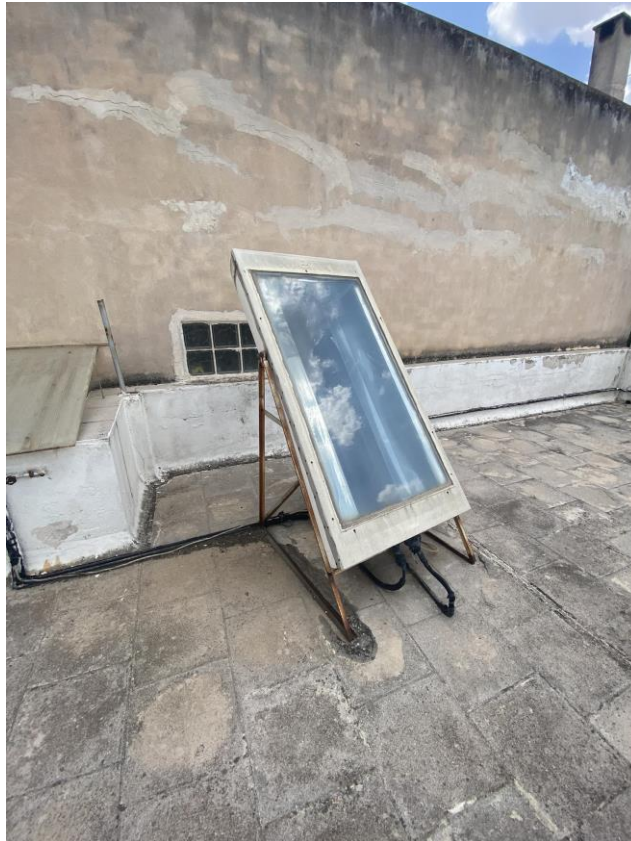
Εικόνα 5-25: Πάνελ του ηλιακού θερμοσίφωνα του 1 ου ορόφου
