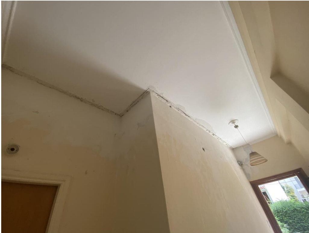
Εικόνα 5-11: Καθίζηση τοίχου στην κεντρική είσοδο του κτιρίου
