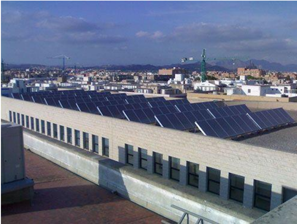
Εικόνα 4-5: Φωτοβολταϊκά συστήματα σε δάμα νοσοκομειακού κτιρίου στην πόλη Μούρθια της Ισπανίας [75]
