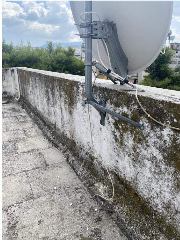
Εικόνα 5-23: Προβλήματα υγρασίας και μούχλας στο στηθαίο και γενικότερα στο χώρο της ταράτσας του κτιρίου
