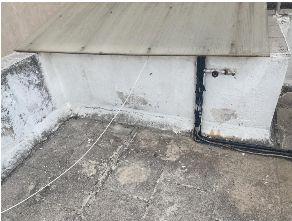
Εικόνα 5-24: Προβλήματα υγρασίας στο χώρο της ταράτσας του κτιρίου
