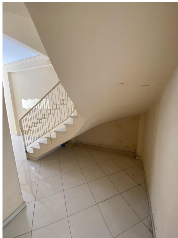
Εικόνα 5-12: Προβλήματα υγρασίας στο κλιμακοστάσιο
