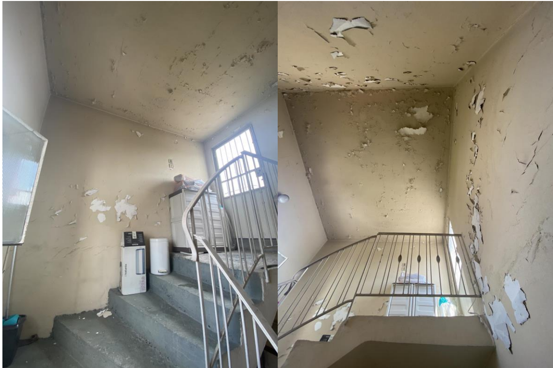
Εικόνα 5-19: Έξοδος προς την ταράτσα του κτιρίου. Το ξεφλούδισμα του χρώματος των τοίχων οφείλεται στη χρήση κόλλας πλακιδίων ως επίχρισμα, αντί ασταριού.
