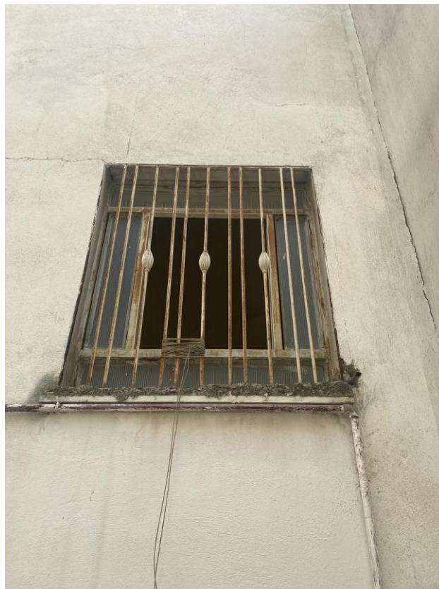
Εικόνα 5-20: Παλιό παράθυρο του κλιμακοστασίου, σε κακή κατάσταση
