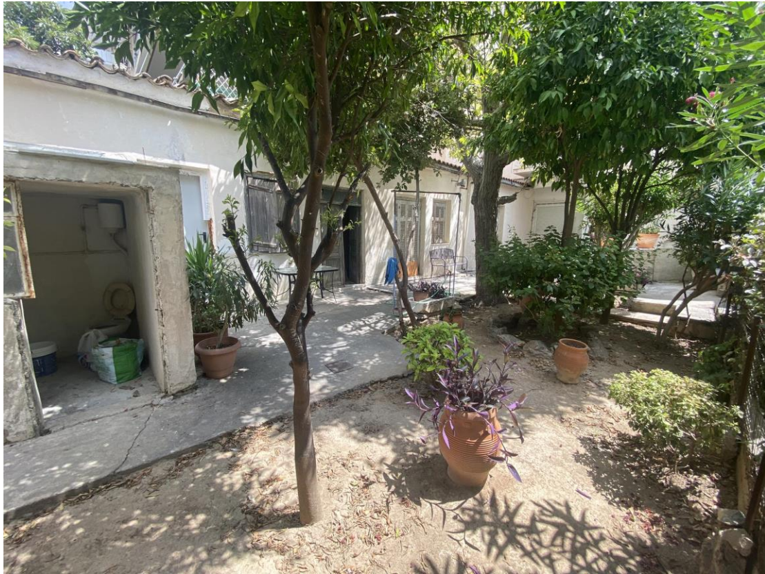
Εικόνα 5-3: Πίσω αυλή του κτιρίου με κτίσματα της δεκαετίας του '20, τα οποία κρίνονται κατεδαφιστέα
