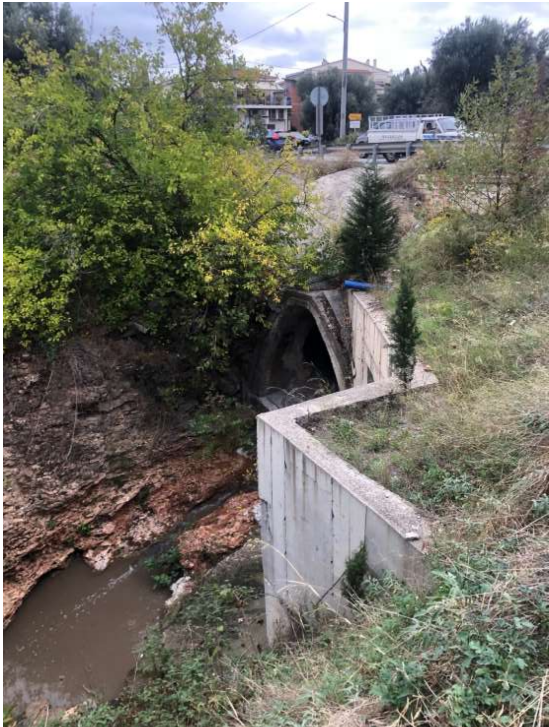
ΕΙΚΟΝΑ 28 ΚΑΝΑΛΙ ΟΜΒΡΙΩΝ (ΠΑΡΕΜΒΑΣΗ ΑΝΘΡΩΠΟΥ ΣΤΟ ΡΕΜΑ ΤΗΣ ΠΥΡΝΑΣ)
