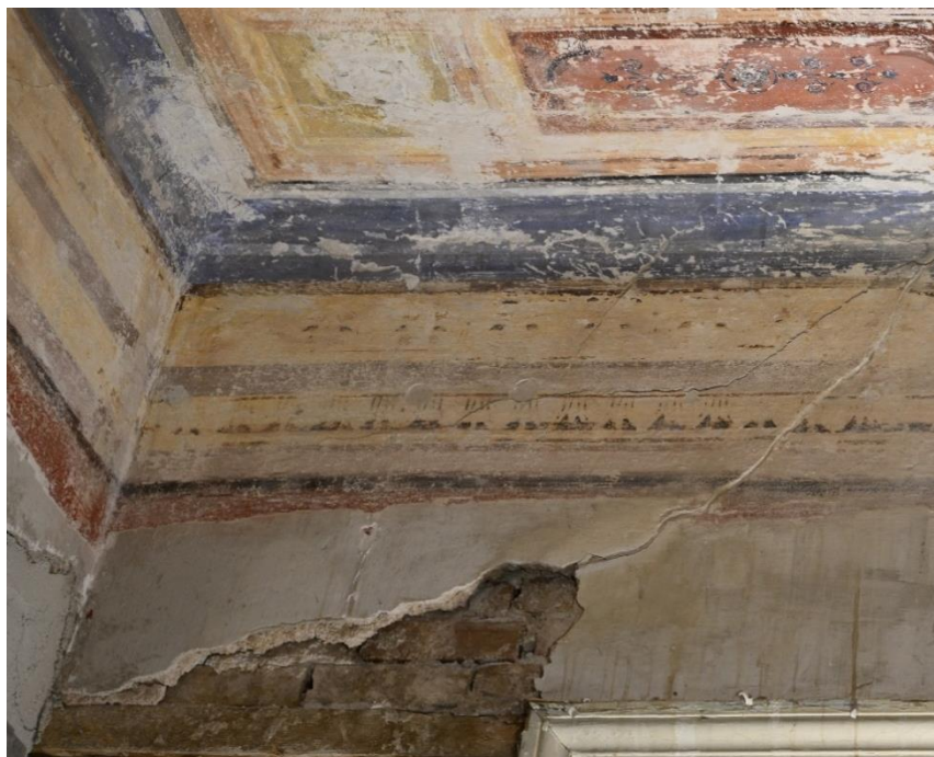
Εικόνα 60. Αποκολλημένο τμήμα υποστρώματος με έντονη τάση για απόσπαση. Πηγή: Προσωπικό αρχείο
