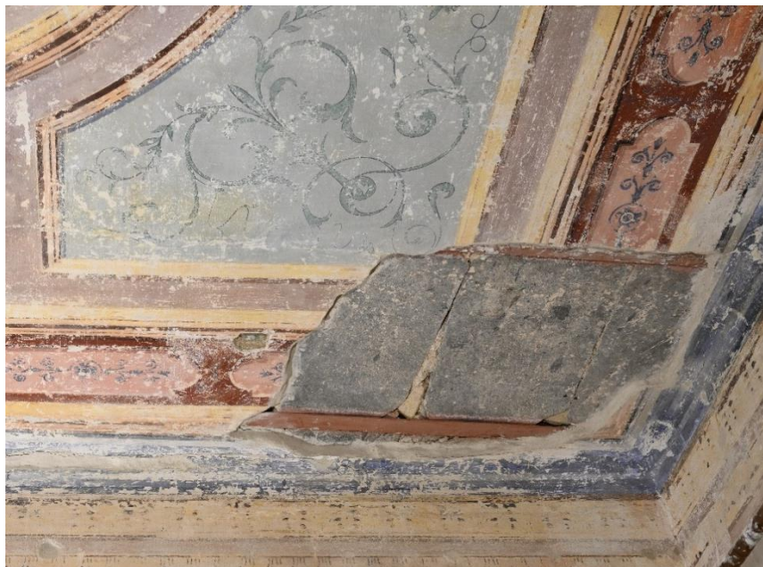
Εικόνα 62. Απώλειες τμημάτων κονιάματος μαζί με τη ζωγραφική επιφάνεια. Πηγή: Προσωπικό αρχείο
