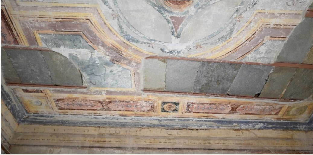
Εικόνα 63. Απώλειες τμημάτων κονιάματος μαζί με τη ζωγραφική επιφάνεια. Πηγή: Προσωπικό αρχείο
