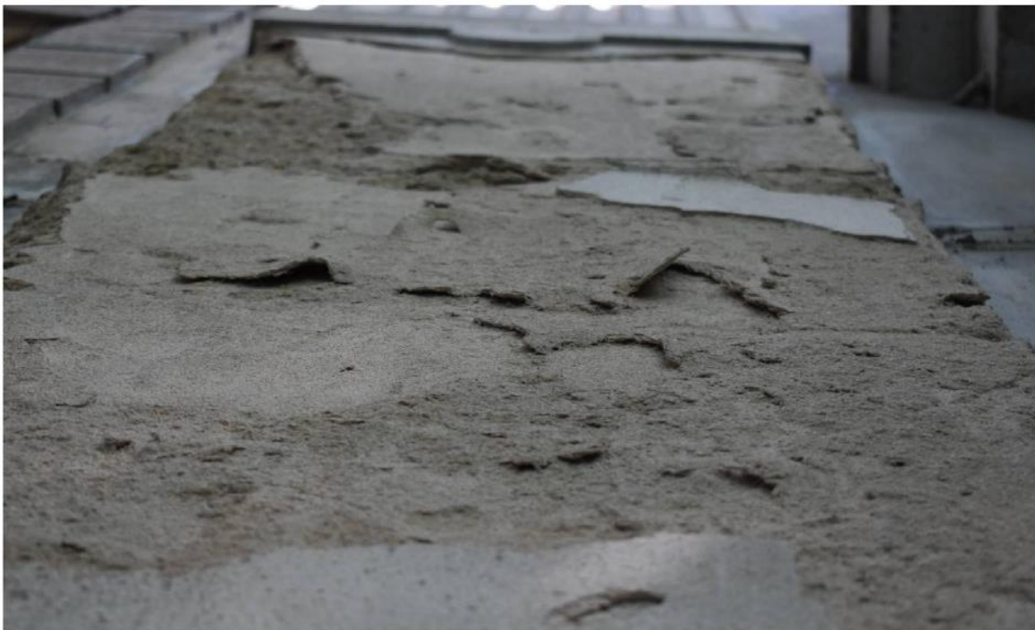
Εικόνα 42. Απώλειες και αποκολλήσεις στα επιχρίσματα ψεδοπεσσού του 1 ο ορόφου. Πηγή: Προσωπικό αρχείο.
