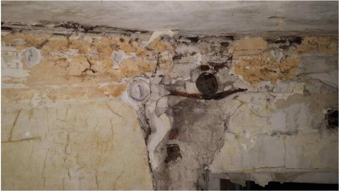
Εικόνα 46. Απώλειες κονιάματος μαζί με το ζωγραφικό στρώμα και διανοίξεις οπών και καναλιών για εγκατάσταση σωληνώσεων και καλωδιώσεων. Πηγή: Προσωπικό αρχείο.
