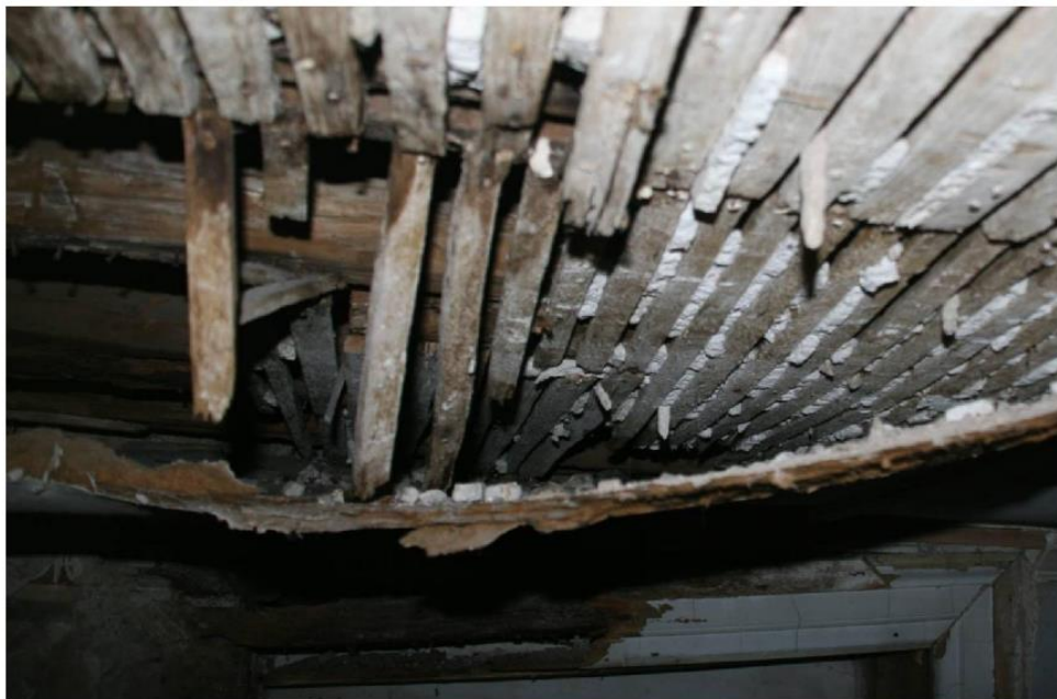
Εικόνα 47. Κατάρρευση του υποστηρίγματος (μπαγδαντί) της οροφής, απώλειες και αποκολλήσεις κονιάματος μαζί με το ζωγραφικό στρώμα. Πηγή: Προσωπικό αρχείο.
