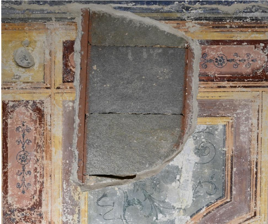
Εικόνα 61. Απώλειες τμημάτων κονιάματος μαζί με τη ζωγραφική επιφάνεια. Πηγή: Προσωπικό αρχείο
