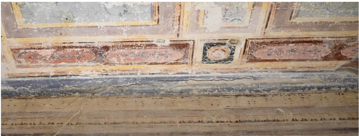
Εικόνα 59. Παρουσία ρωγματώσεων στην περιοχή της φρίζας. Πηγή: Προσωπικό αρχείο
