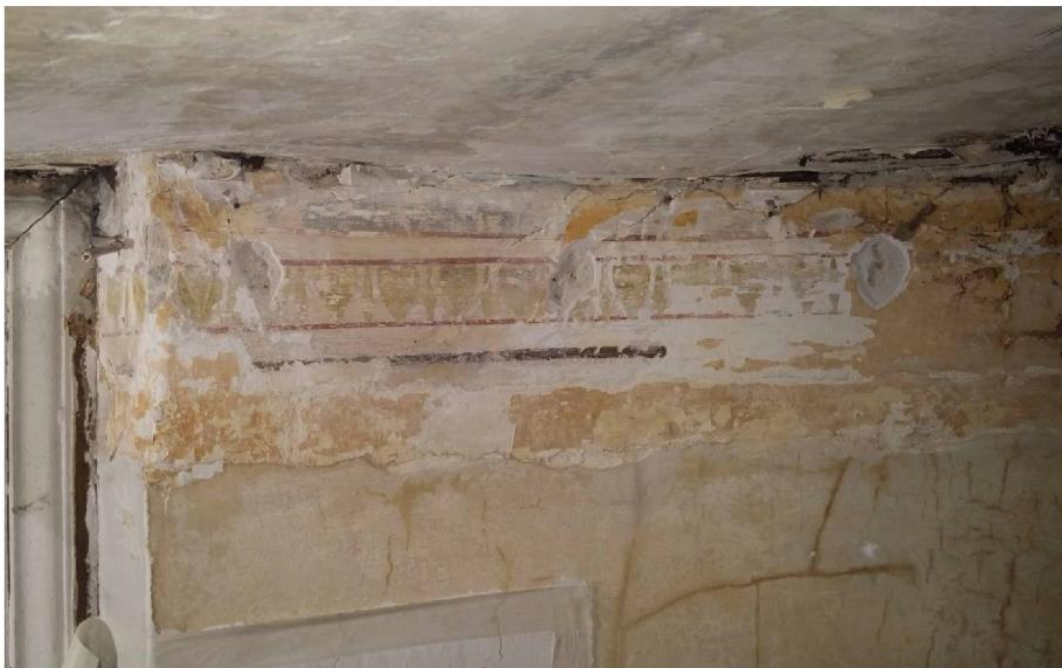
Εικόνα 45. Αποχρωματισμοί του ζωγραφικού διακόσμου, ρωγματώσεις, απώλειες κονιάματος μαζί με το ζωγραφικό στρώμα και διανοίξεις οπών και καναλιών για εγκατάσταση σωληνώσεων και καλωδιώσεων. Πηγή: Προσωπικό αρχείο.
