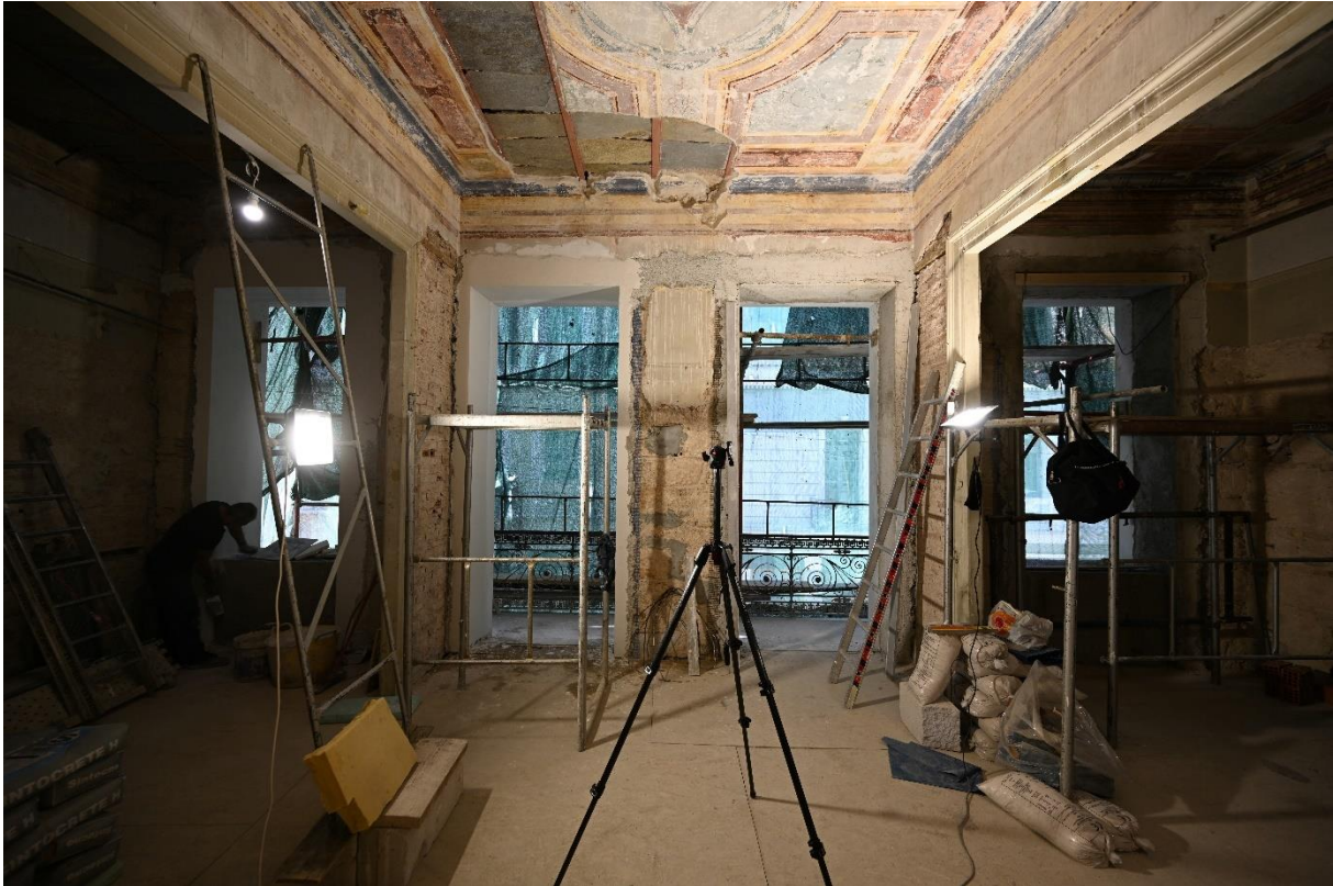
Εικόνα 88. Το δωμάτιο με την οροφोगραφία και ο εγκατεστημένος εξοπλισμός. Πηγή: Προσωπικό αρχείο.
