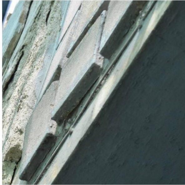
Εικόνα 41. Αποκόλληση διακοσμητικού στον 3 ο όροφο. Πηγή: Προσωπικό αρχείο.
