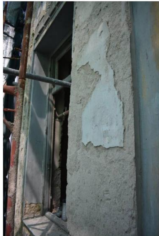
Εικόνα 36. Απώλειες επιχρισμάτων σε ψευδοπεσσό. Πηγή: Προσψπικό αρχείο.
