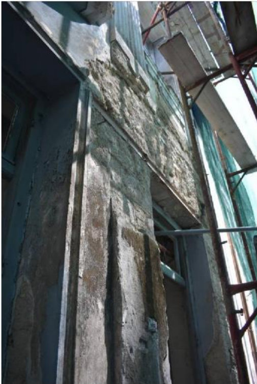
Εικόνα 35. Απώλειες τμημάτων ψευδοπεσσού και επιχρισμάτων στο α' και β' όροφο. Πηγή: Προσωπικό αρχείο
