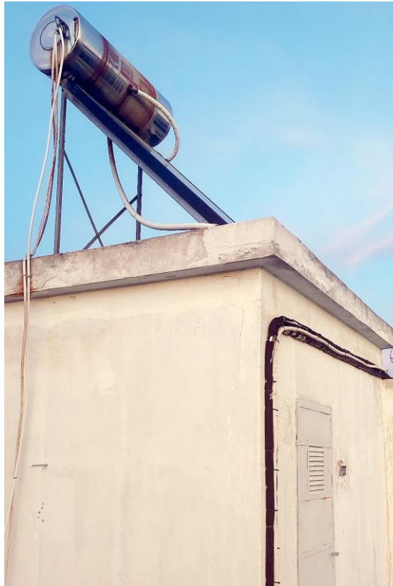
Εικόνα 2.4 Ηλιακός θερμοσίφωνας τοποθετημένος σε δυσπρόσιτο σημείο
