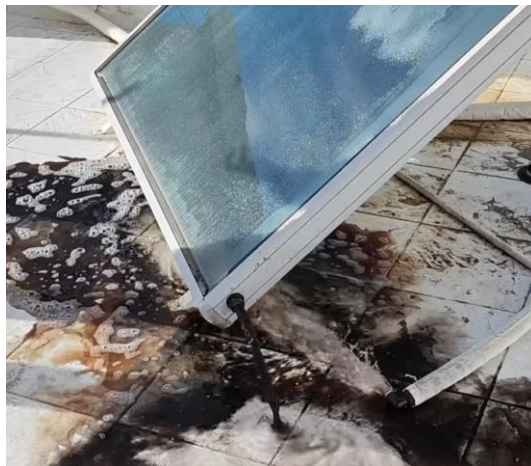
Εικόνα 2.12 Συντήρηση του δευτερεύοντος κυκλώματος ηλιακού θερμοσίφωνα, το μαύρο ίζημα στο έδαφος αποτελείται από στερεά μάζα προπιλενογλυκόλης.
