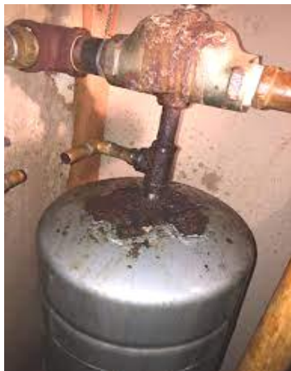
Εικόνα 2.7 Δοχείο διαστολής με εμφανή οξείδωση στην πλευρά του στομίου
