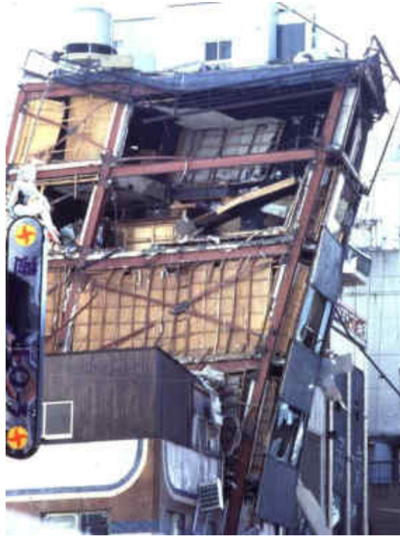
Εικόνα 2.2: Τυπικές βλάβες κατακορύφων συνδέσμων στον σεισμό του Kobe, Ιαπωνία, 1995.[15]
