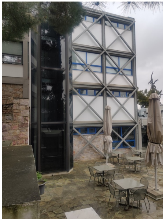
Εικόνα 4.1: παράδειγμα μεταλλικού εξωσκελετού με μεταλλικούς συνδέσμους σε υφιστάμενο κτίριο Ω/Σ
