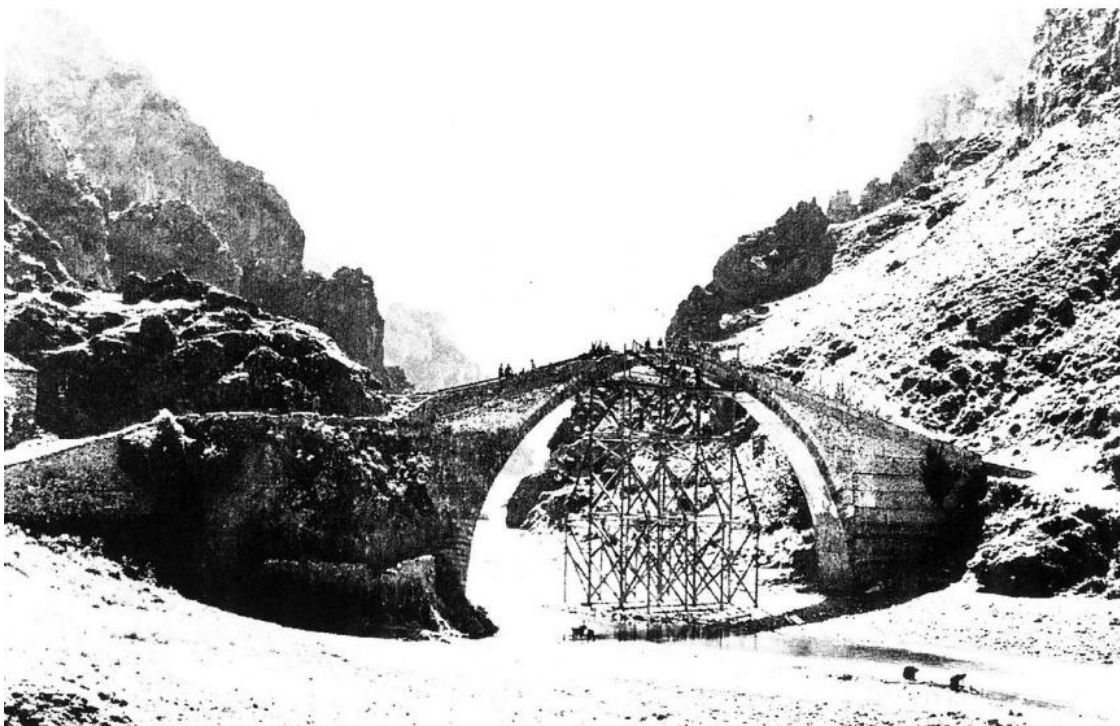
4.5: Επισκευή γέφυρας Κόνιτσας στον Αώο ποταμό το 1913 Πηγή: Πετρονώτης, Πέτρινα Γεφύρια, 2001, αρχείο Σπ. Μαντά.
