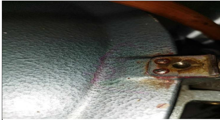
Εικόνα 14: Αποστειρωτήρας, εργαστήριο επεξεργασίας τροφίμων, Πανεπιστήμιο Δυτικής Αττικής
