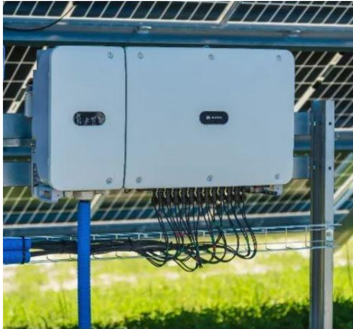
Εικόνα 2.1 Inverter Huawei σε φ/β πάρκο
