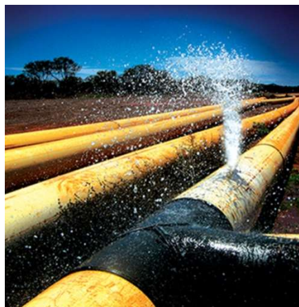
Εικόνα 4.28: Διαρροή σε Αγωγό Νερού
