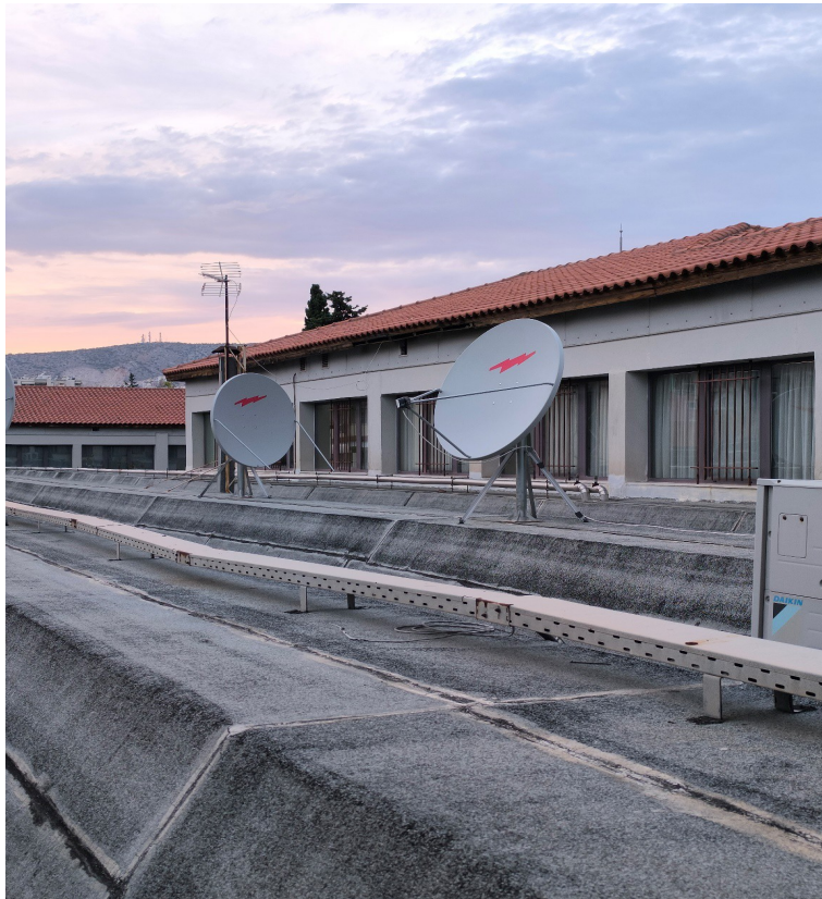
Εικόνα 33: Εγκατεστημένη δορυφορική κεραία
