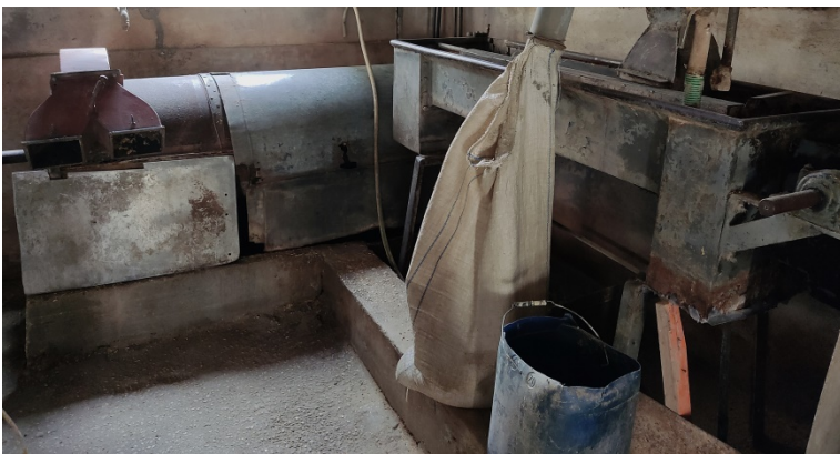
Εικόνα 18 Πλυντήριο και στεγνωτήριο
