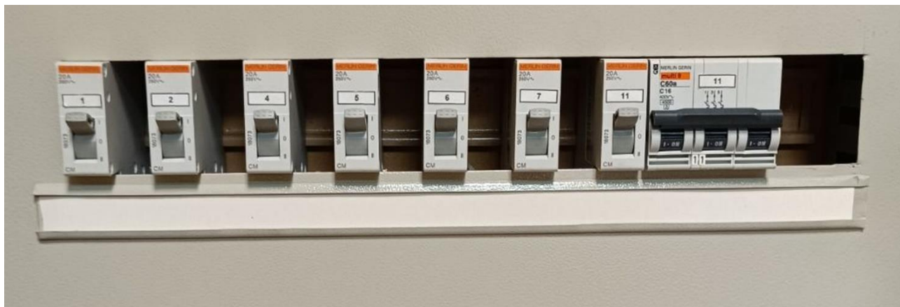
Εικόνα 40 : Επιλογικοί διακόπτες Ισογείου
