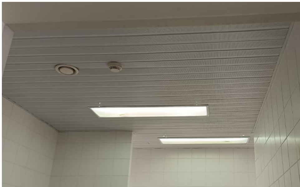
Εικόνα 34 : Φωτιστικά στεγανά ψευδοροφής T8 2x36W στα WC ορόφου
