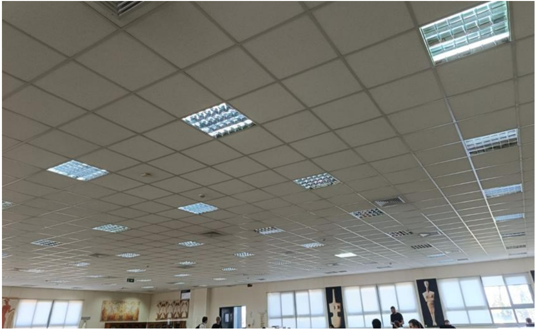
Εικόνα 33 : Φωτιστικά φθορισμού T8 4x18W ψευδοροφής Βιβλιοθήκης – Αναγνωστηρίου Ορόφου
