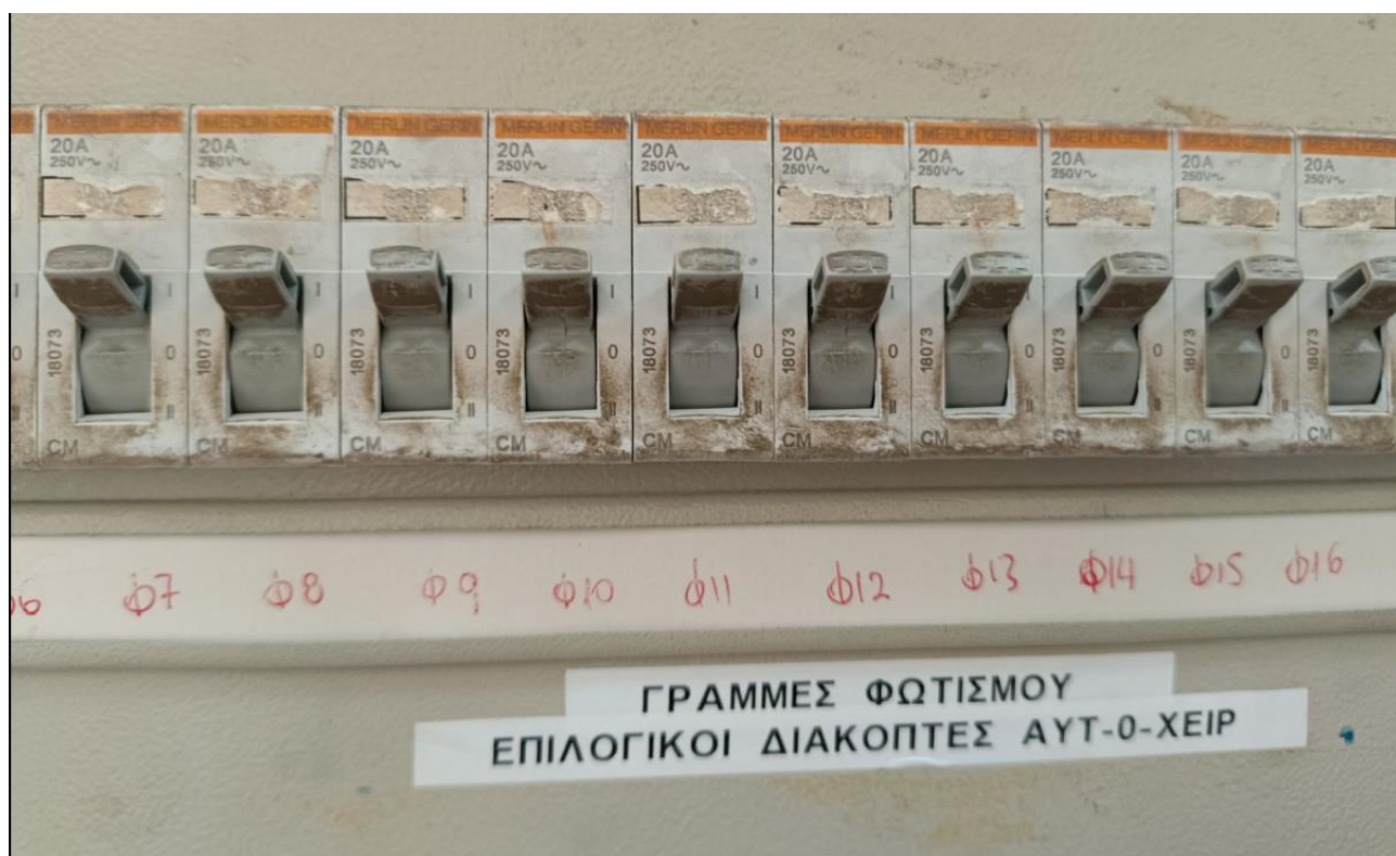
Εικόνα 41 : Επιλογικοί Διακόπτες ελέγχου φωτισμού Ορόφου
