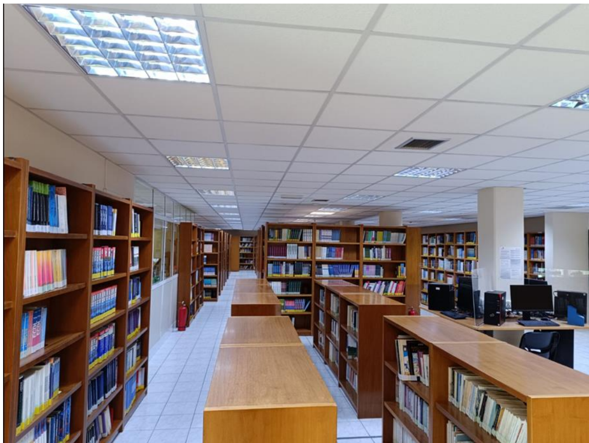
Εικόνα 32 : Φωτιστικά φθορισμού T8 4x18W ψευδοροφής Βιβλιοθήκης – Ισόγειο
