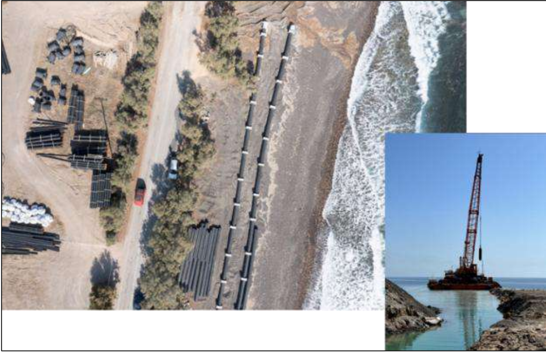
Εικόνα 14- Εγκαταστάσεις Αφαλάτωσης Αγίας Παρασκευής Σαντορίνης
