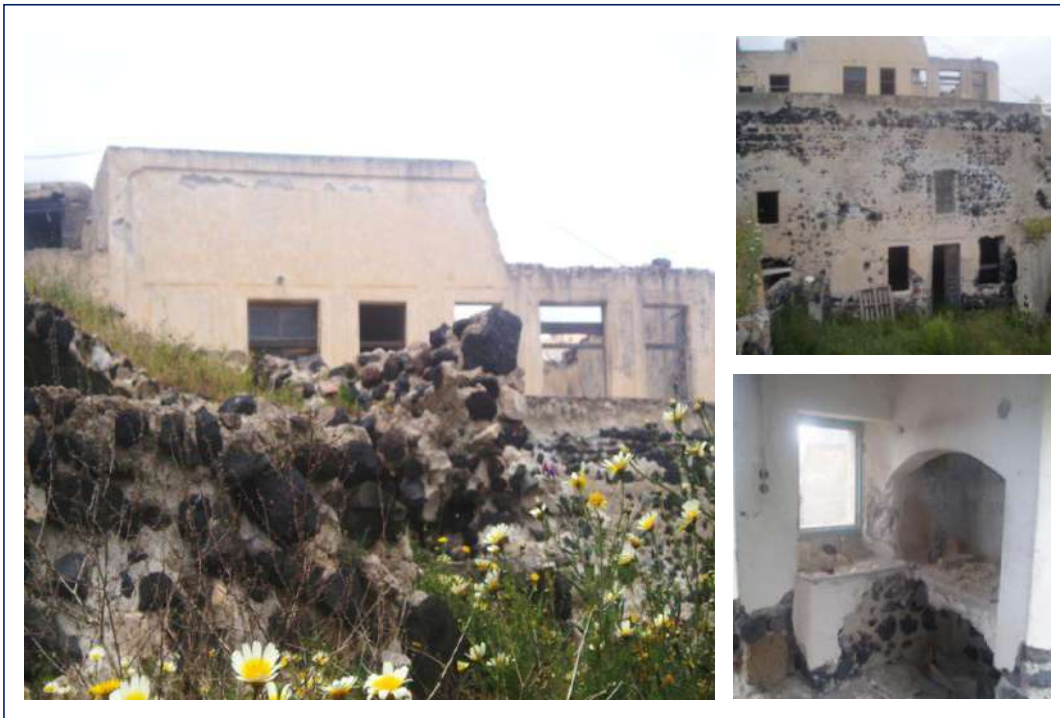
Εικόνα 23- Επισκοπή Γωνιά μετά το σεισμό του 1956
