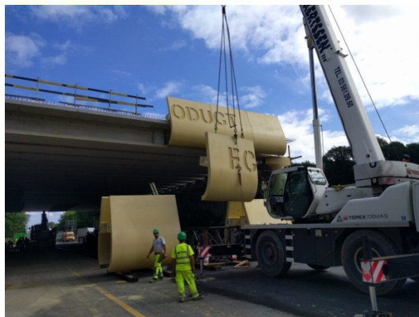
Εικόνα 5.9: Ecoduct Groenendaal γέφυρα Βρυξέλλες Βέλγιο, εγκατάσταση διακοσμητικών στοιχείων άκρων, πηγή: Ίδρυμα Sonian Forest, ιδιωτικό ίδρυμα
