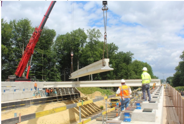
Εικόνα 5.10: Κατασκευή της Ecoduct Groenendaal γέφυρα Βρυξέλλες Βέλγιο, πηγή: Ίδρυμα Sonian Forest, ιδιωτικό ίδρυμα
