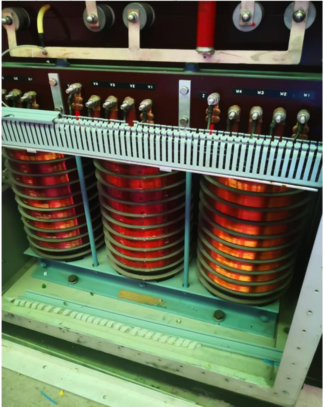
Εικόνα 8. Μ/Σ δισκοειδών τυλιγμάτων δευτερεύοντος
