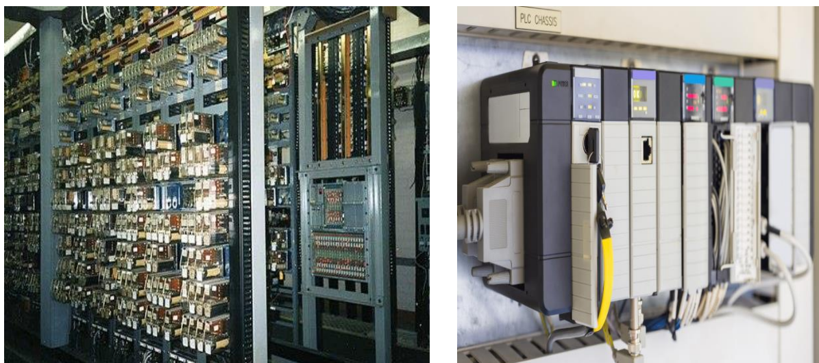
Εικόνα 4.1 Στην εικόνα αριστερά απεικονίζεται ένας πίνακας ρελέ (Library Automation Direct, n.d.) και στην εικόνα δεξιά ένα PLC (Nevatio Engineering, 2021).
