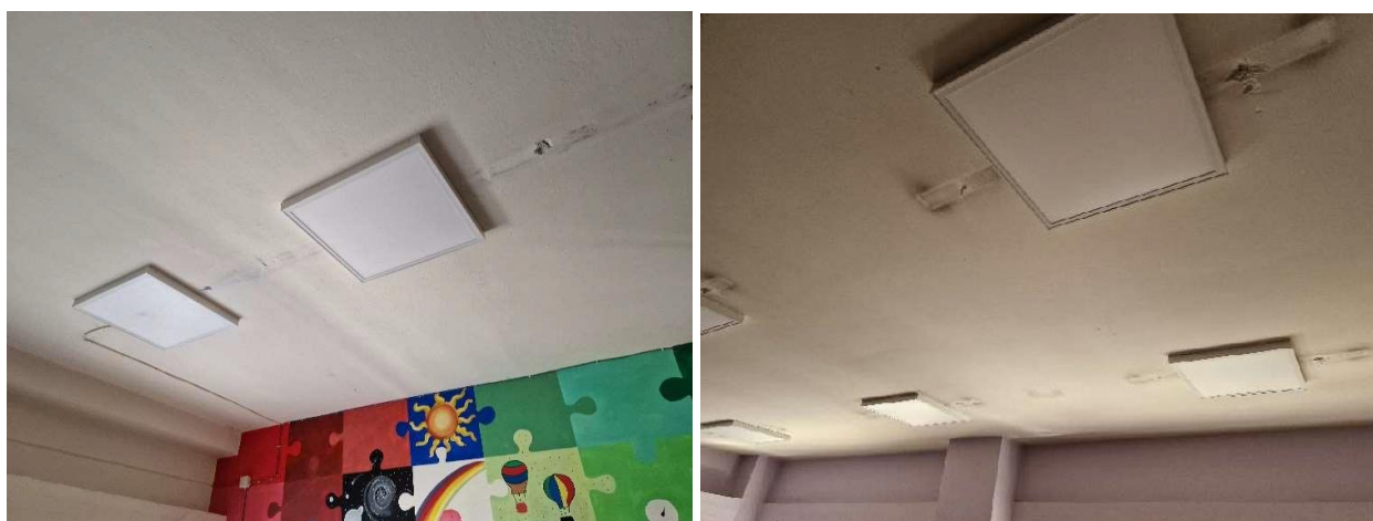
Άποψη εσωτερικού φωτισμού
