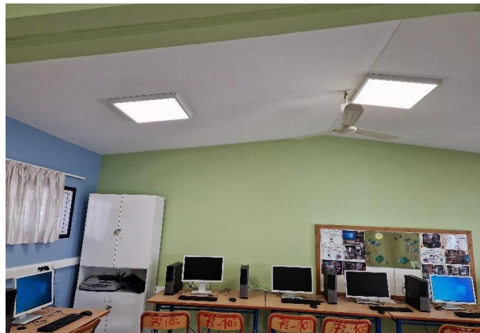
Αποψη εσωτερικού φωτισμού
