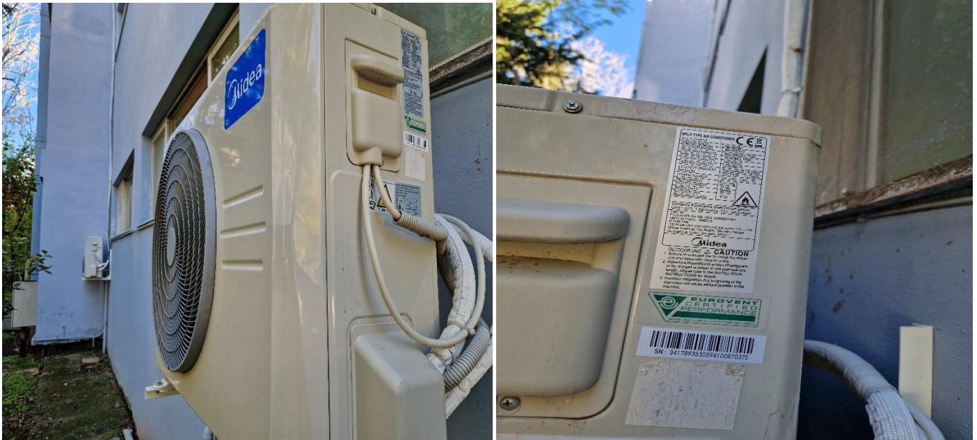
Τοπικές μονάδες κλιματισμού
